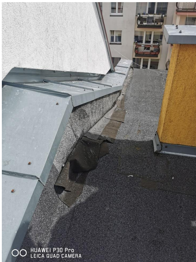
Uszkodzenia obróbki ogniomuru
