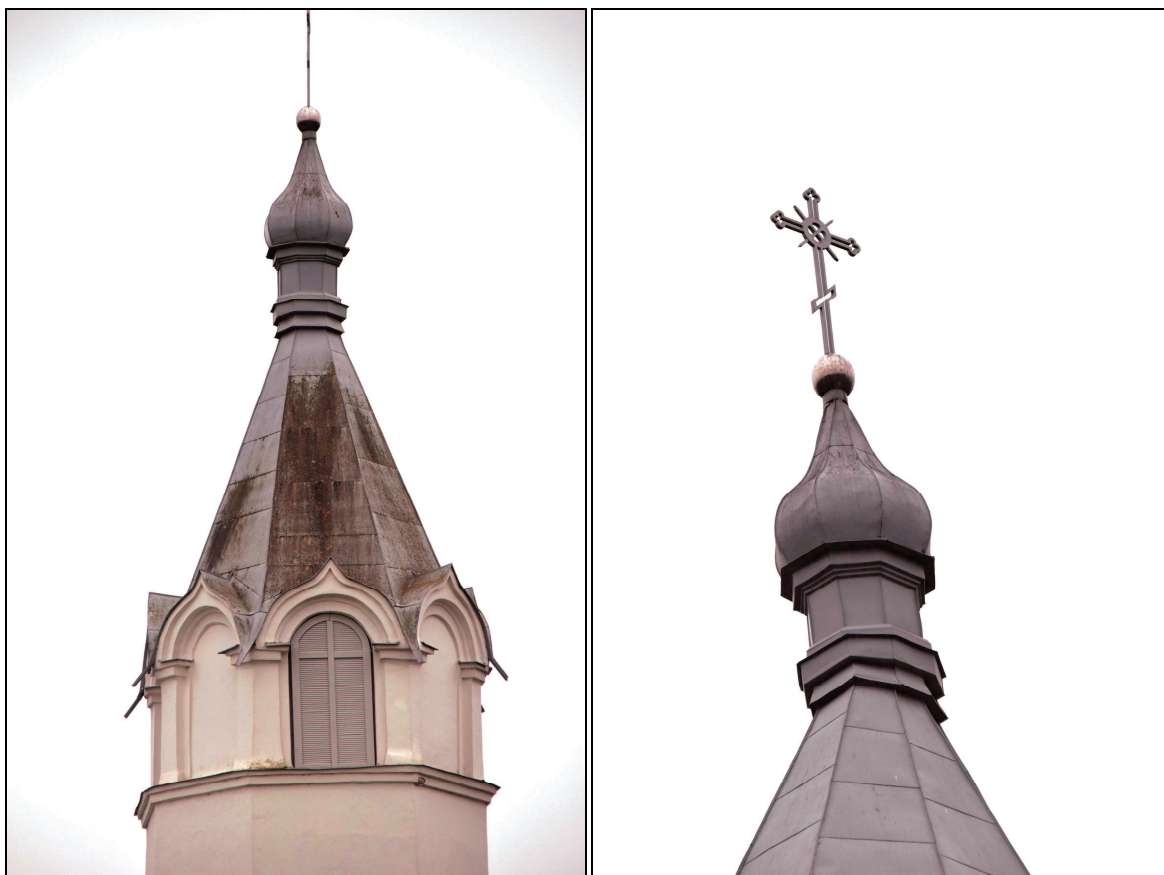
Kopuła na wieży lekko skrzywiona
