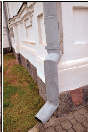
Bardzo zniszczone rury spustowe
