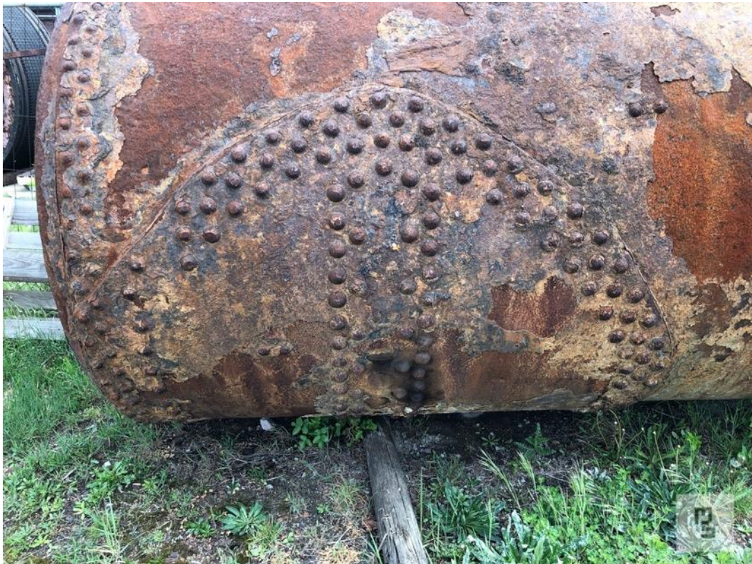
Fot. 5 Stan zachowania
