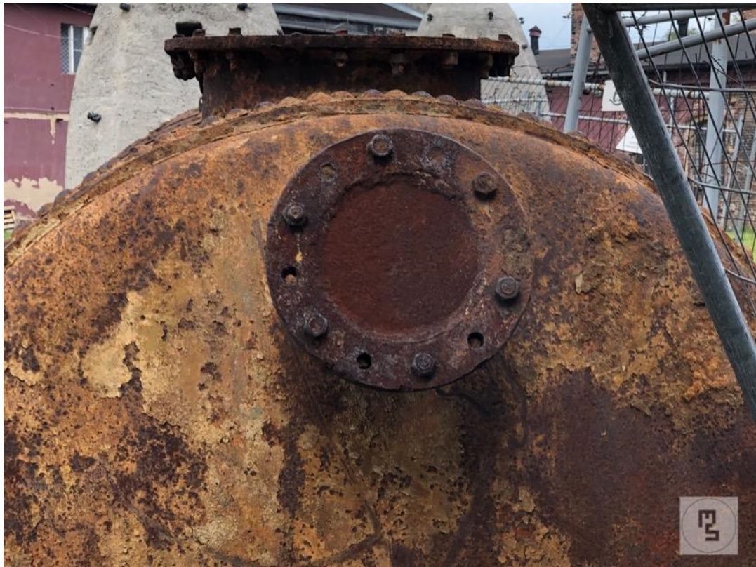
Fot. 4 Stan zachowania
