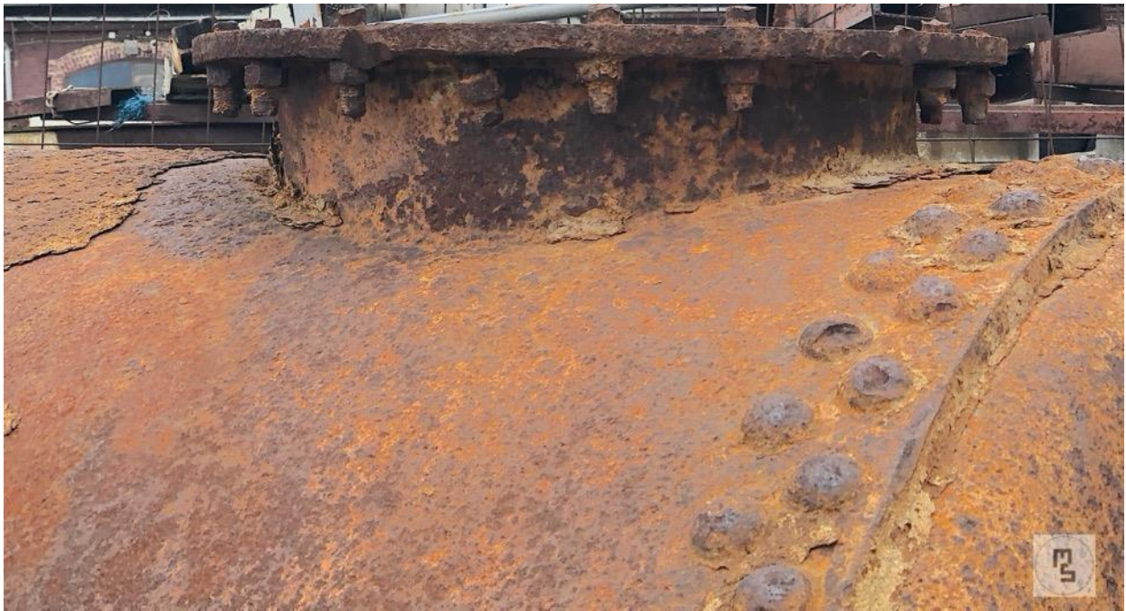
Fot. 10 Stan zachowania
