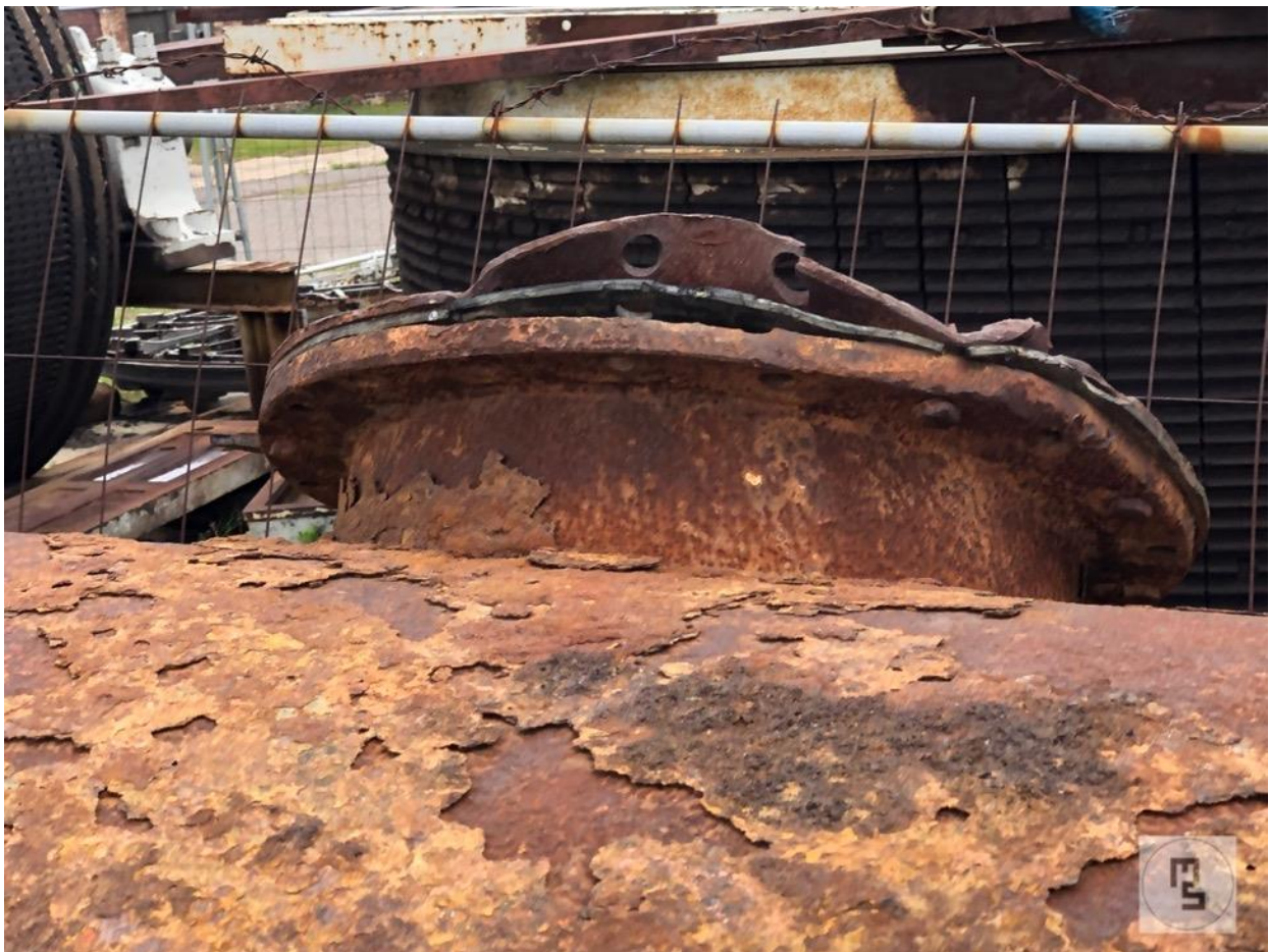
Fot. 9 Stan zachowania
