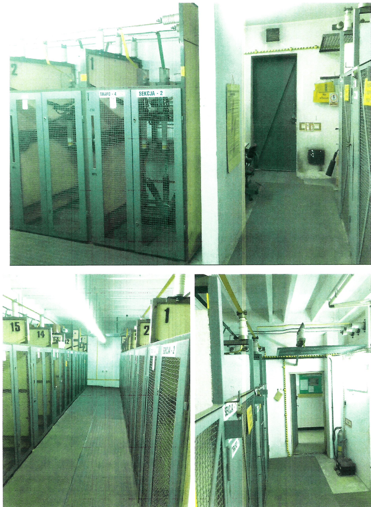
Rys. 7. Widok pomieszczenia rozdzielnic RSN (SN-4)
