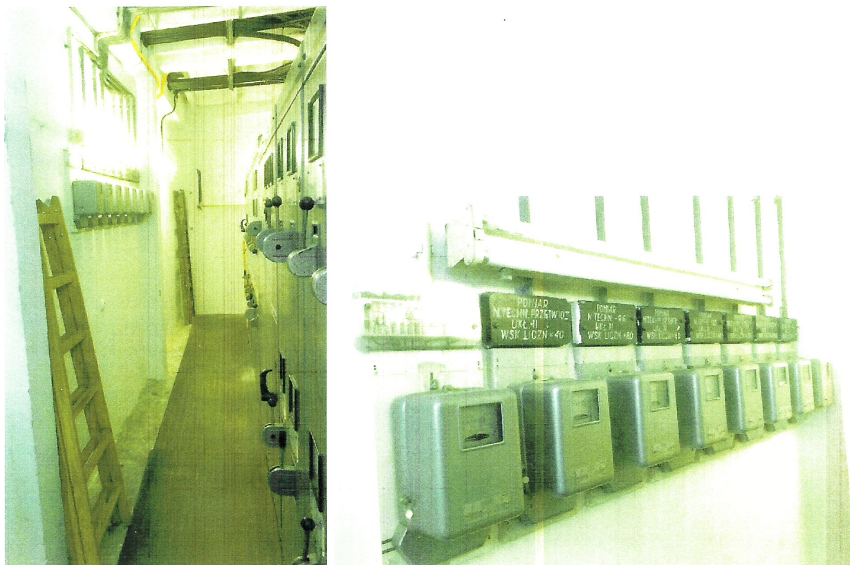
Rys. 14. Widok liczników na ścianie pomieszczenia nr 38.
