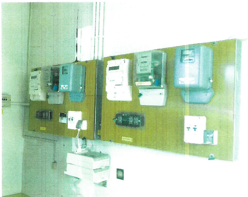
Rys. 9. Widok liczników rozliczeniowych.
