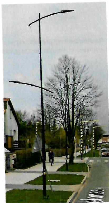
Poglądowe zdjęcie słupa oświetleniowego zamontowanego na terenie Pruszcza Gdańskiego, w ul. batalionów Chłopskich.
