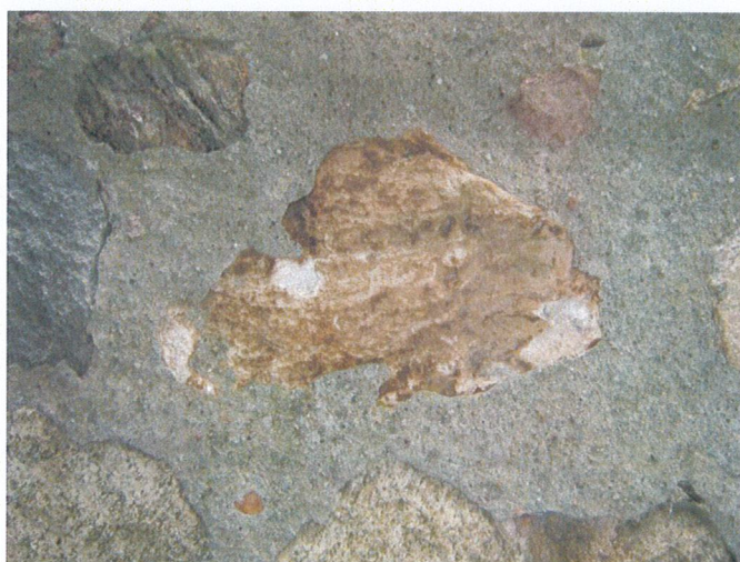
Fot. Kamień w murze kościoła z którego pobrano próbkę do analizy ilościowej i jakościowej soli, na prawo od wejścia głównego w elewacji wieżowej zachodniej. Badanie wykonano w Laboratorium PKZ w Toruniu. Analiza wykazała 0,67 % zawartości soli w kamieniu.
