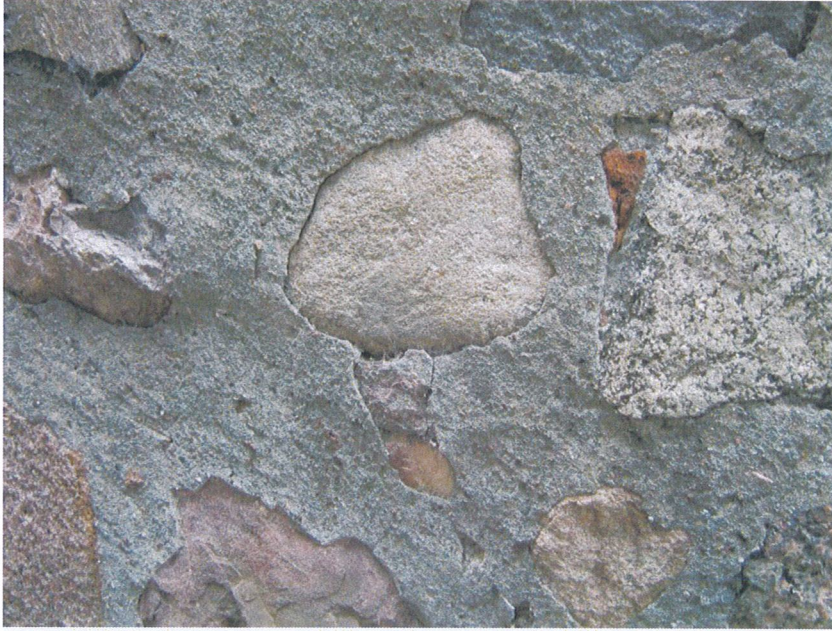
Fot. Powyżej fragment elewacji kościoła w Trzciesku- Zdroju pozacieranej wtórną szarą cementową zaprawą.
