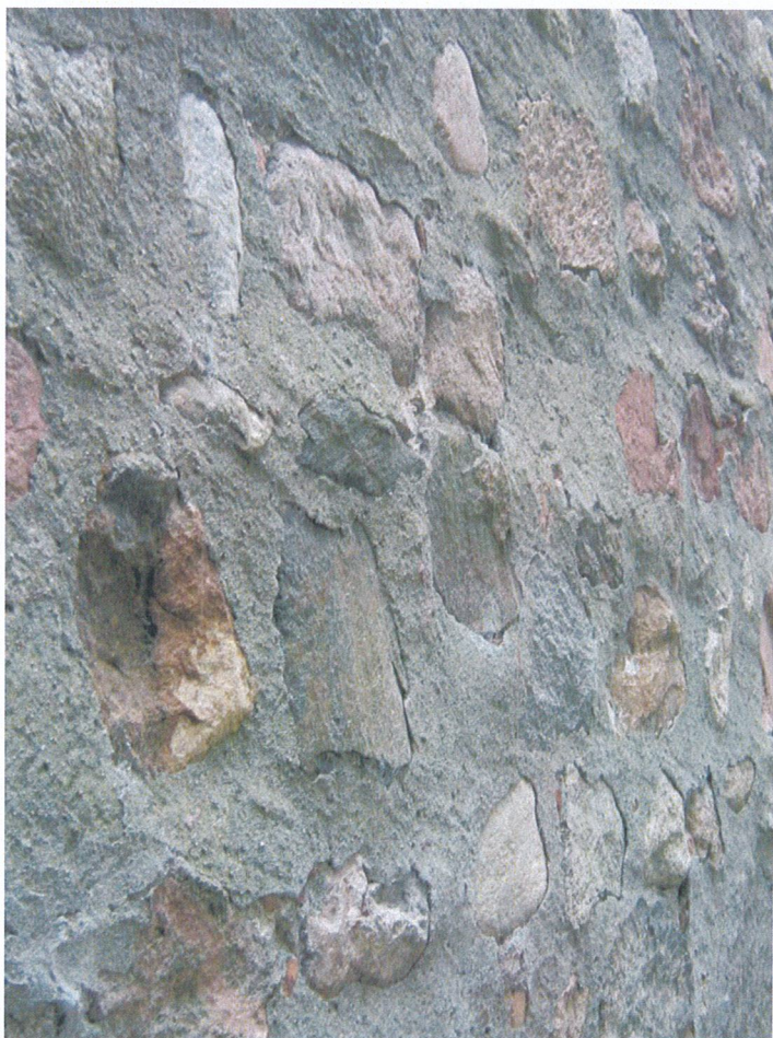
Fot. Główny problem ścian kamiennych kościoła w Trzciesku- Zdroju to wtórna cementowa obrzutka pozacierana na zabytkowe kamienie polne. W czasie konserwacji należy ją usunąć.
