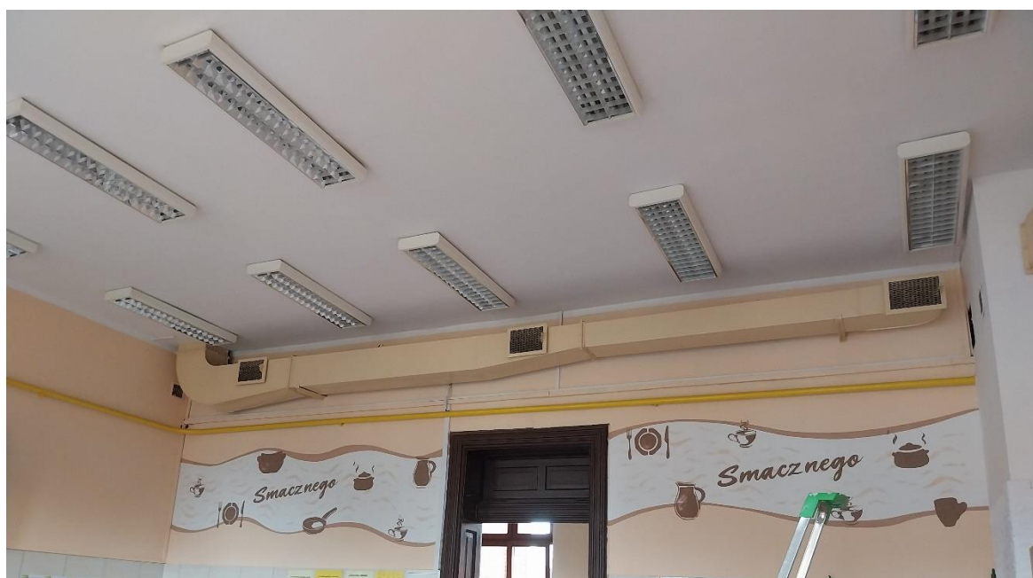
s. 107 – Pracownia technologiczna
