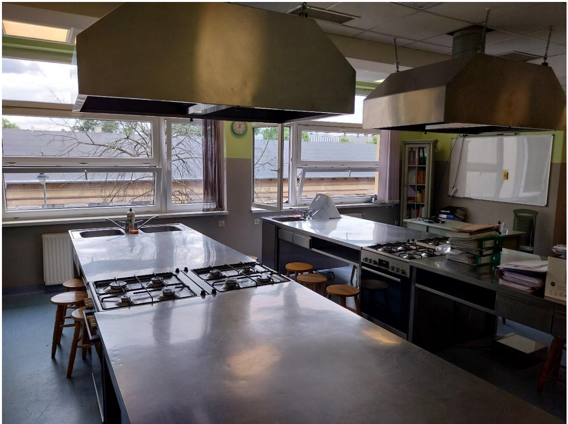
s. 110 – Pracownia technologiczna
