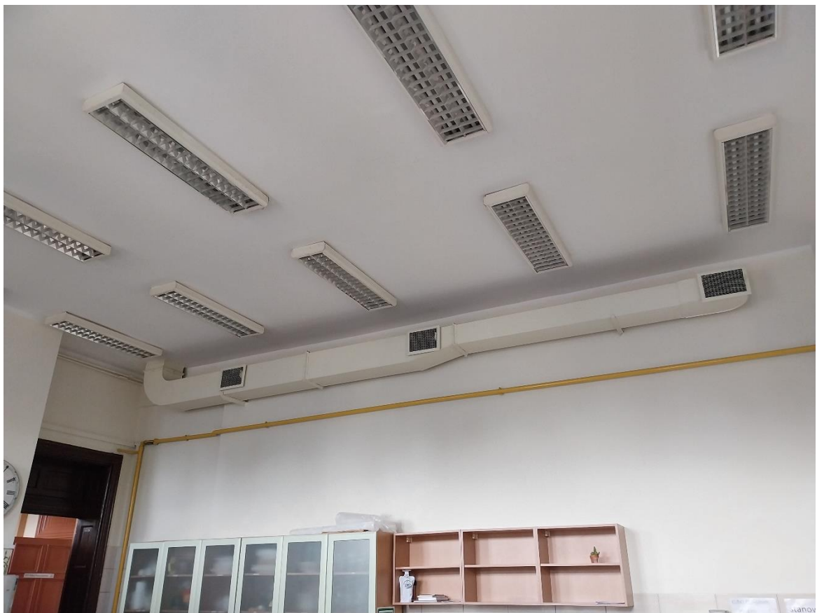
s. 111 – Pracownia technologiczna
