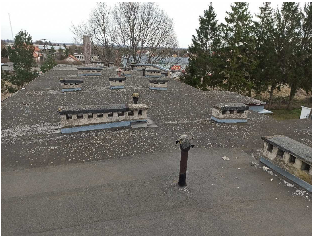
Fotografia nr 11 Widok stanu pokrycia dachu – lewa strona patrząc od wejścia frontowego do budynku
