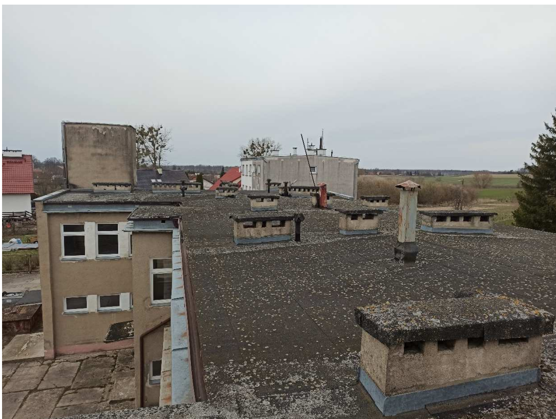
Fotografia nr 10 Widok stanu pokrycia dachu – w tle z lewej pom. obudowy naczynia wzbiorczego – do rozbiórki
