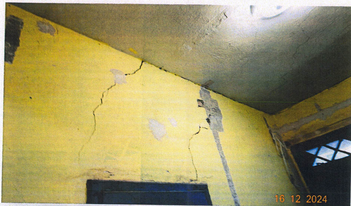
Zdjęcie nr 14 – widok spękań na ścianie korytarza, po prawej stronie od wejścia
