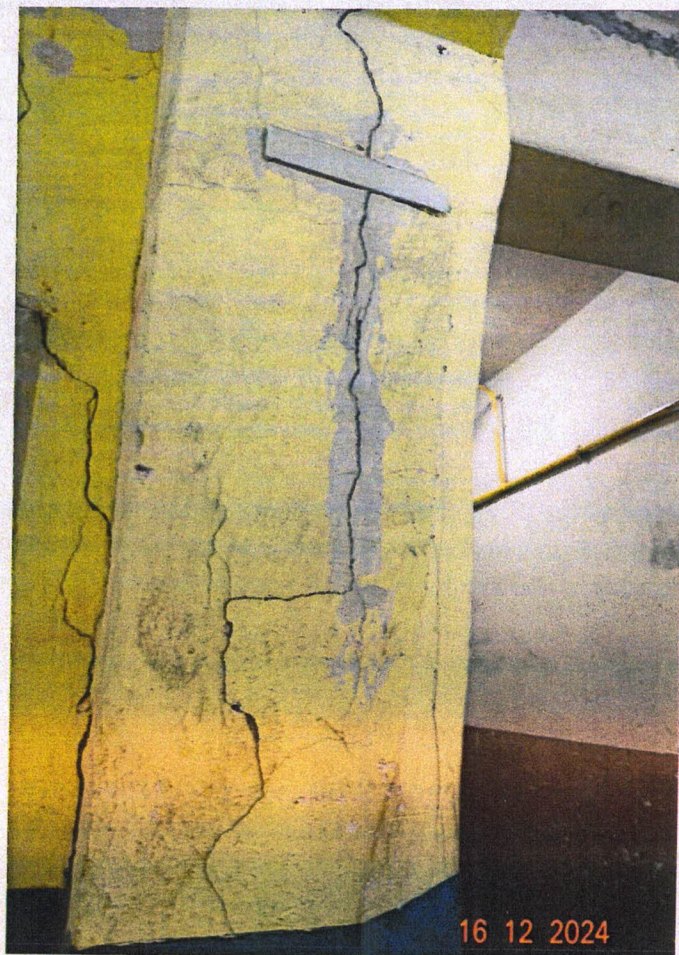
Zdjęcie nr 13 – widok spękań na ścianie korytarza, po lewej stronie od wejścia
