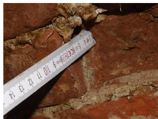
Degradacja , miara wchodzi 3cm w cegłę.
