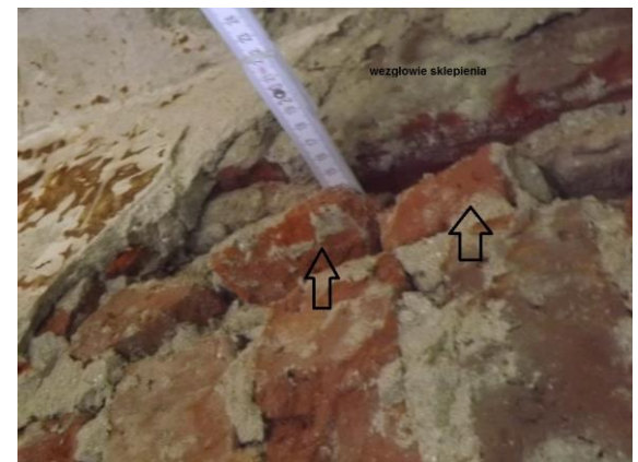
Szpałdowanie kawałkami cegieł bez zaprawy wyżej wezłowie sklepienia.
