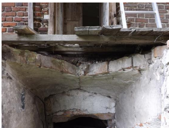
Wejście - pęknięte i ubytek sklepienia.
