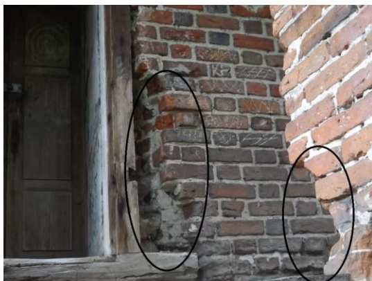
Ubytki przy drzwiach wejściowych, Z prawej filar ściany arkadowej
