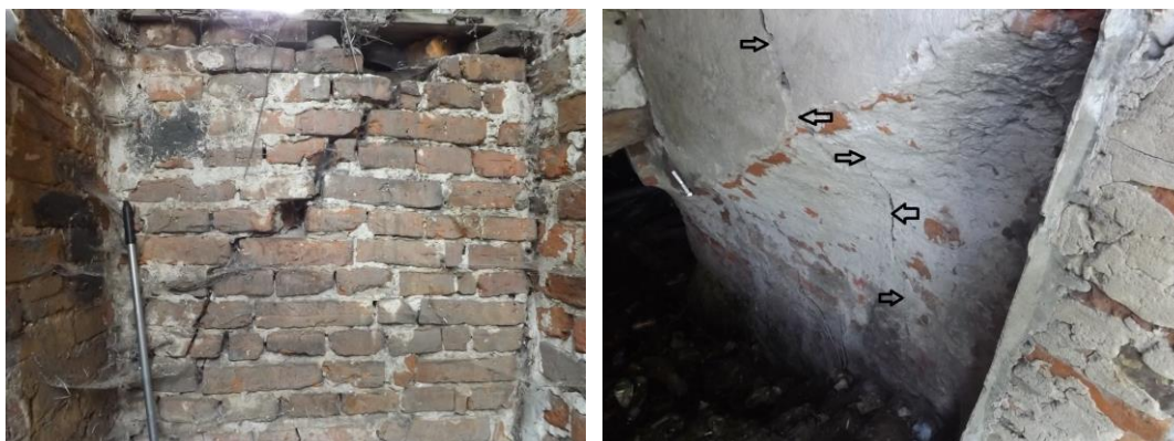
Wejście do piwnicy-pęknięcie ściany str. zewnętrzna Strona wewnętrzna z pocienieniem.
