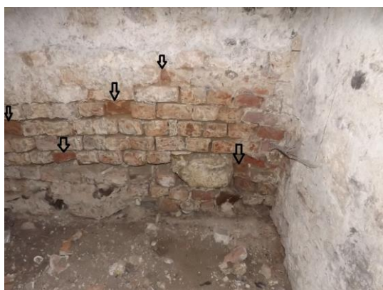
Destrukcja tynku, zaprawy i cegieł.
