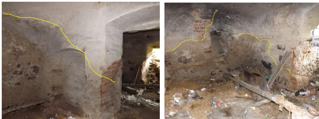
Ściana północn-wschodnia z zaznaczonym obszarem intensywnego zawilgocenia.
