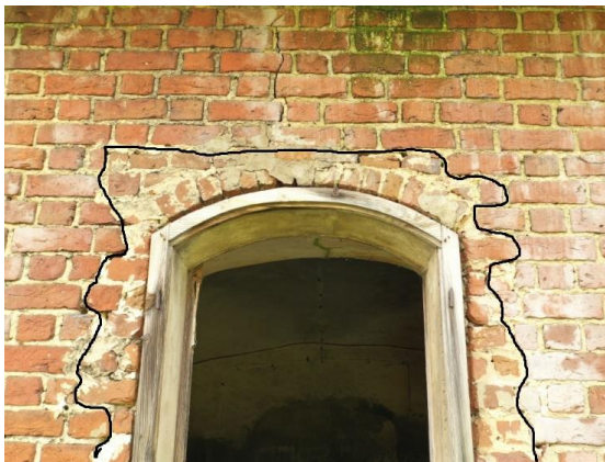
Widok zew.sklepienia z zaznaczonym obszarem naprawy.
