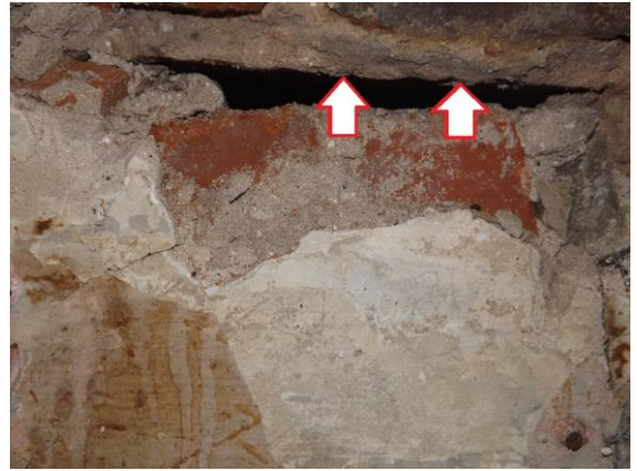
Płaszczyzna starej związanej zaprawy bez powiązania z cegłami sklepienia okiennego.
