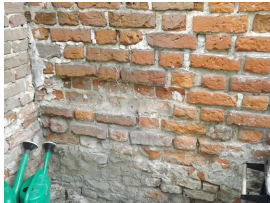
Degradacja powierzchniowa cegieł elew. wschodnia
