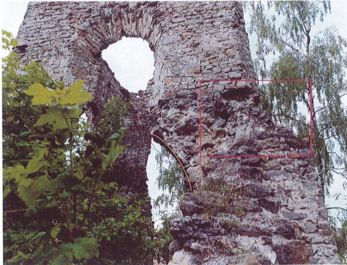
Fot. 16 Elewacja wschodnia wieży (widok od zewnątrz). Uszkodzenia przewężenia muru (kolor czerwony). Widoczne ślady nadproża parteru wieży (kolor pomarańczowy)
