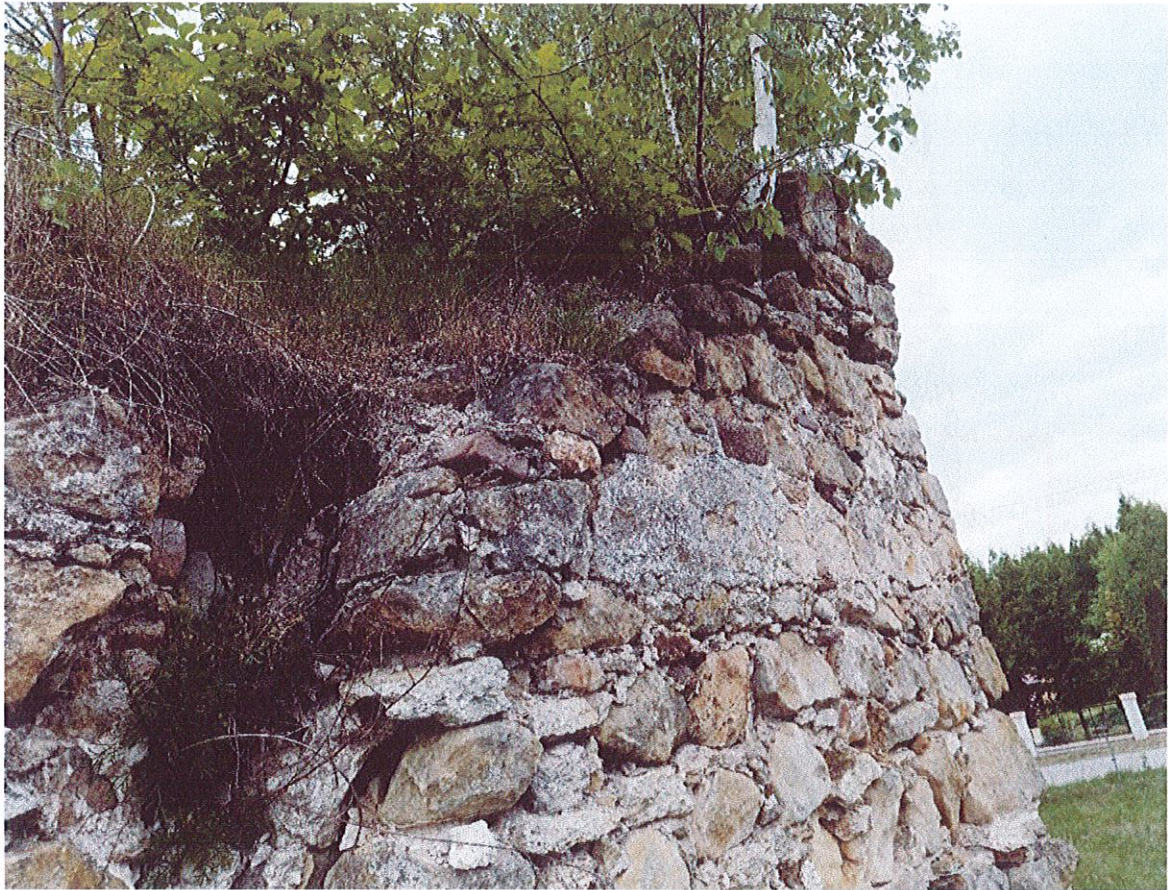
Fot. 20 Elewacja wschodnia (widok od zewnątrz). Uszkodzenia korony murów oraz liczne ubytki w spoinowaniu
