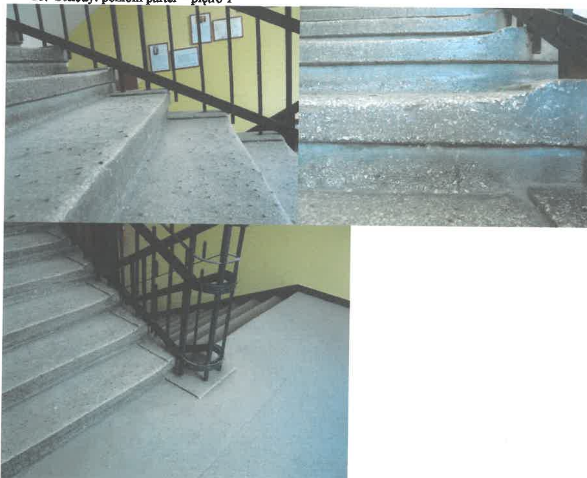
17. Schody: poziom półpiętro 1 – piętro 1 – widoczne spękania, ubytki i wystające kamyki
