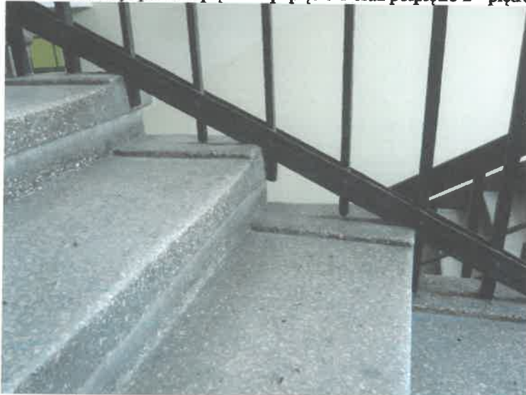
19. Schody: poziom piętro 1- piętro 2 – widoczne zatopienie elementów balustrady w lastriko
