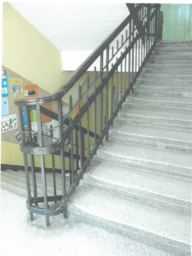
5. Schody: poziom parter – piętro 1 – widoczny brak detalu na spoczniku i 1.stopniu (podniesienie boczne)
