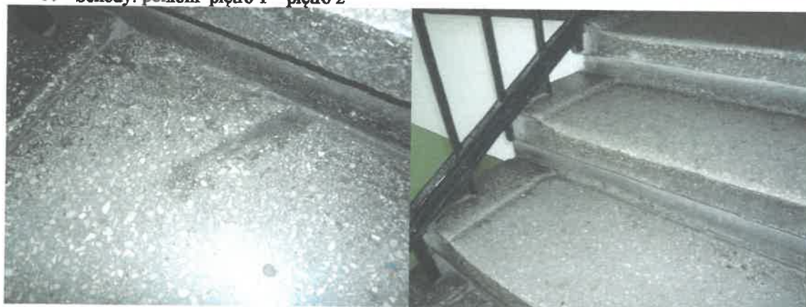
10. Schody: poziom piętro 1 – piętro 2 – widoczne uszkodzenia i wystające kamyki
