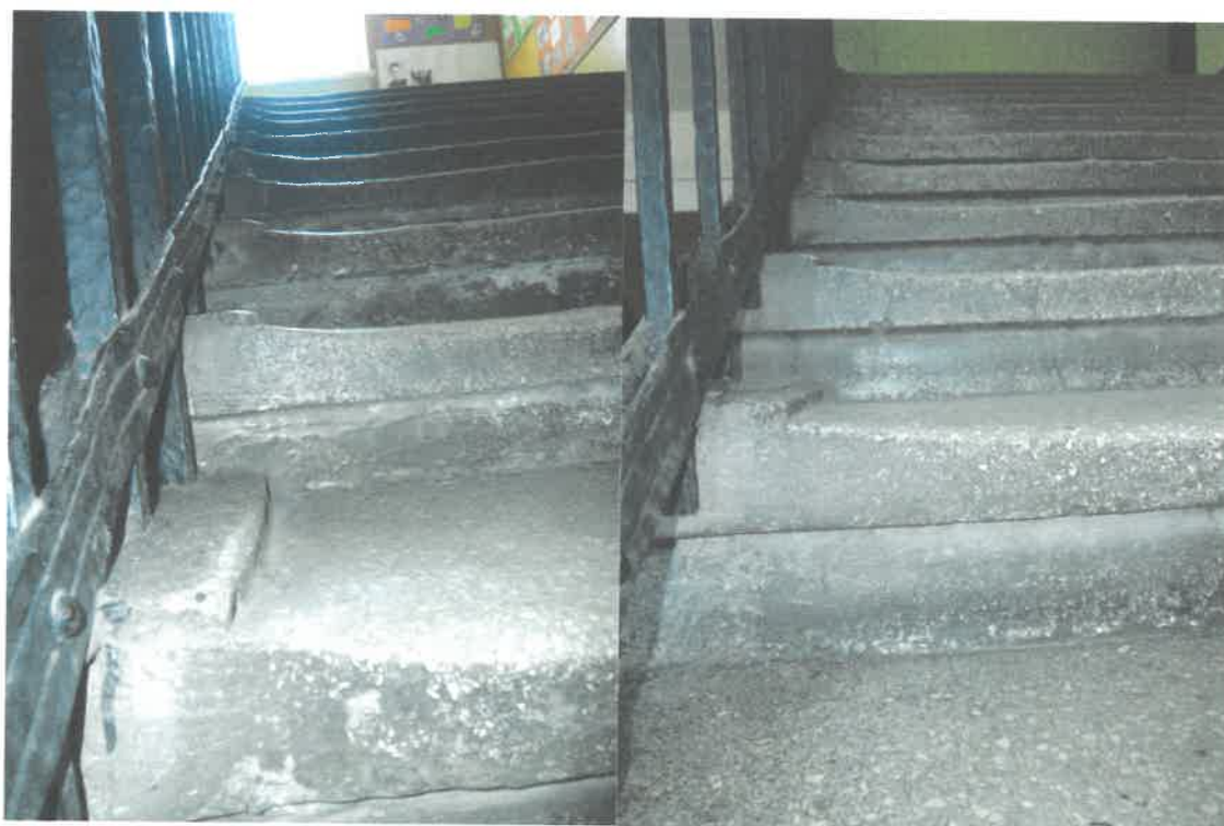
6. Schody: poziom parter – piętro 1 – widoczne ugięcia i uszkodzenia
