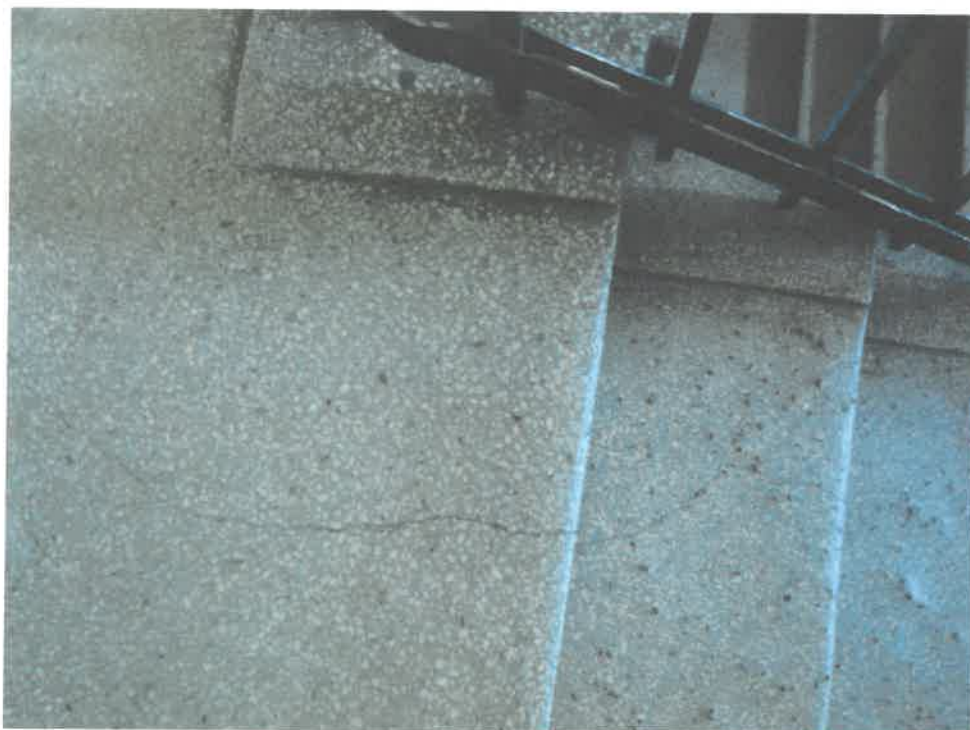
15. Schody: poziom parter – widoczne spękania i wystające kamyki oraz wytarte krawędzie detali architektonicznych (boczne podniesienia)
