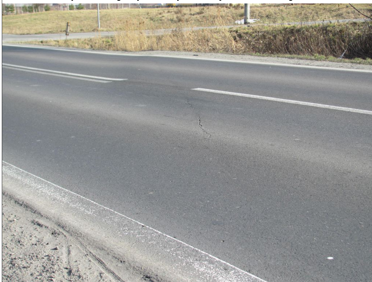
Fot. 9. Pęknięcie i obniżenie drogi wojewódzkiej nr 985 Dębica - Tarnobrzeg
