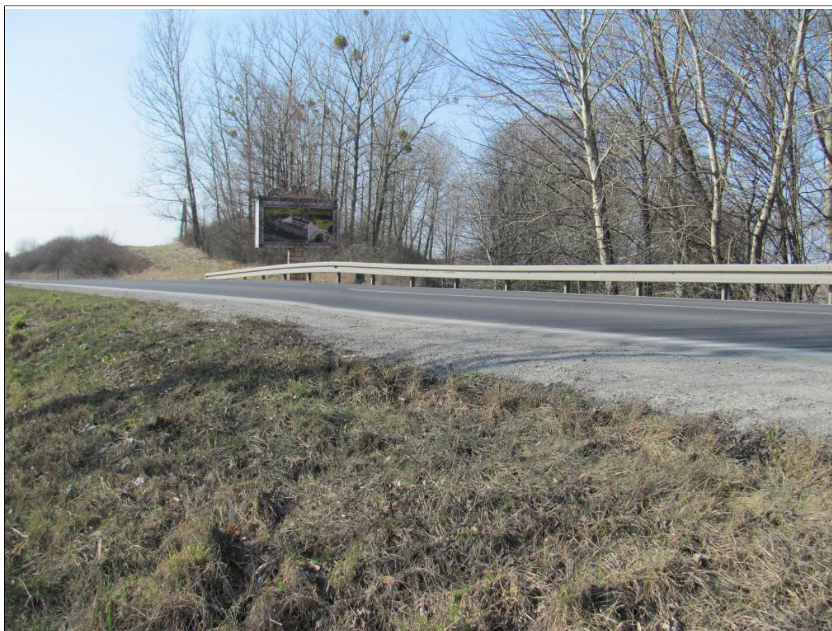
Fot. 8. Obniżona jezdnia drogi wojewódzkiej nr 985 Dębica - Tarnobrzeg
