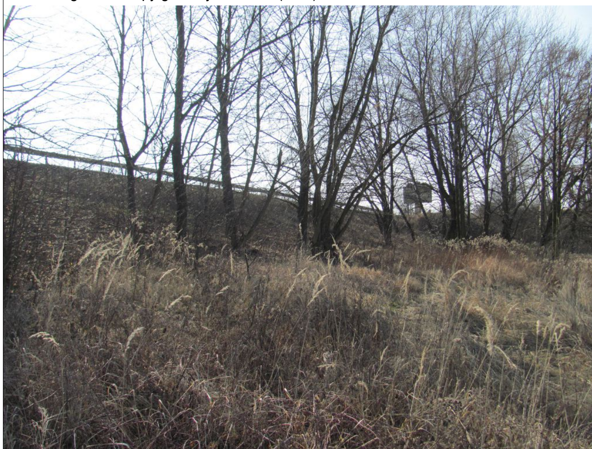
Fot. 3. Uszkodzony przez osuwisko nasyp drogowy drogi wojewódzkiej 985 Dębica - Tarnobrzeg.
