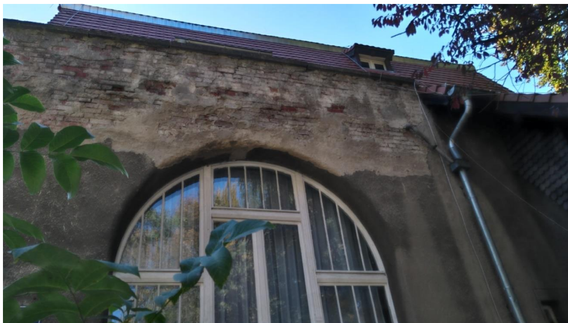
Fot.nr 10. Widok elewacji tylnej , okno łukowe stan dobry do renowacji . Tynk elewacji zniszczony i zabrudzony do skucia i odtworzenia
