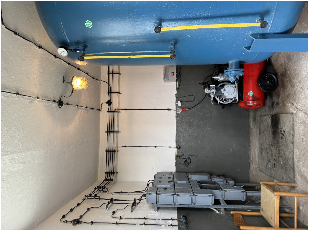
ISTNIEJĄCA SZAFKA ELEKTRYCZNA, SPRĘŻARKA
