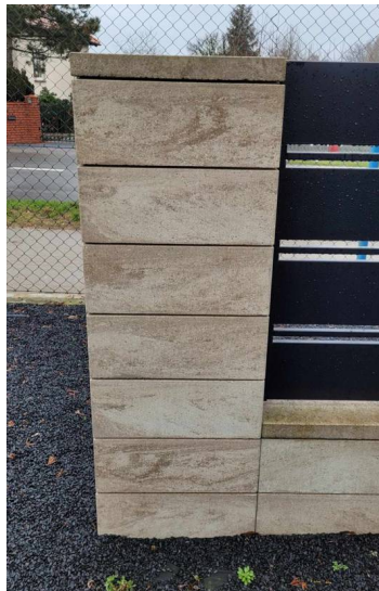
Fot. 5. Słupek murowany ogrodzenia zgodny z wytycznymi Inwestora.
