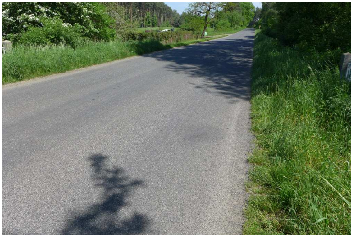
Fot. 5 – Nawierzchnia jezdni - zanieczyszczenia i wegetacja roślin przy krawężniach.
