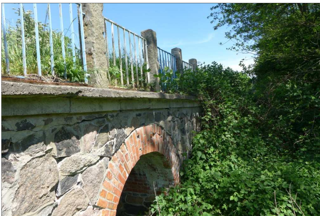
Fot. 8 – Ściana czołowa od strony dolnej wody - widoczne ubytki spoin między kamieniami, ubytki betonu gzymsu i słupków balustrady.
