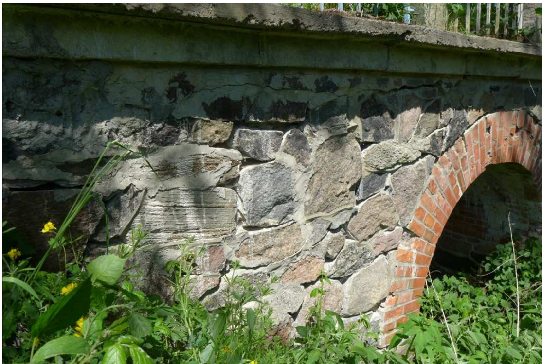
Fot. 9 – Ściana czołowa od strony dolnej wody - widoczne ubytki spoin między kamieniami. Wykruszenia cegieł sklepienia.
