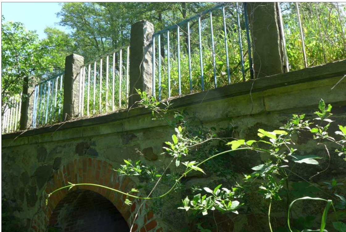
Fot. 11 – Ściana czołowa od strony górnej wody - widoczne ubytki spoin, osady.
