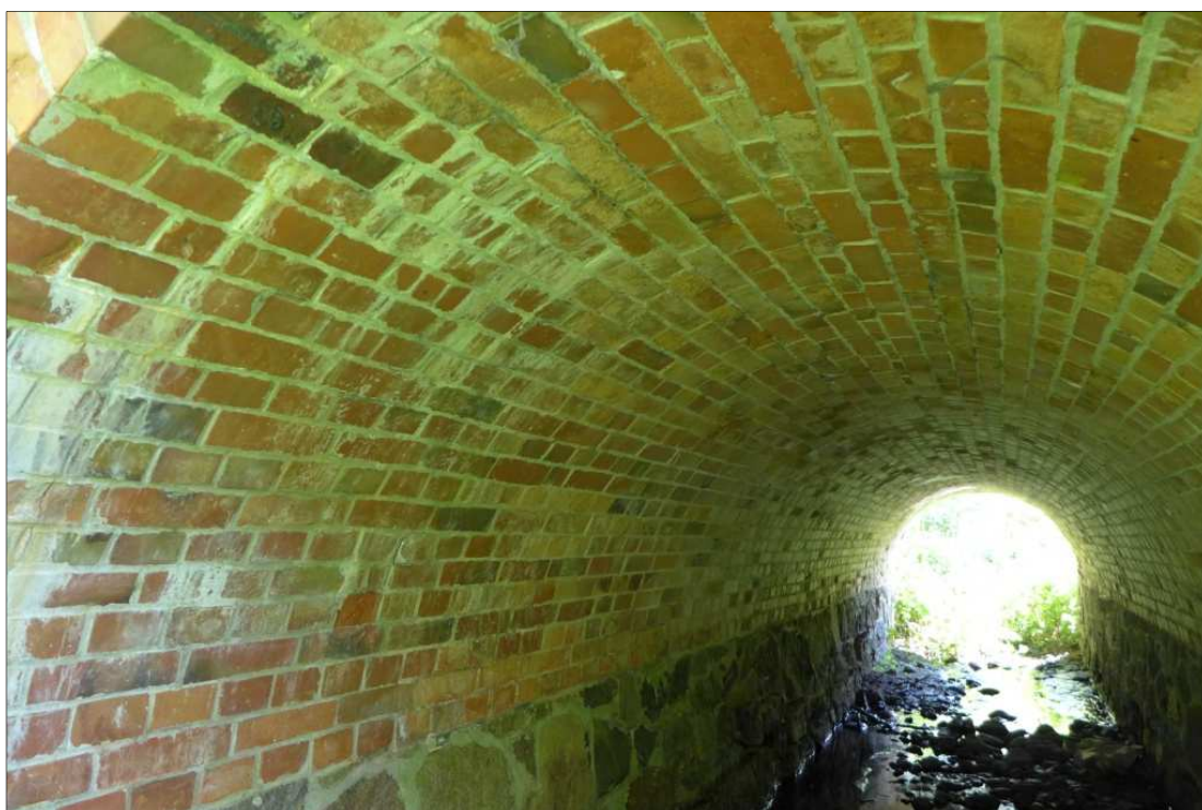
Fot. 16 – Sklepienie - widoczne osady i wykwity.
