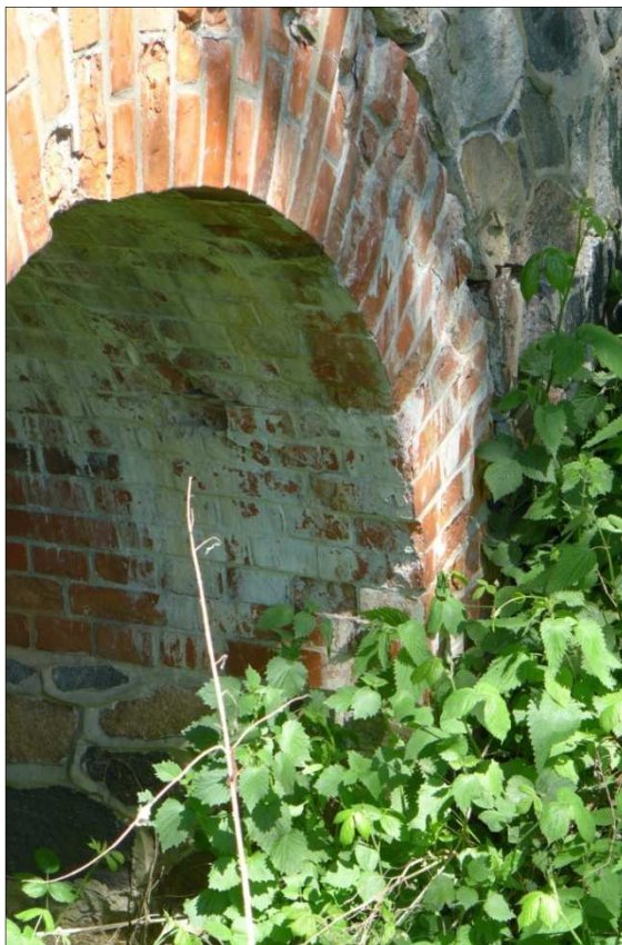
Fot. 17 – Sklepienie - widok od dolnej wody - widoczne rozległe osady i wykwity na skutek przecieków wody.
