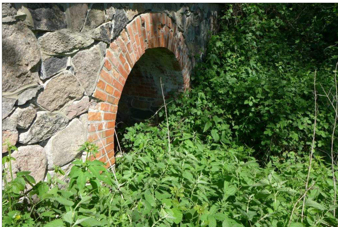
Fot. 10 – Ściana czołowa od strony dolnej wody - widoczne ubytki spoin między kamieniami. Wykruszenia cegieł sklepienia.
