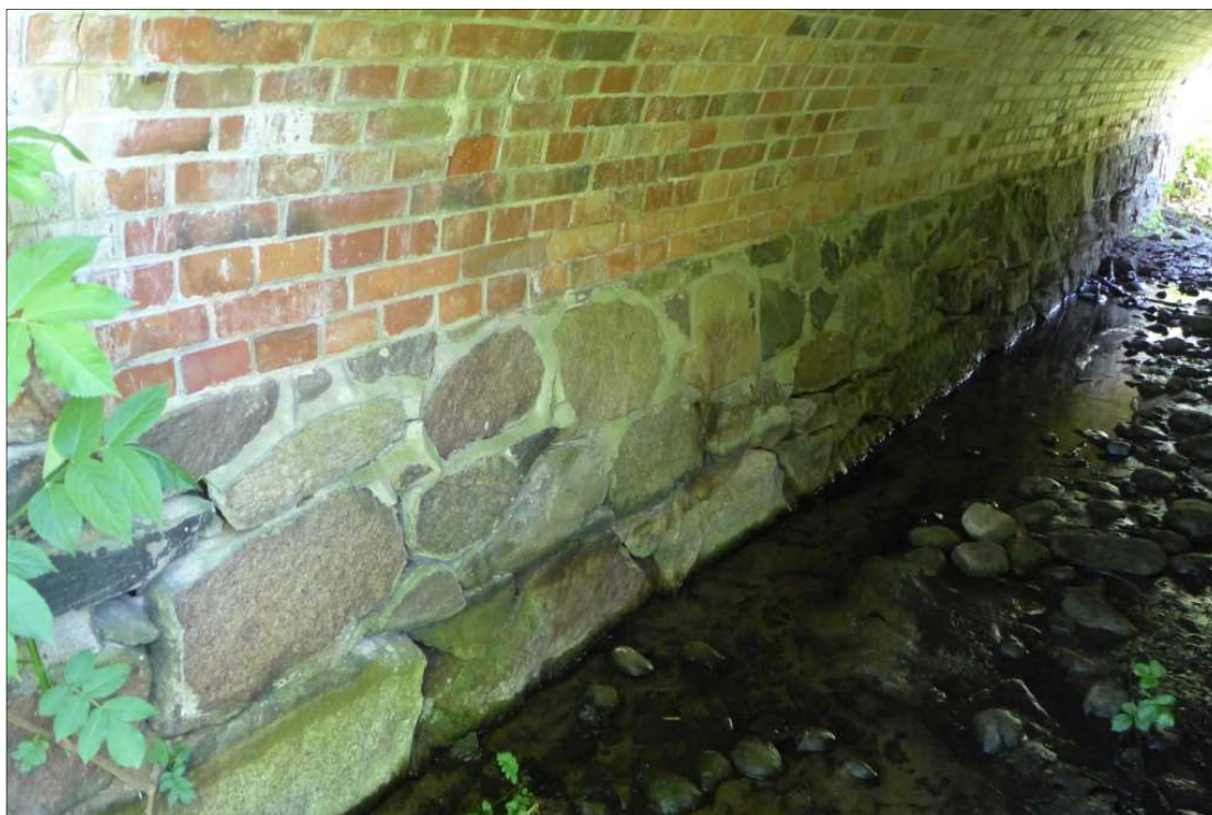
Fot. 14 – Sklepienie - widoczne osady i wykwyty, ubytki spoin.
