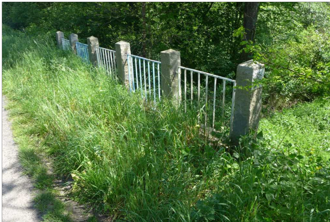
Fot. 7 – Pobocze od strony górnej wody - widoczna bujna wegetacja roślin.
