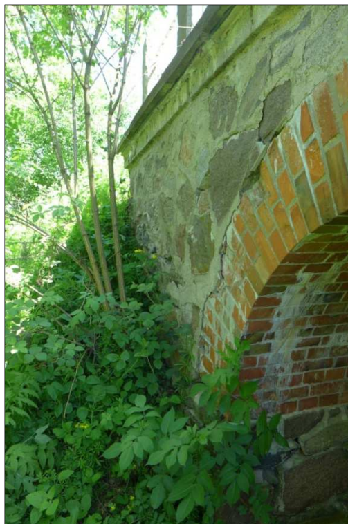
Fot. 13 – Ściana czołowa od strony górnej wody - widoczne ubytki spoin, osady.
