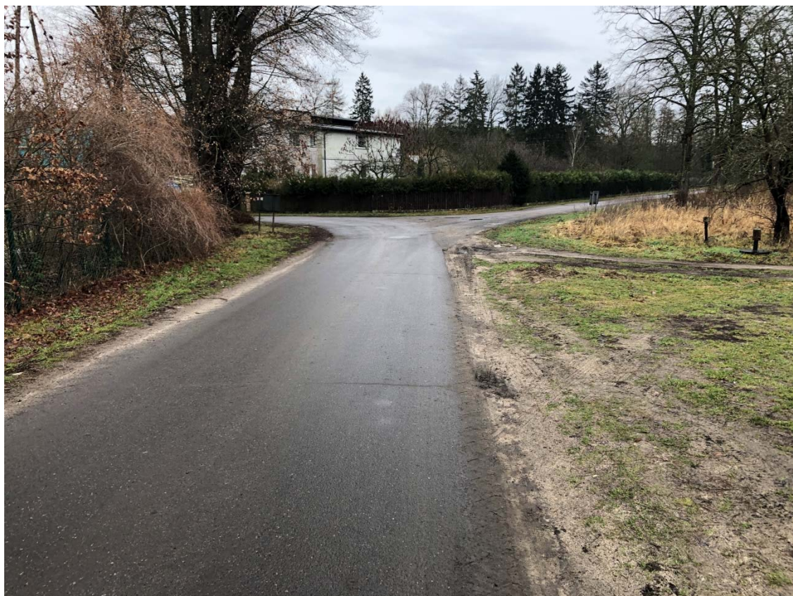
Zdjęcie 1. Widok początku drogi gminnej (zdjęcie z rejonu włączenia do drogi powiatowej)
