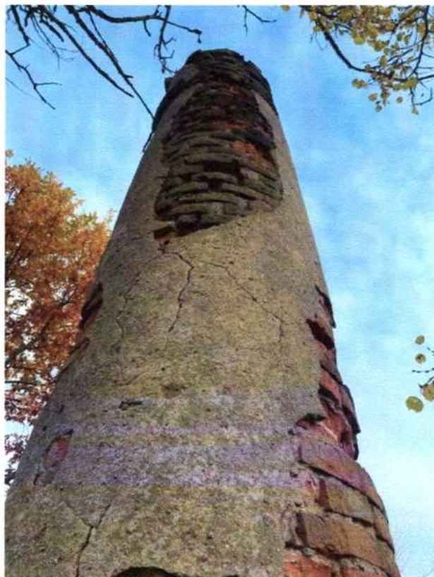
Fot. 12. Spękanie zachowanych tynków, liczne mikroorganizmy na licu cegieł oraz tynku.
