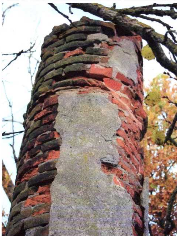
Fot. 5. Od strony zachodniej dobrze zachowane lico cegły, pokryte silnymi nawarstwieniami.
