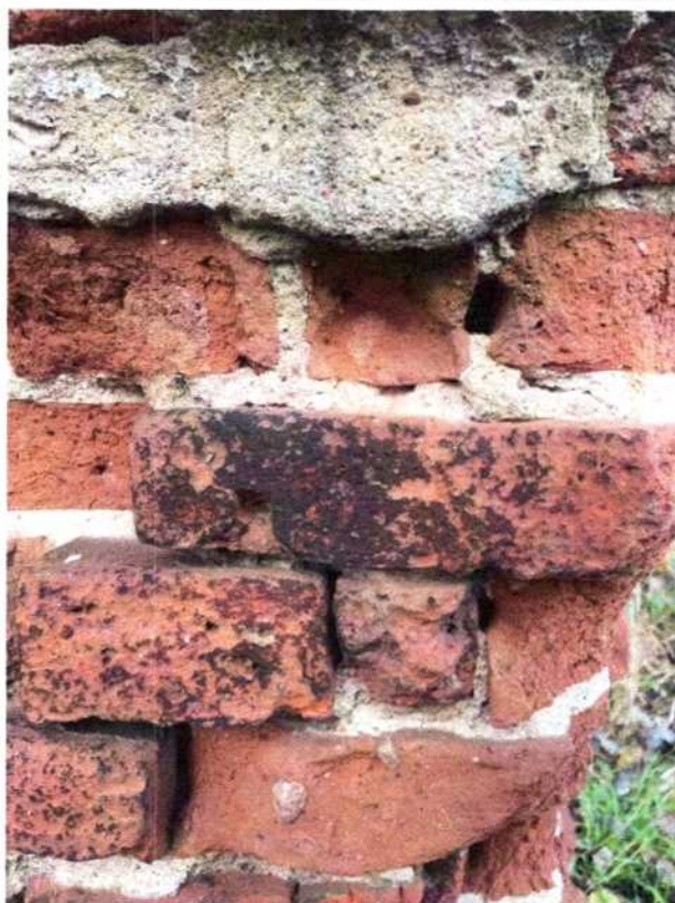
Fot. 8. Cegły silnie zdeintegrowane, wiele z nich straciło swój kształt, osypujące się lico cegły. Widać także ciemne nawarstwienia na cegle.
