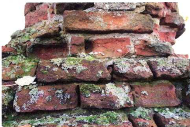
Fot.13. Silne porażenie mikrobiologiczne - mchy, porosty.
