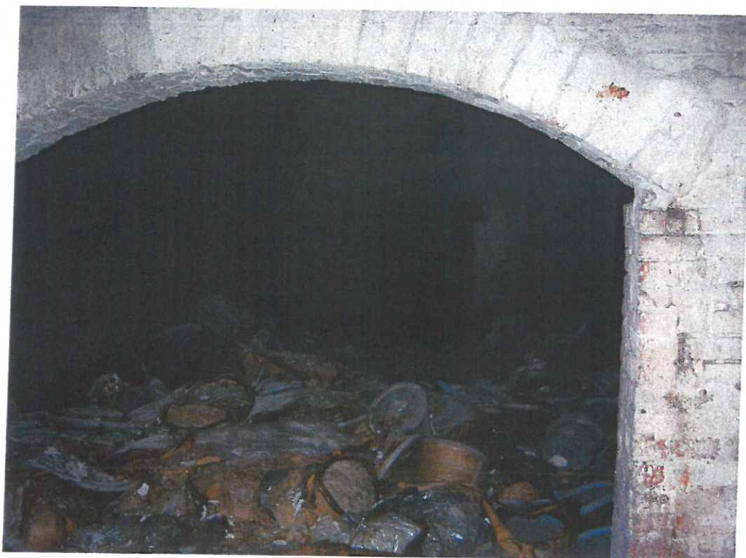
Zdjęcie Nr 7. Opakowania farb i porozrzucane farby w piwnicach browaru
