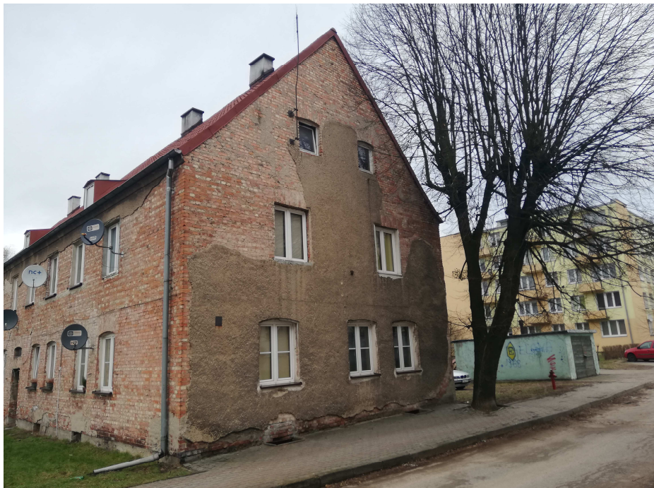
Zdj. nr 8 Elewacja południowa. Tynki do usunięcia. Konieczność cięcia higienicznego gałęzi drzewa w zakresie prac modernizacyjnych.
