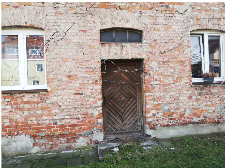
Zdj. nr 2 Fragment elewacji zachodniej. Drzwi i naświetle do wymiany. Do uzupełnienia opaska z kostki betonowej wzdłuż budynku.
