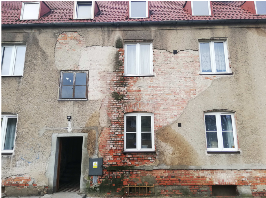
Zdj. nr 6 Fragment elewacji wschodniej. Silne zawilgocenie ściany z powodu braku rury spustowej, ubytki tynków. Okno na klatce schodowej do wymiany.
