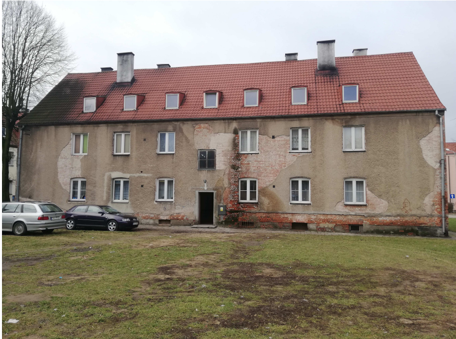
Zdj. nr 5 Elewacja wschodnia. Tynki do usunięcia.
