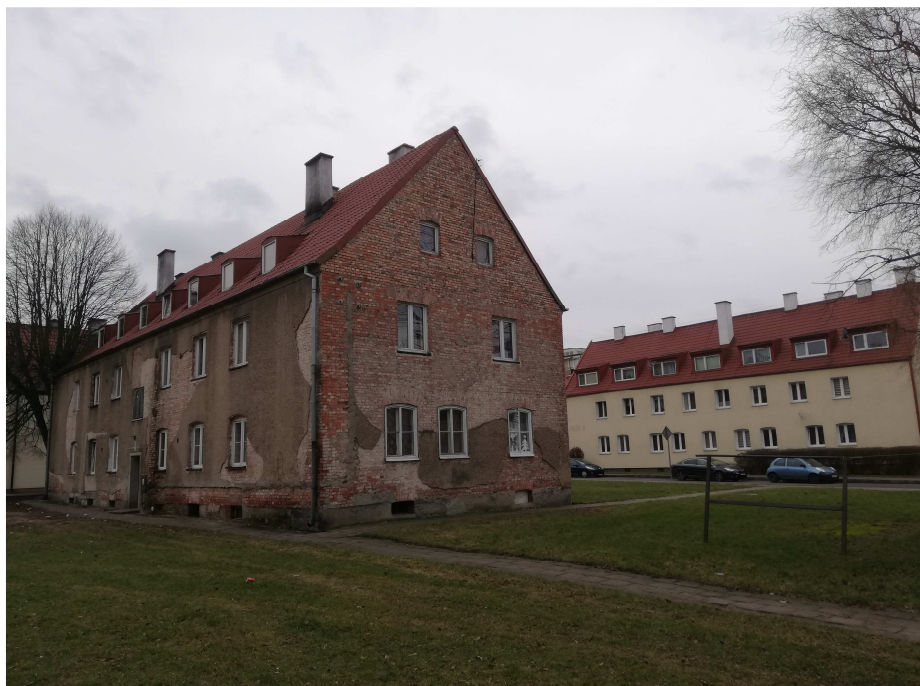
Zdj. nr 4 Elewacja północna i wschodnia. Silne zawilgocenia ścian w części przyziemia spowodowane złym odwodnieniem. Okna parteru w elewacji północnej do wymiany. Pozostałości tynków do usunięcia.
