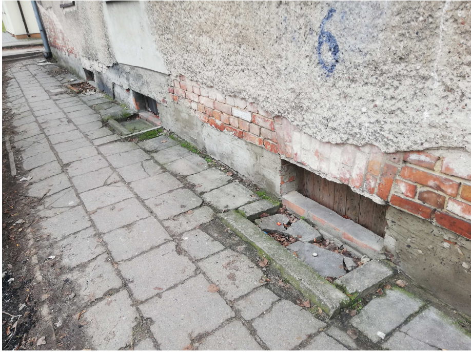
Zdj. nr 7 Fragment chodnika od strony wschodniej budynku. Płytki, obrzeża chodnikowe do wymiany na kostkę betonową.
