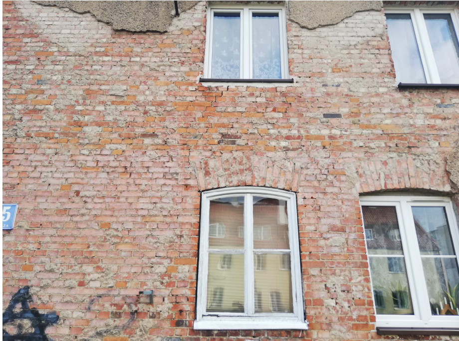
Zdj. nr 3 Fragment elewacji zachodniej. Przed przystąpieniem do prac dociepleniowych należy naprawić (przemurować) zarysowanie ściany. Okno drewniane do wymiany.
