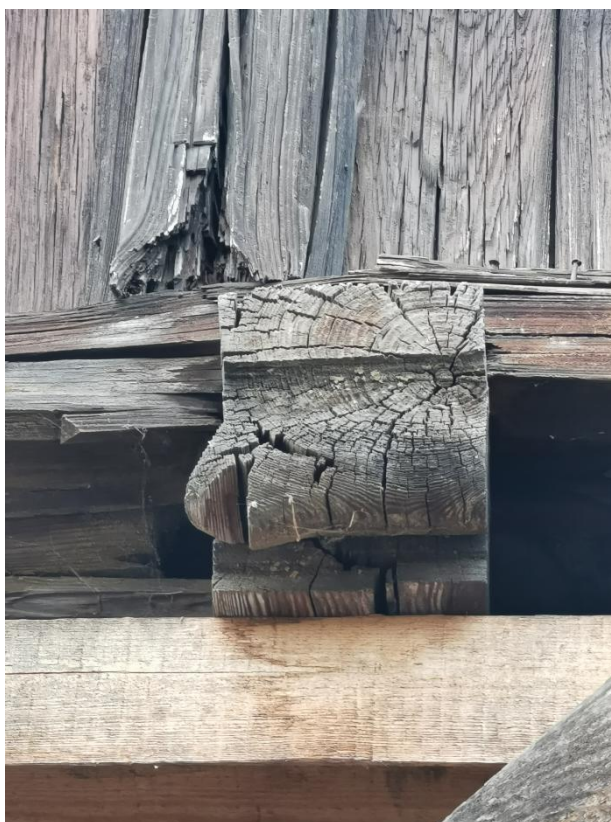
Fot. 7. Spękania i odkształcenie końcówki belki stropowej oraz ubytek jednej z desek szalunku
