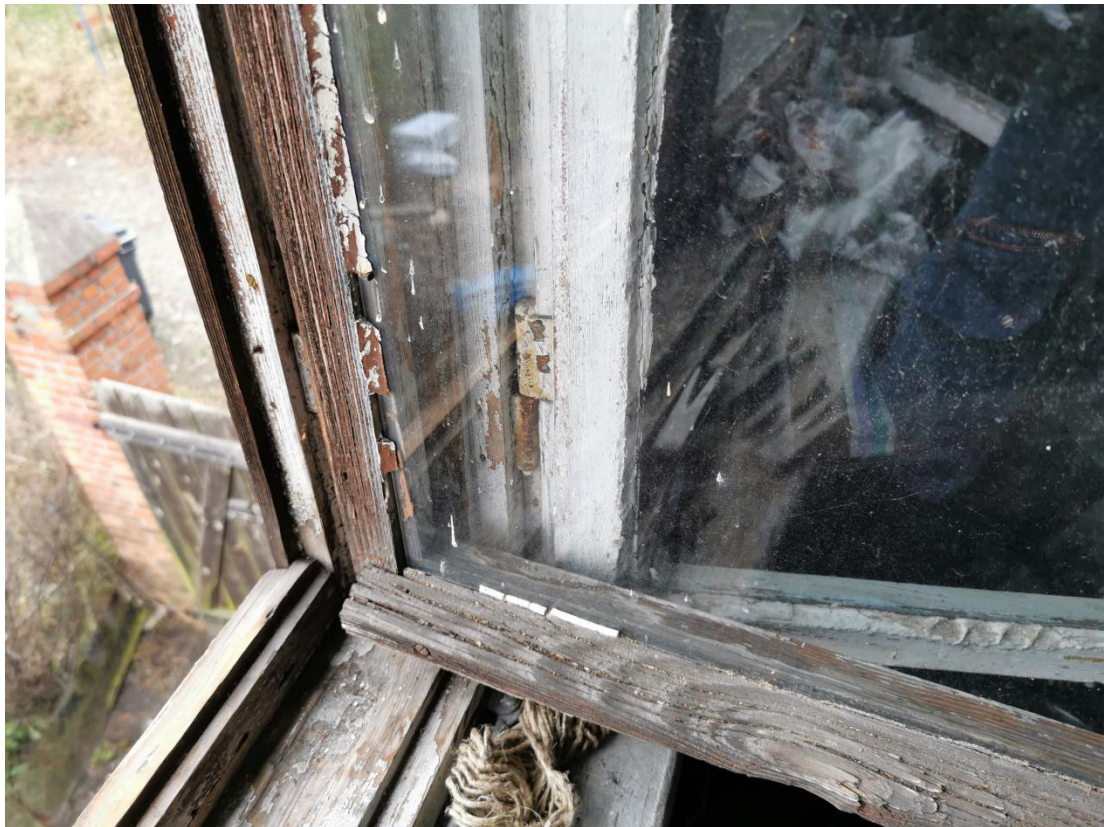
Fot. 20. Zły stan ramiaka okiennego - widoczna degradacja drewna i wykruszenia kitu szklarskiego
