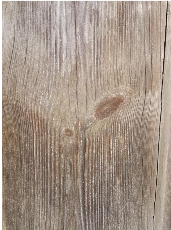
Fot. 16. Zbliżenie na jedną z desek w partii altany - widoczne wgłębienia między słojami powstałe na skutek wieloletniego oddziaływania wiatru i deszczu
