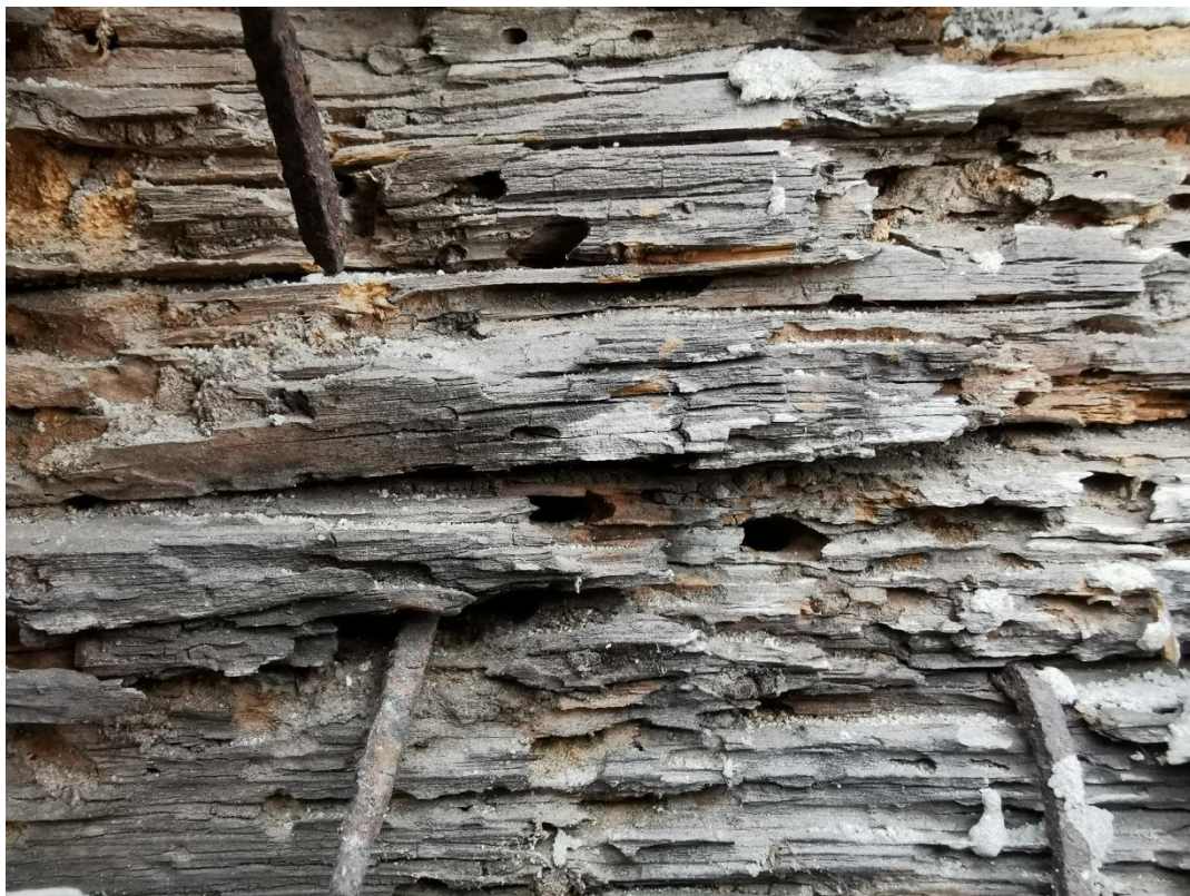
Fot. 13. Zbliżenie na korozję biologiczną drewna deski podwalinowej
