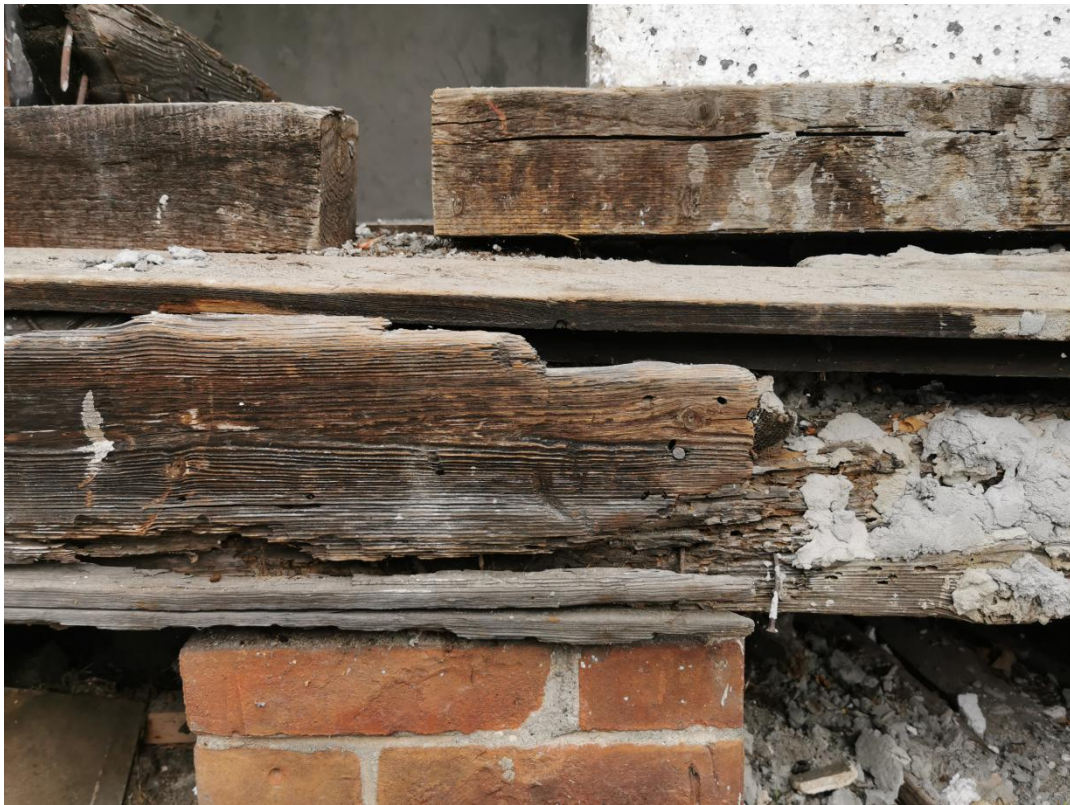
Fot. 12. Destrukcja belki podwalinowej spowodowana korozją biologiczną - działaniem grzybów i owadów ksylofagicznych
