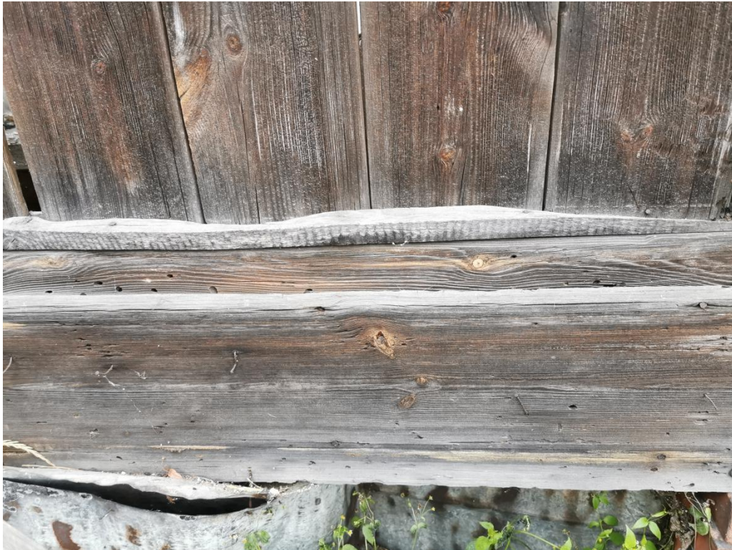
Fot. 14. Dolna część altany ze śladami niszczącej działalności spuszczela pospolitego
