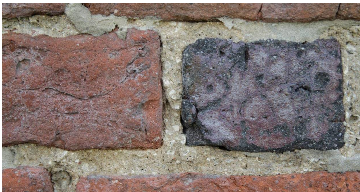
Spoina wapienna na fragmencie muru – odcinek północno-wschodni mogący służyć za wzór dla zaprawy spoinującej. Do weryfikacji na etapie prac remontowo-konserwatorskich.
