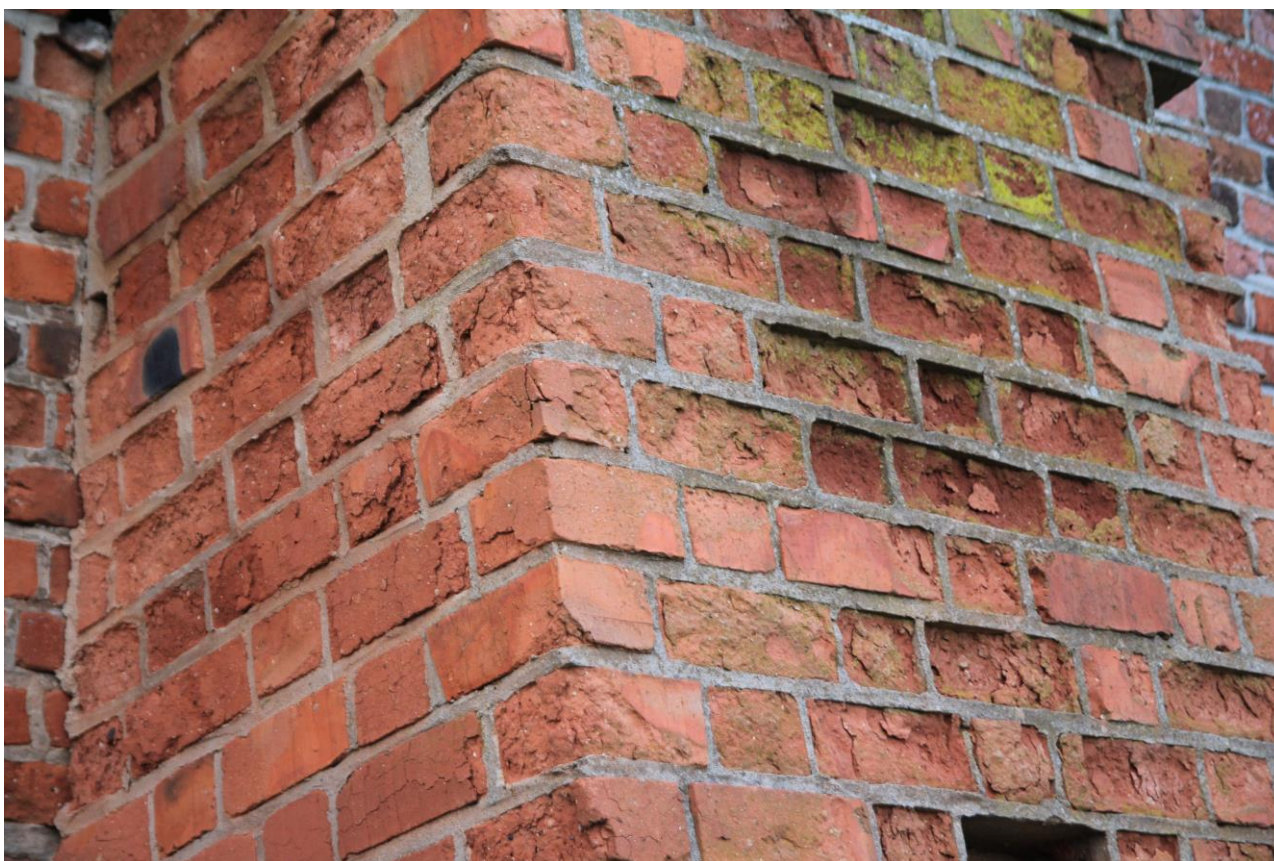
Zniszczenia cegieł murowanych na zwartej zaprawie cementowej, fragment.
