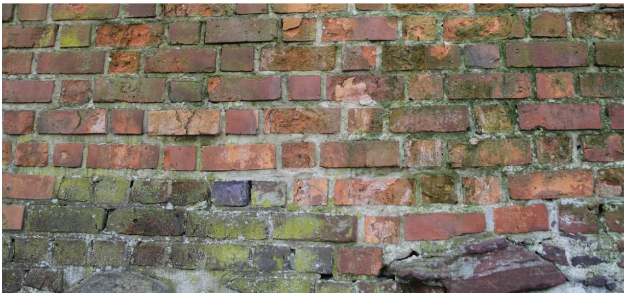
Stan zachowania murów, przykład korozji biologicznej zawilgoconych murów.
