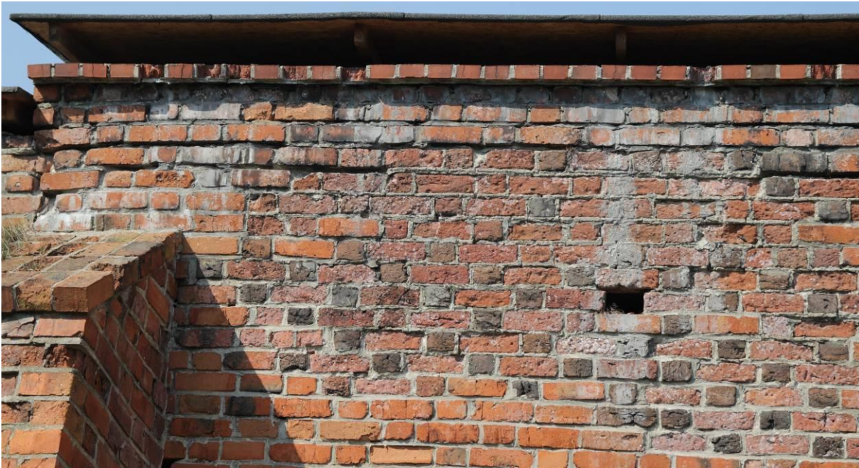
Stan zachowania lica, zacieki mleczka cementowego zaprawy murarskiej wtórnego zamknięcia korony murów..
