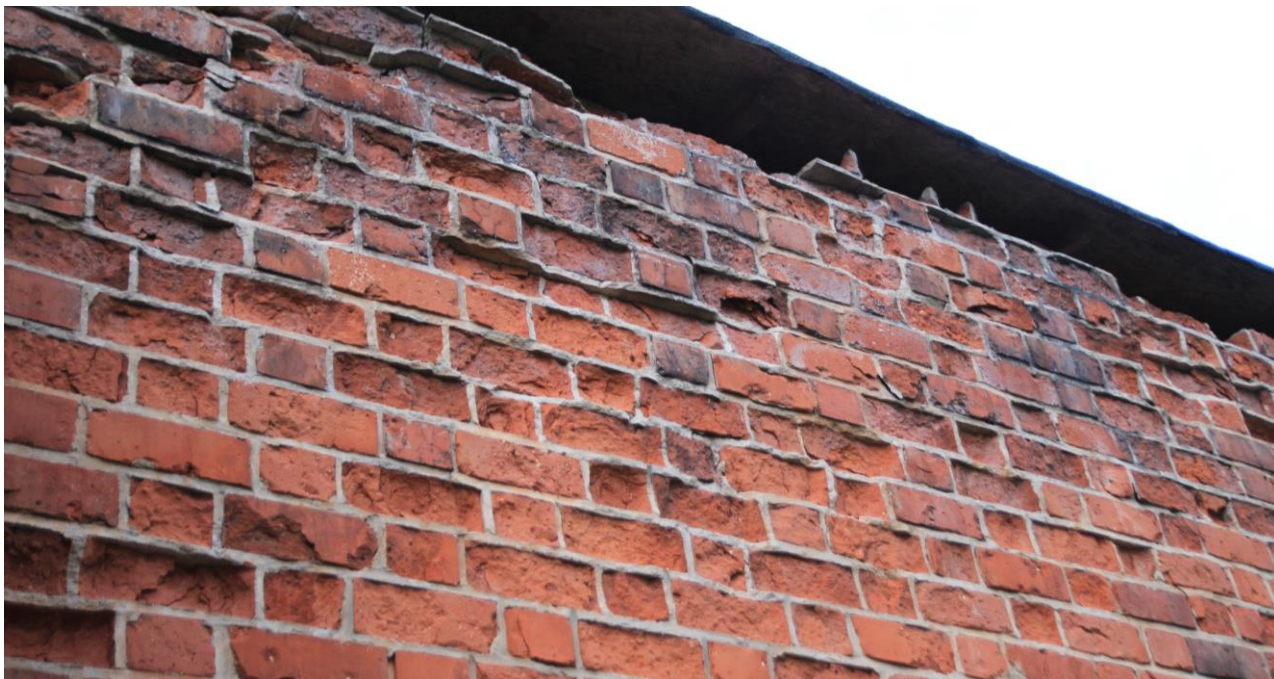
Zniszczenia podpowierzchniowej warstwy cegieł murowanych na zwartej zaprawie cementowej, charakterystyczny obraz stanu zachowania przemurowań w strefie korony murów.
