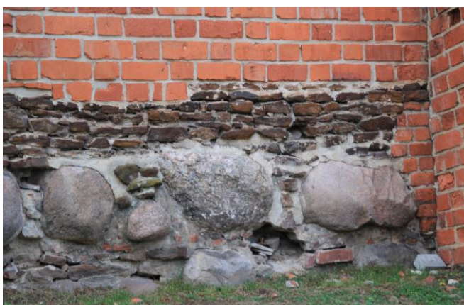
Ubytki lica przy podstawie muru.
