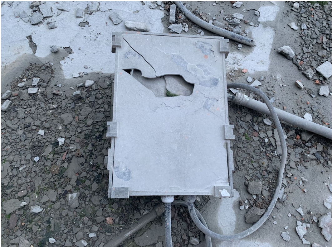
Fot. 21. Oprawa oświetleniowa uszkodzona spadającym fragmentem muru z komina
