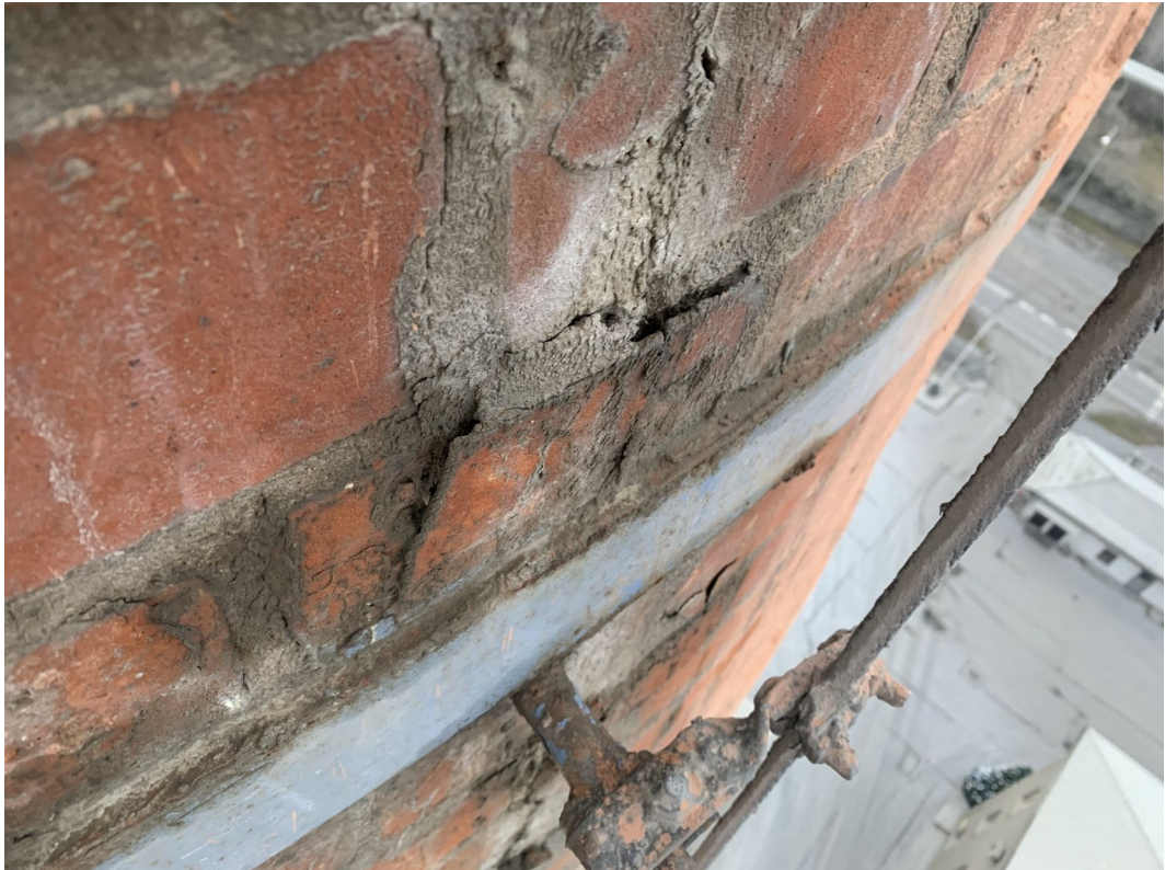
Fot. 10. Odspojenie lica cegły
