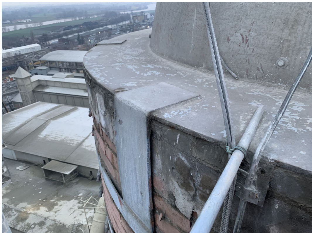
Fot. 7. Mocowanie zwężki – bez uszkodzeń, brak okapnika
