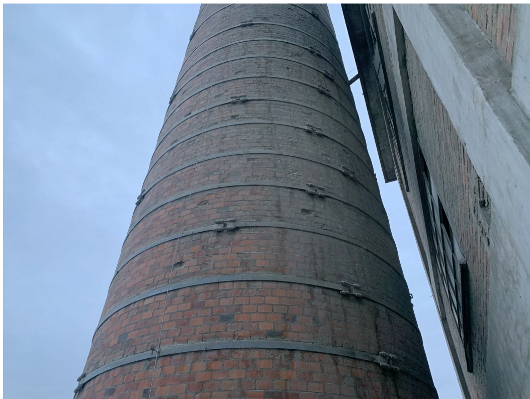
Fot. 3. Środkowa część komina – liczne uszkodzenia i wycieki
