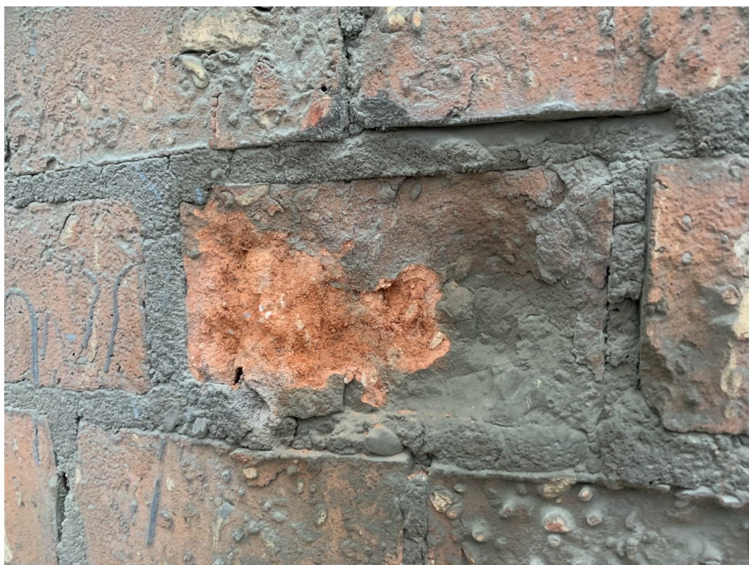
Fot. 15. Zmurszałe lico cegły – warstwa usunięta palcami, bez użycia narzędzi
