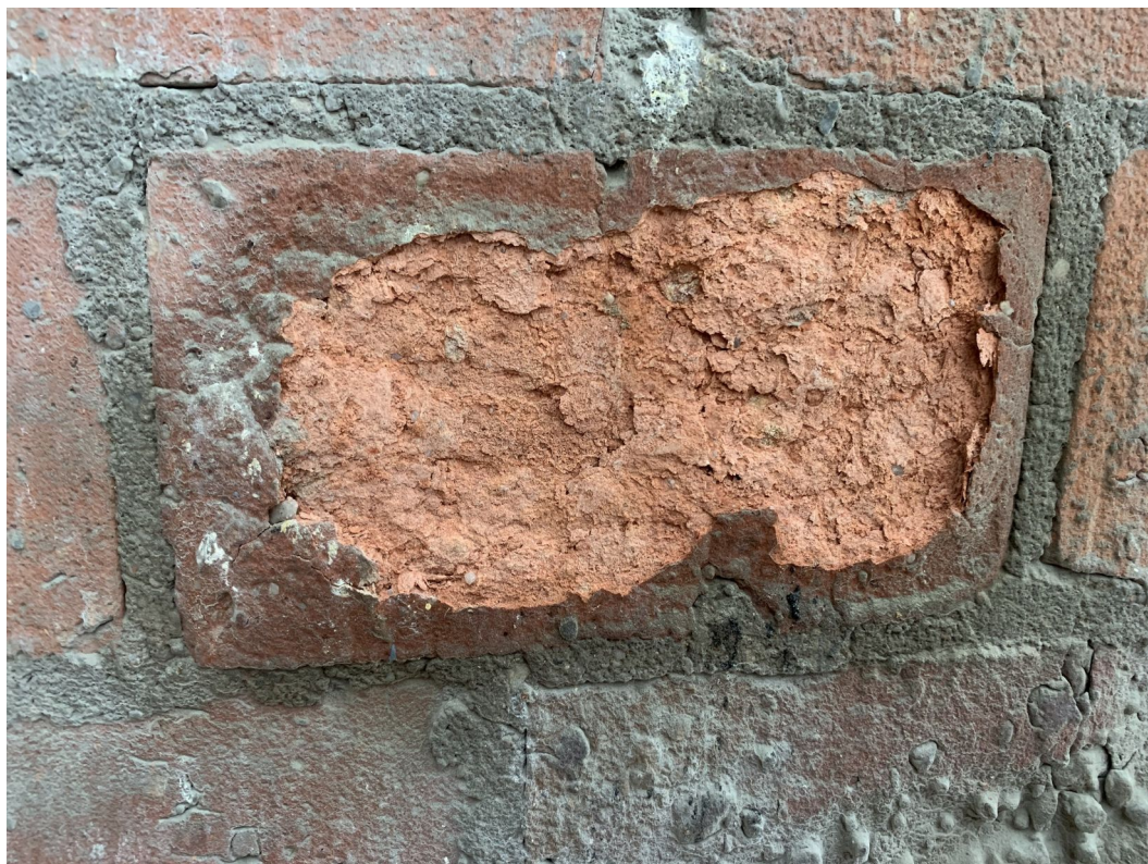
Fot. 18. J.w. całe lico cegły usunięte palcami
