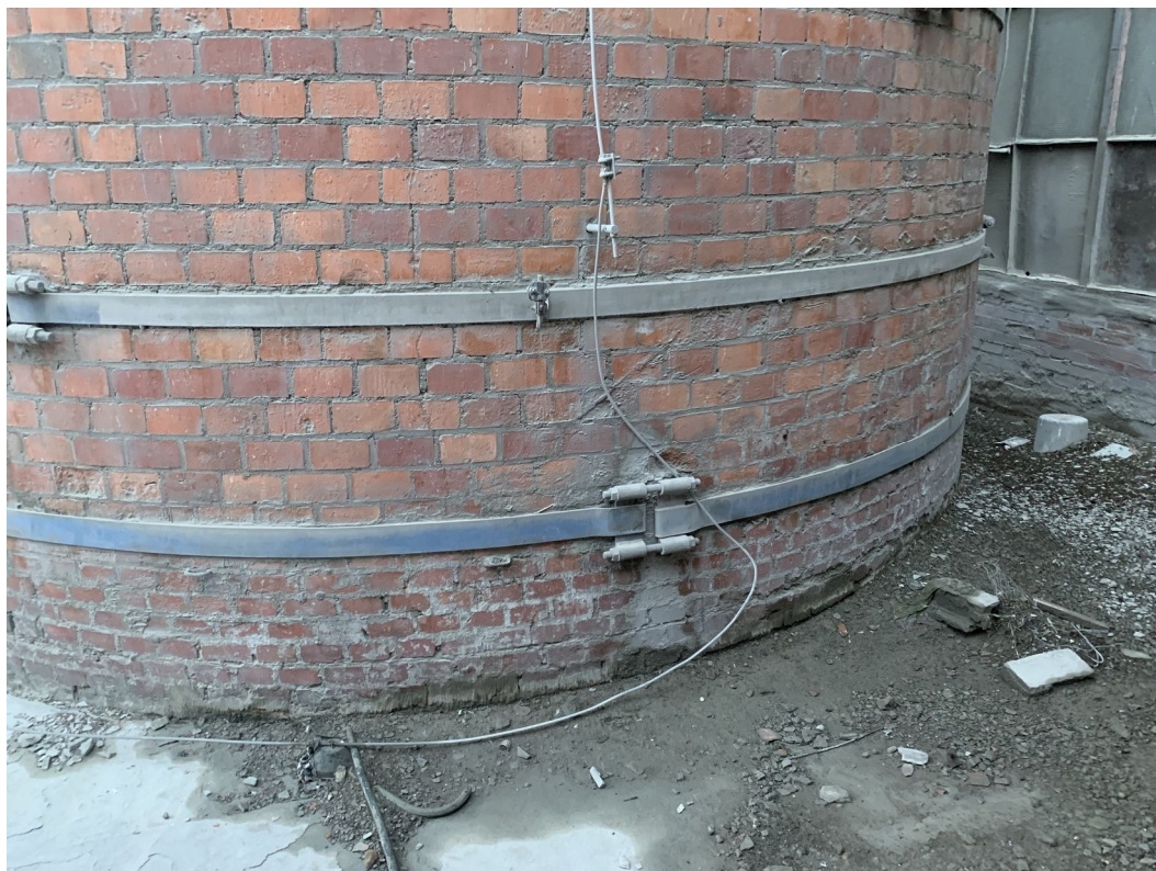
Fot. 22. Instalacja odgromowa - ciągła
