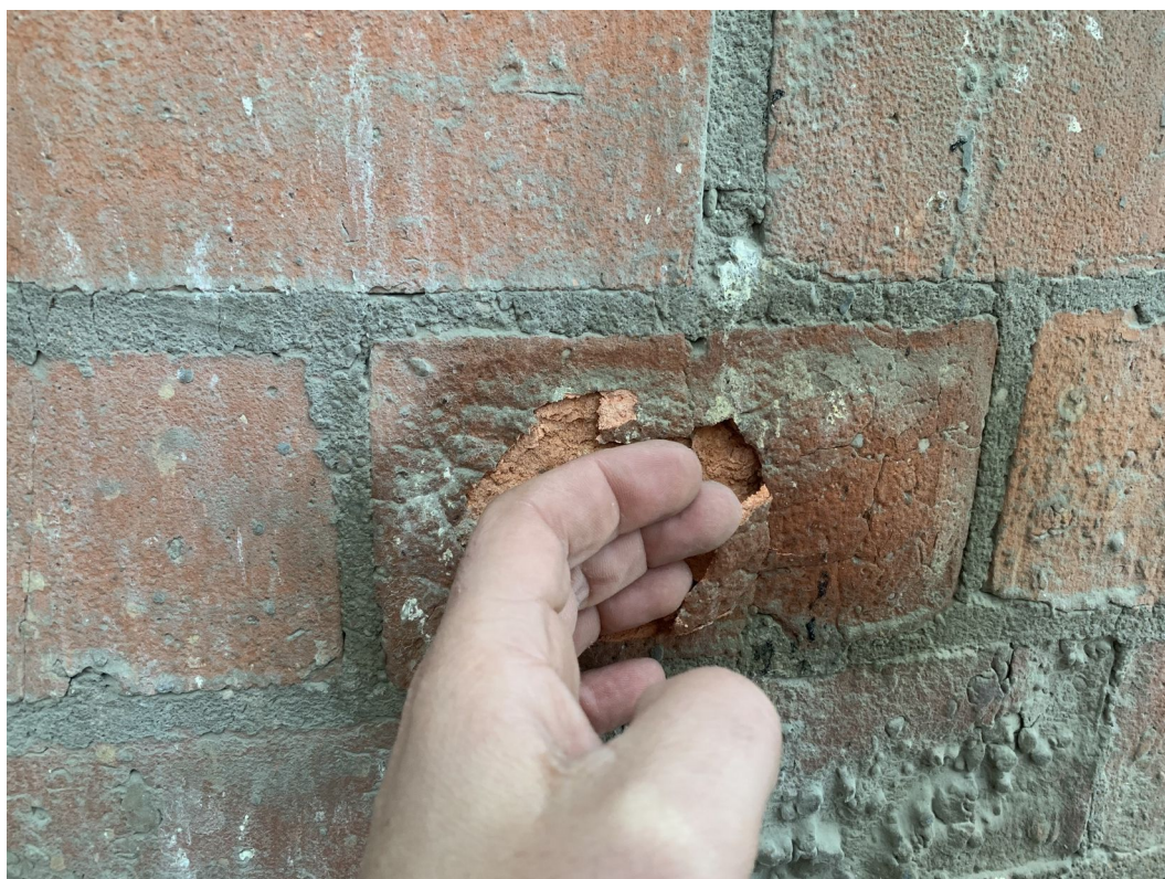
Fot. 17. J.w, warstwa zewnętrzna odpadająca pod naciskiem palców
