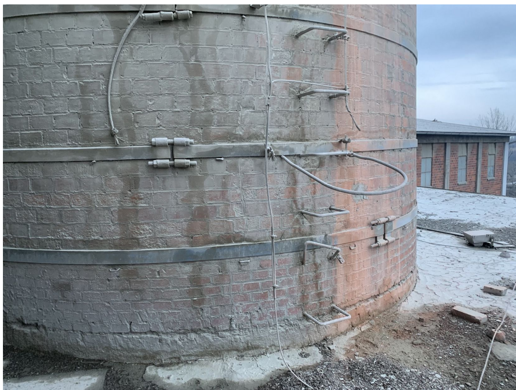
Fot. 23. Instalacja odgromowa - ciągła
