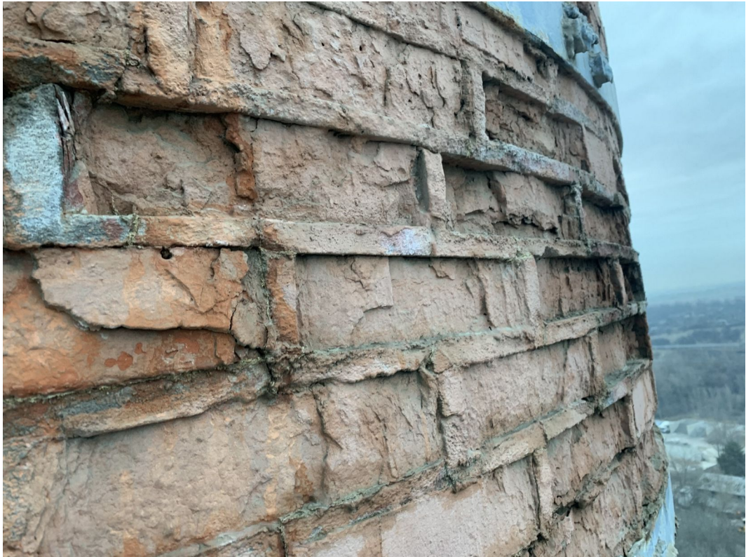
Fot. 8. Silne zniszczenie muru poniżej wylotu komina, liczne odspojenia
