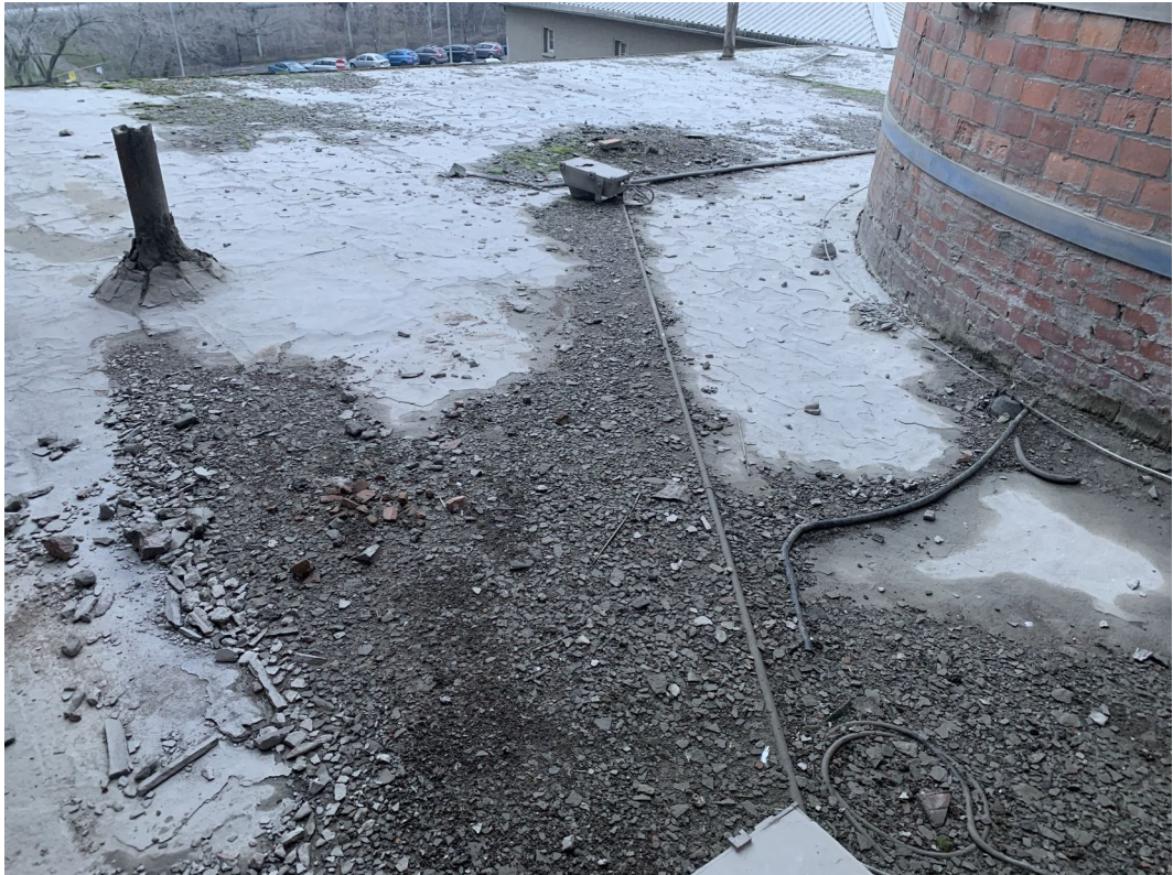
Fot. 20. Dach hali zasłany gruzem odpadającym z komina
