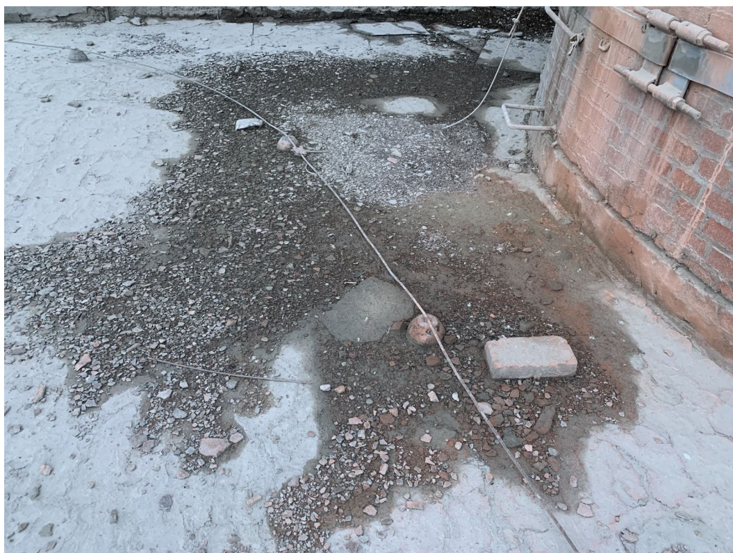
Fot. 19. Dach komina z zalegającymi odpadniętymi fragmentami licówki cegiel
