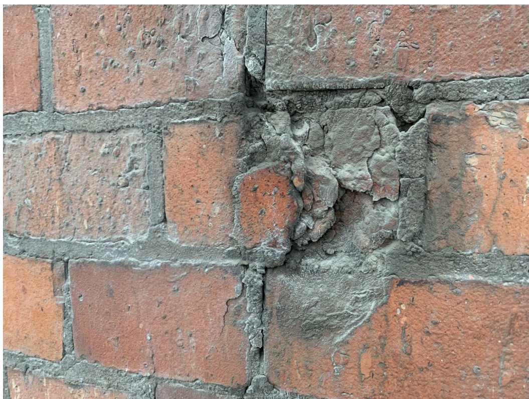
Fot. 13. Degradacja cegieł
