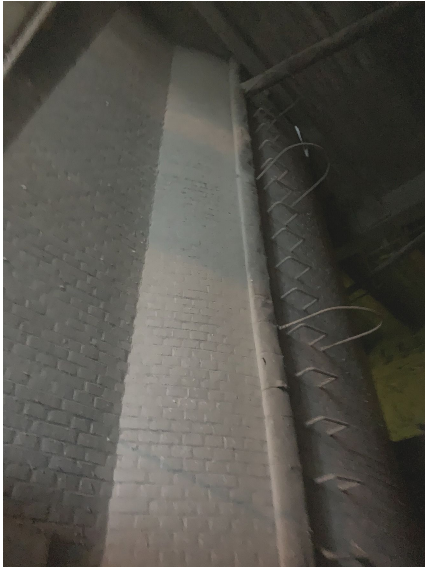
Fot. 5. Dolna część komina (pod dachem hali) – duże zapylenie, brak widocznych uszkodzeń
