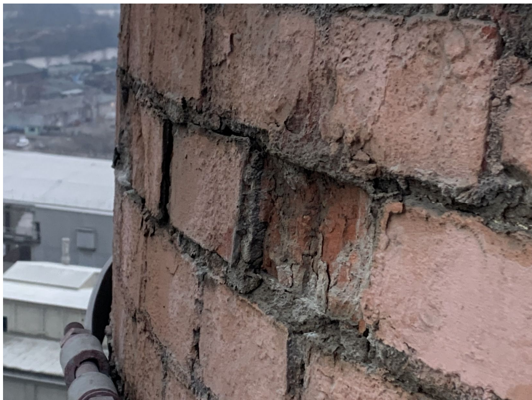
Fot. 12. Odspojone lica cegieł, grożące upadkiem z wysokości
