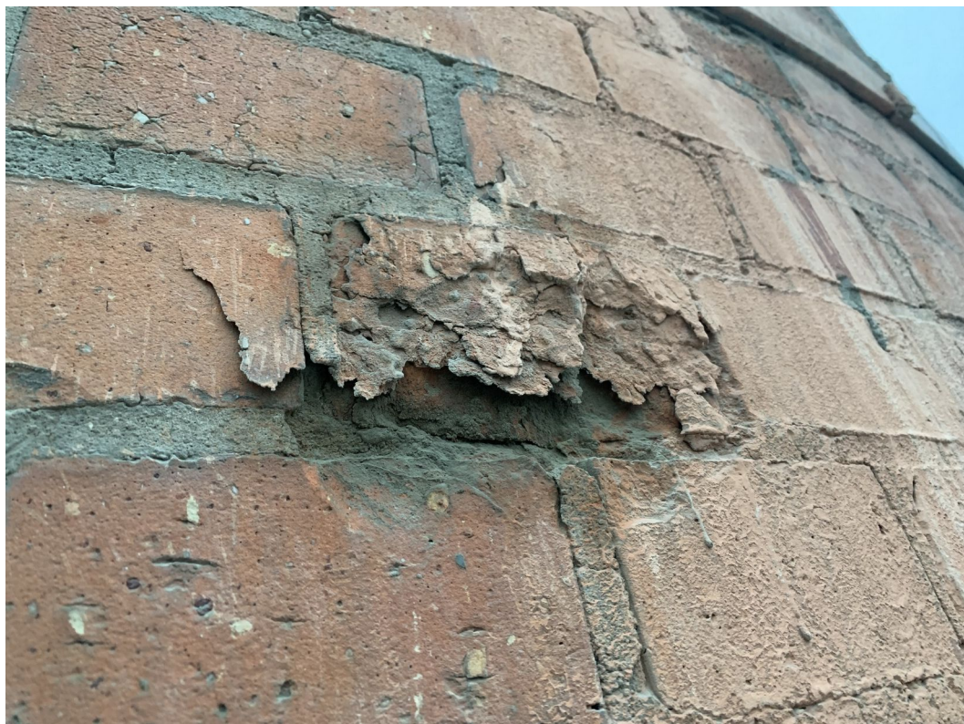
Fot. 14. Złuszczenia i odspojenia zewnętrznej warstwy muru
