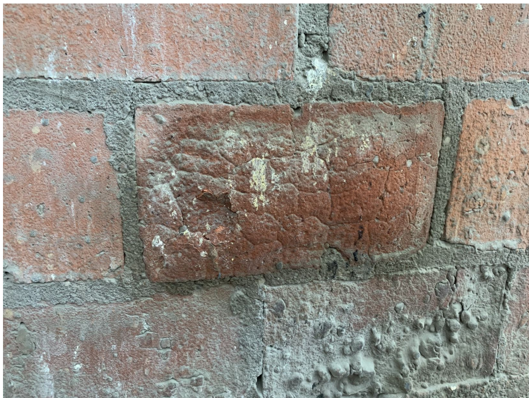
Fot. 16. Zmurszałe i spęczniałe lico cegły
