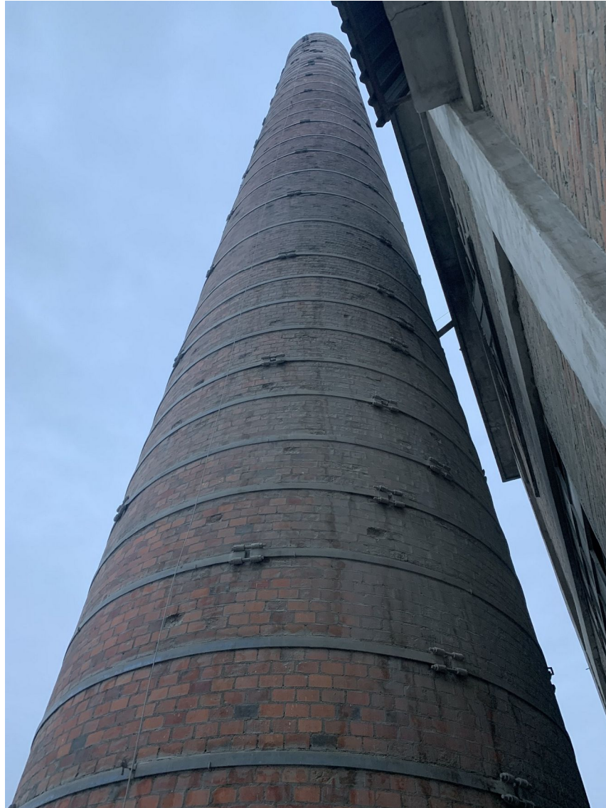
Fot. 2. Część komina ponad dachem hali, widoczne liczne ubytki cegieł
