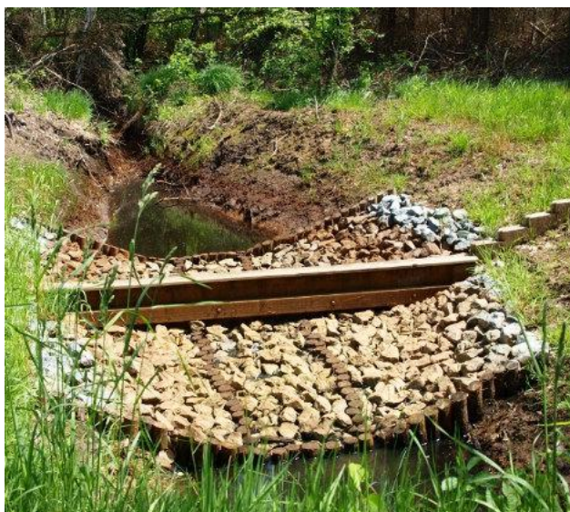
Dobrze ubezpieczony próg z pojedynczej ścianki szczelnej. Fot. Z. Filipek. Źródło: Archiwum CKPS.
