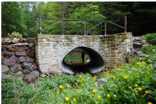
Rachityczna barierka na szczycie przepustu. Źródło: Archiwum CKPŚ.
