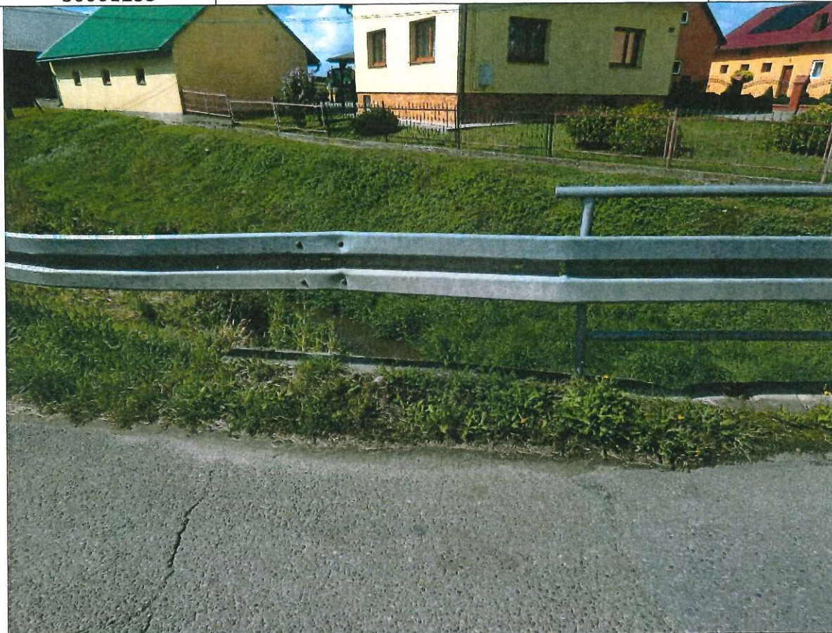
Fot. 9. deformacja bariery energochłonnej
