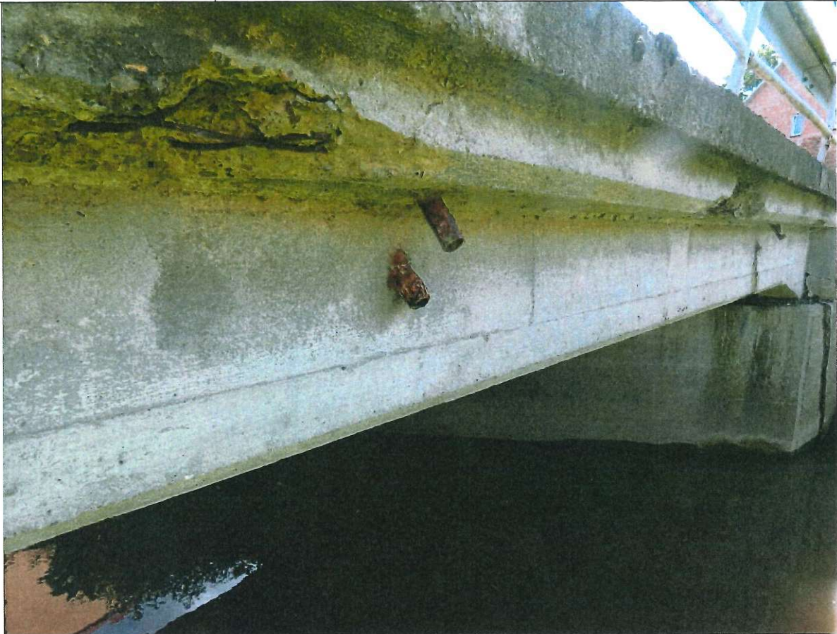
Fot. 5. korozja biologiczna elementów betonowych i stalowych, odsłonięcie zbrojenia w prześle
