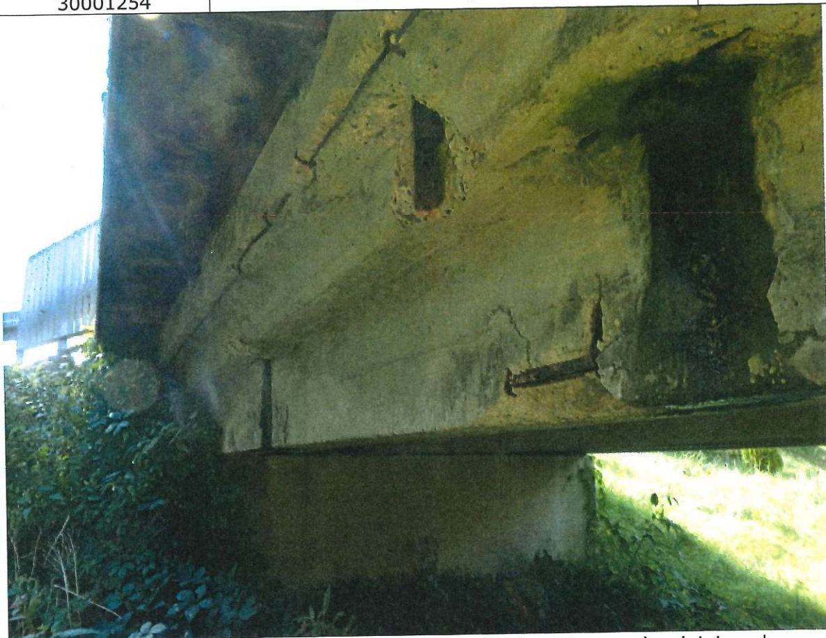
Fot. 5. wyciek z rury odwadniającej na przęsło, korozja rur odwadniających
