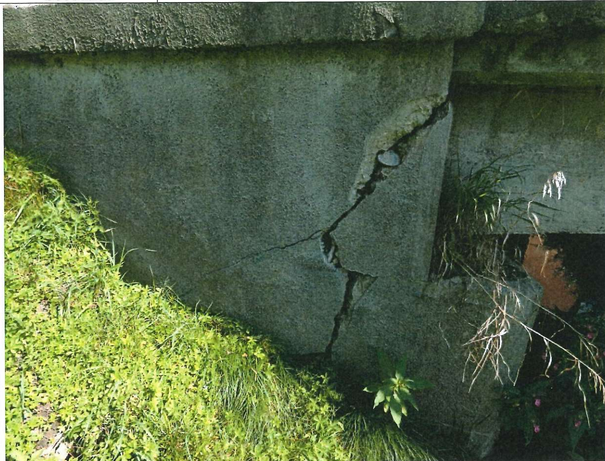
Fot. 3. pęknięcie skrzydła z przemieszczeniem
