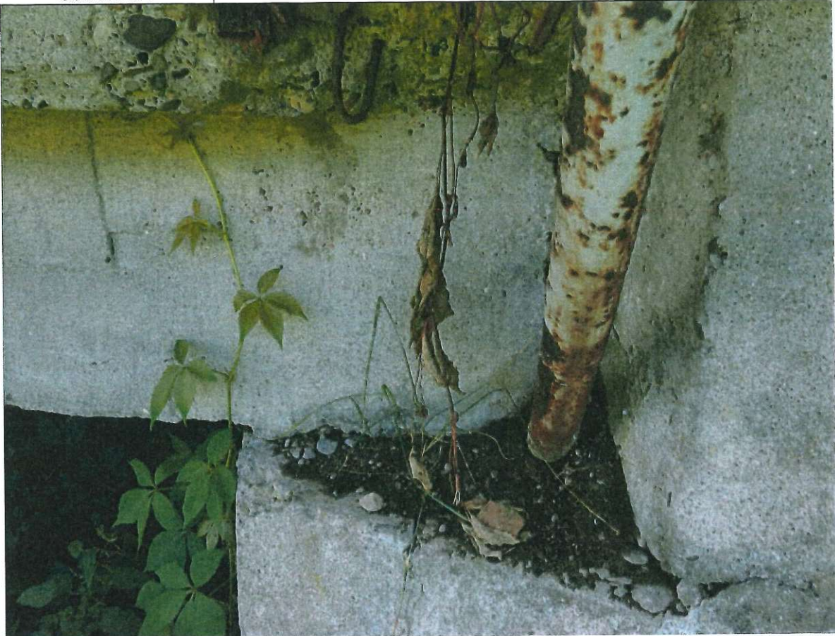
Fot. 7. zanieczyszczenia ławy podłożyskowej, korozja wspornika stalowego
