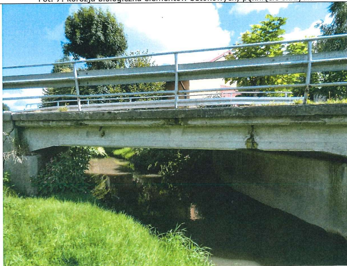
Fot. 8. ubytki betonu gzymsu, korozja rur odwadniających most, wegetacja roślinności
