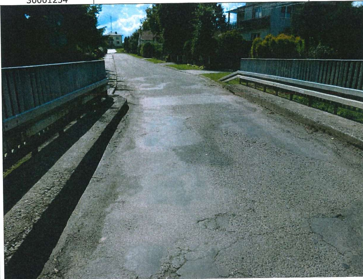
Fot. 1. zarysowania, deformacje i zanieczyszczenia nawierzchni jezdni
