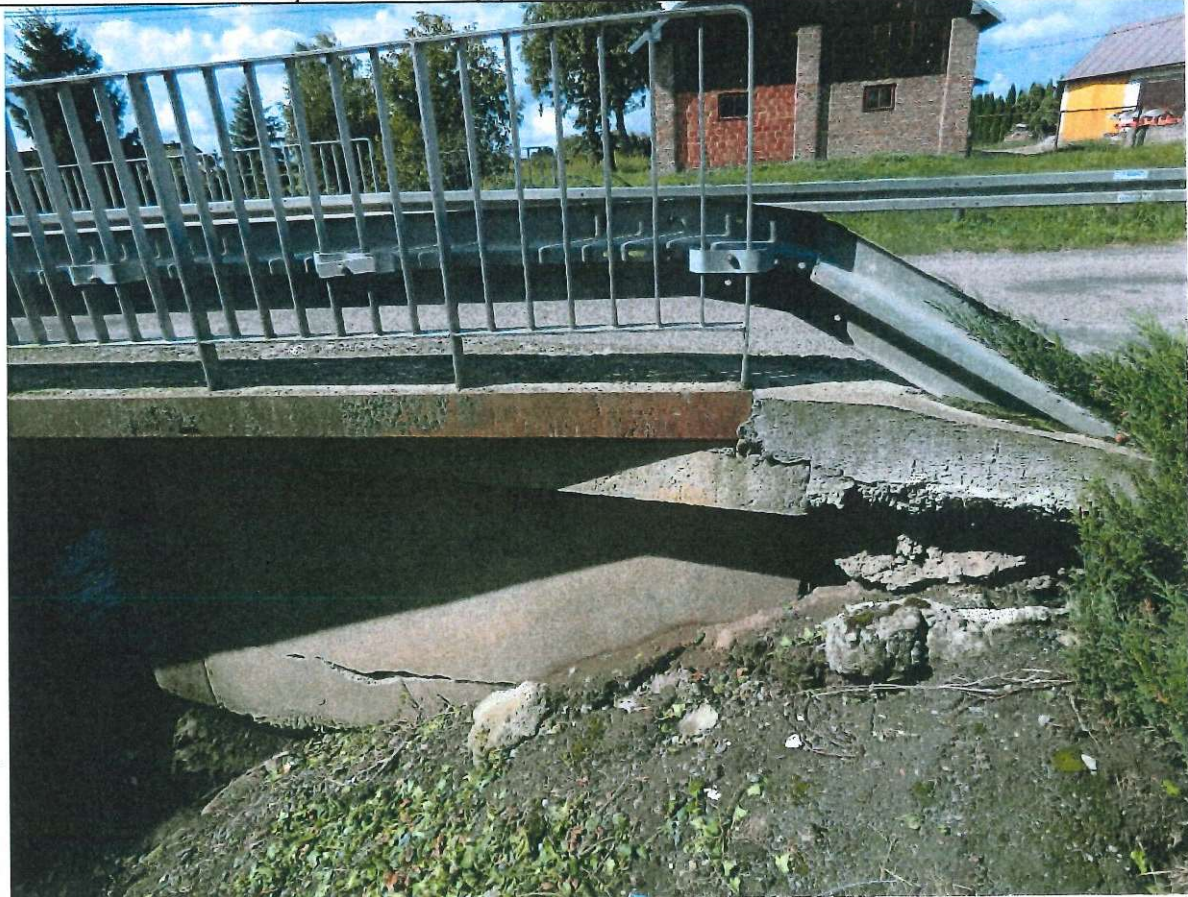
Fot. 8. korozja elementów stalowych na obiekcie, zarysowanie skrzydła
