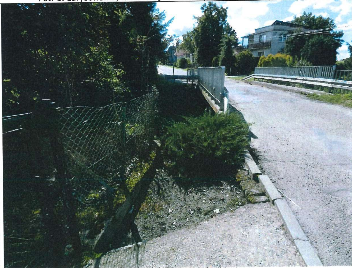
Fot. 2. przemieszczenie krawężnika
