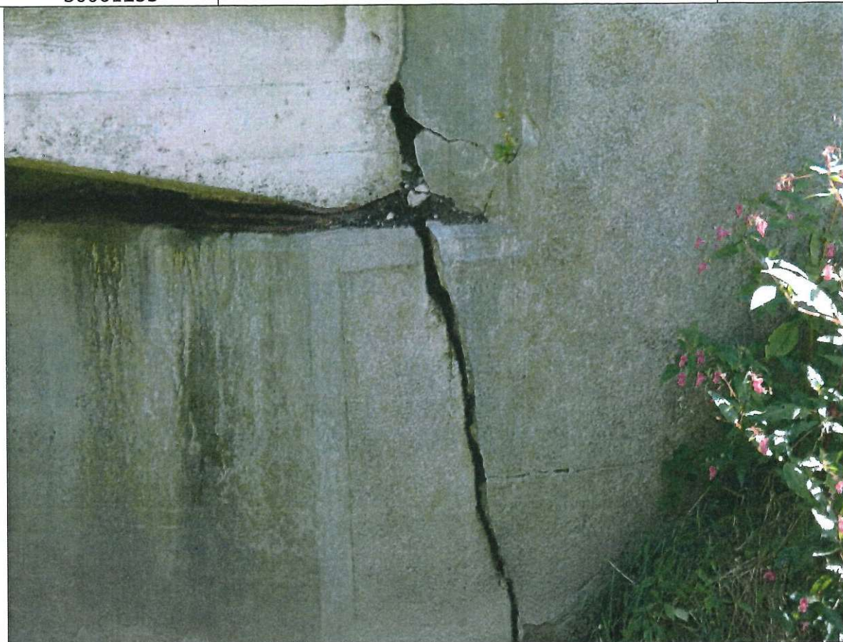
Fot. 7. korozja biologiczna elementów betonowych, pęknięcie skrzydła
