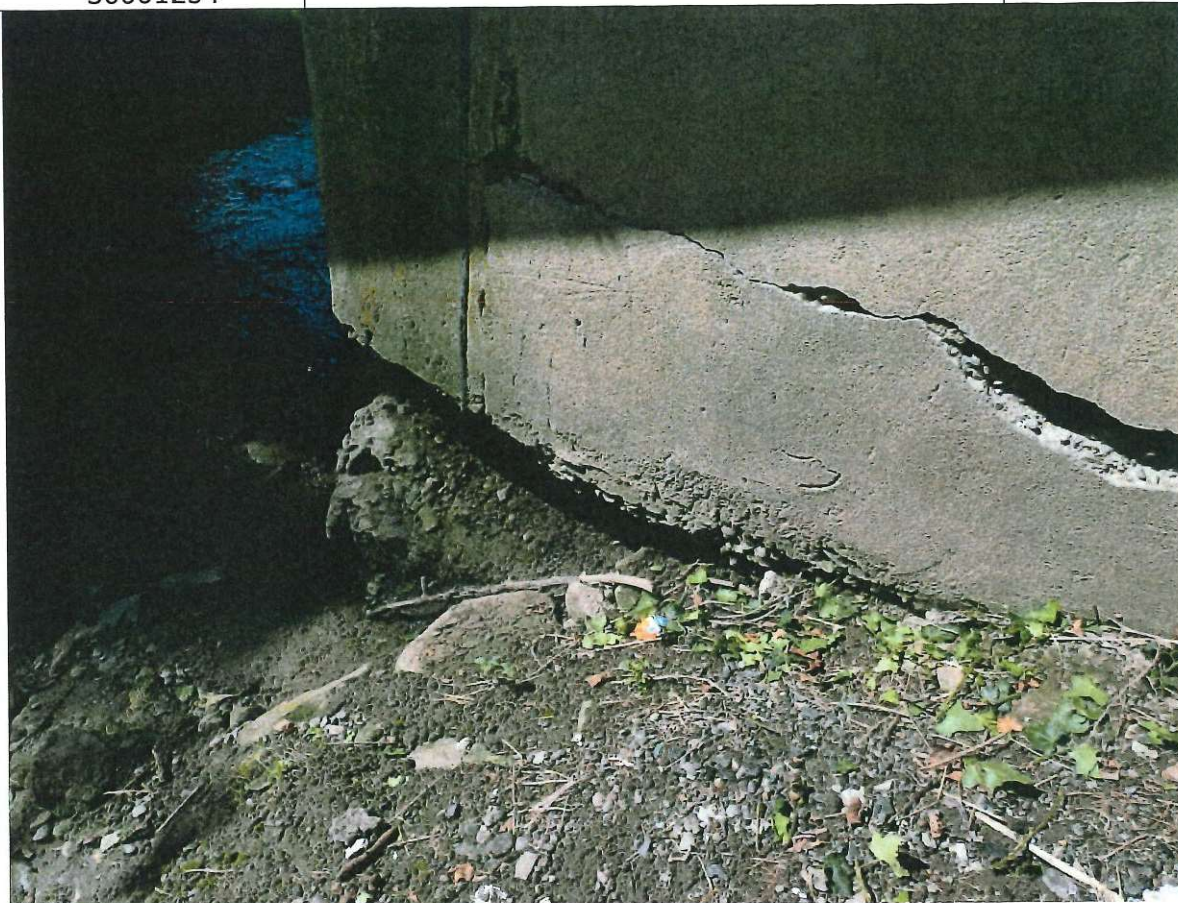
Fot. 3. Pęknięcie poprzeczne skrzydła
