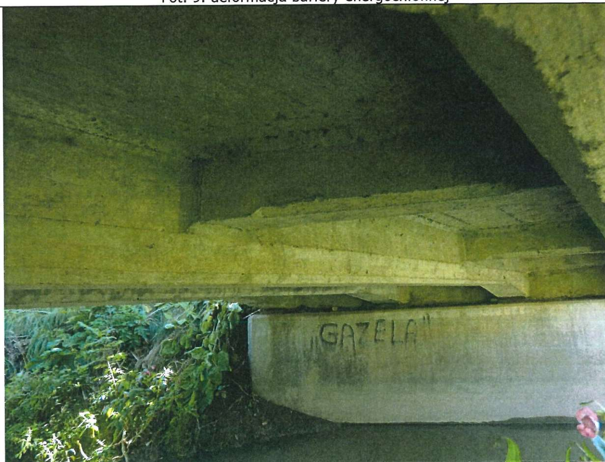
Fot. 10. Widok na przęsło i podpórę, graffiti
