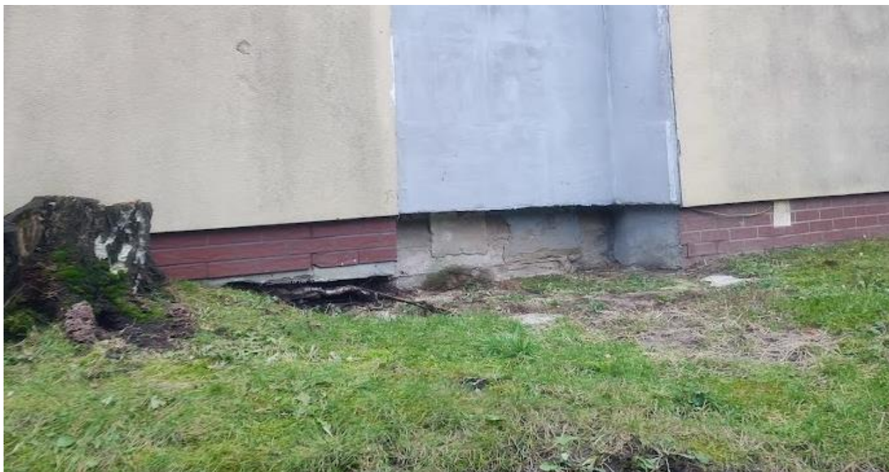
Rysunek 2 - Brak płytek klinkierowych
