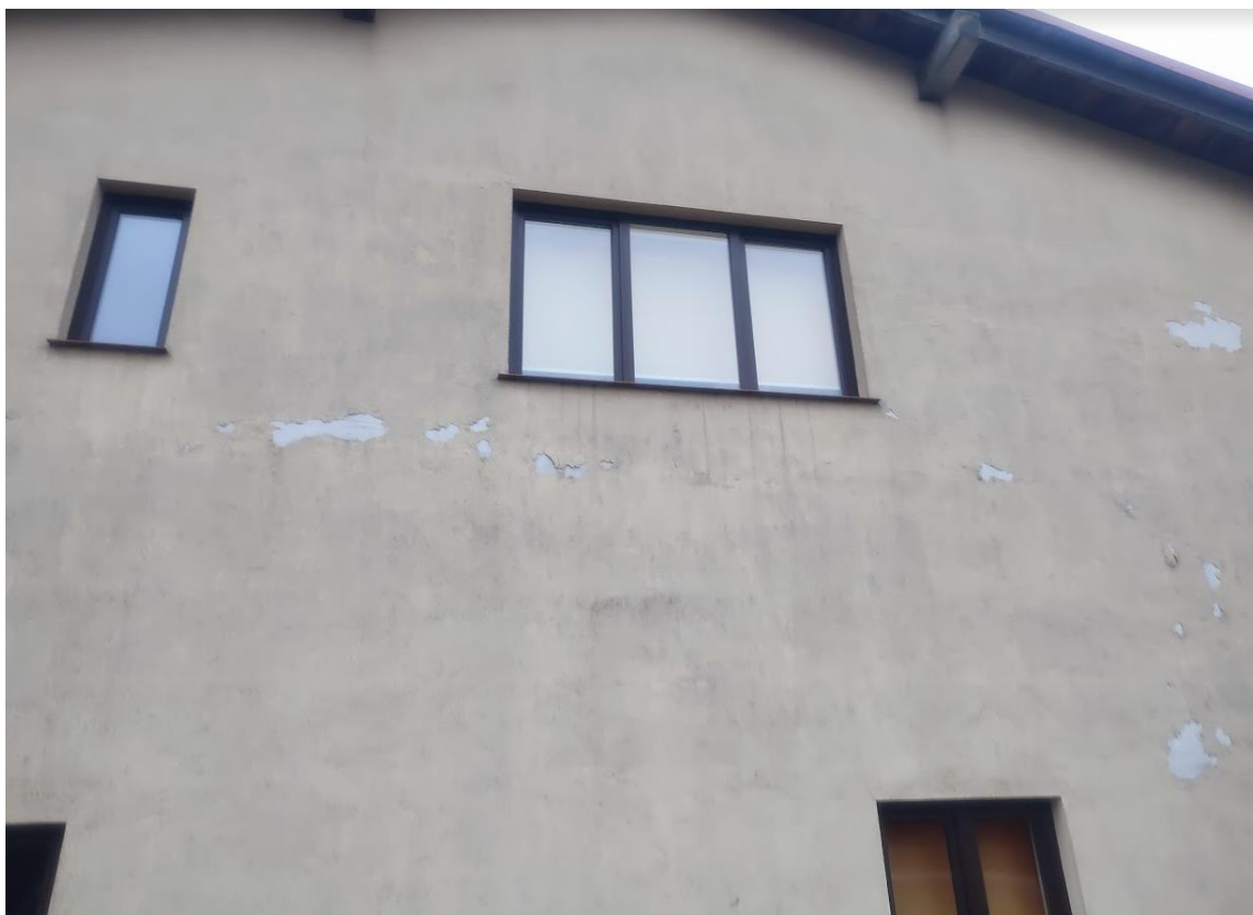
Rysunek 3 - Liczne ubytki warstwy fakturowej
