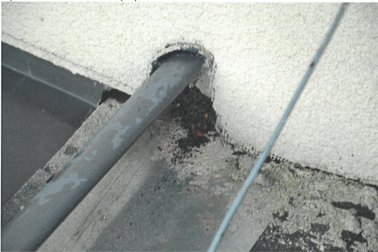
Zdj.19 Nieprawidłowo zakończona rynna – woda penetruje ocieplenie części muru
