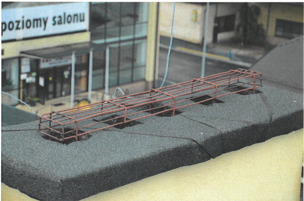
Zdj.21,22 Widoczne duże przestrzenie wentylacyjne kominów narażone na wnikanie wód opadowych
