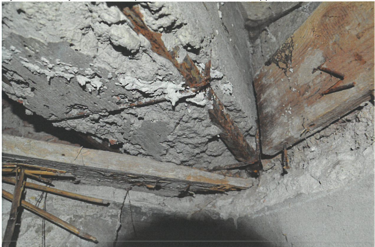
Zdj.4 Odspojone zbrojenie w belce stropodachu nad klatką schodową do mieszkań prywatnych
