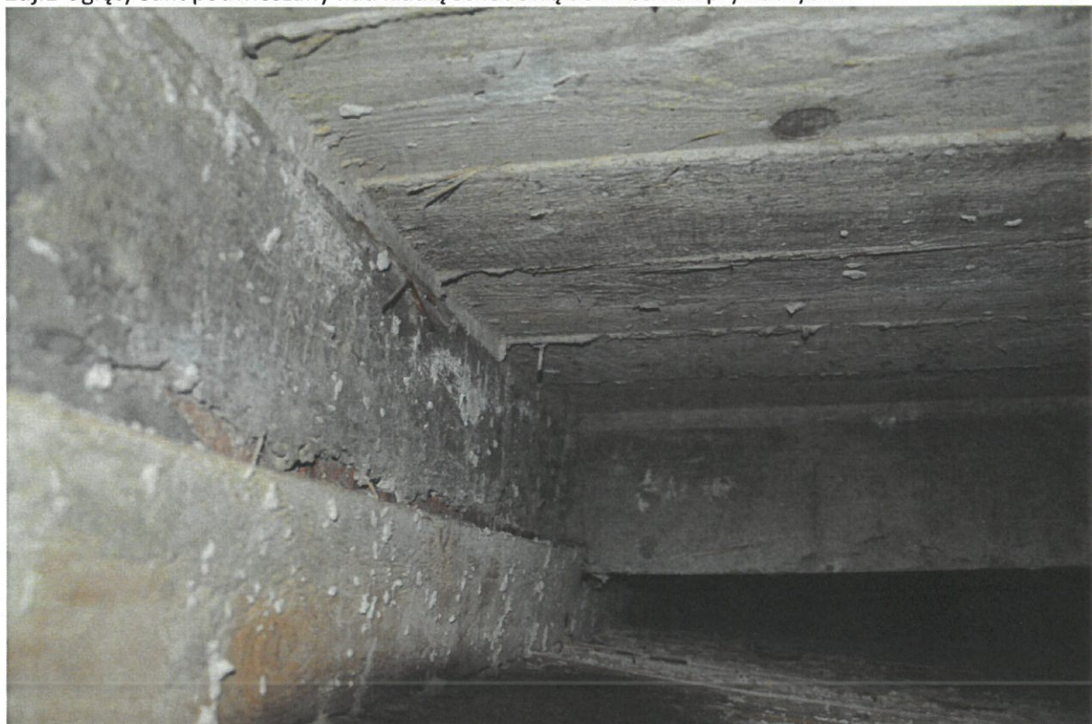
Zdj.2 Newralgiczne miejsce na styku ściany i stropodachu nad klatką schodową – widoczne zawilgocenie desek powstałe na skutek zwykłych opadów parę godzin wcześniej
