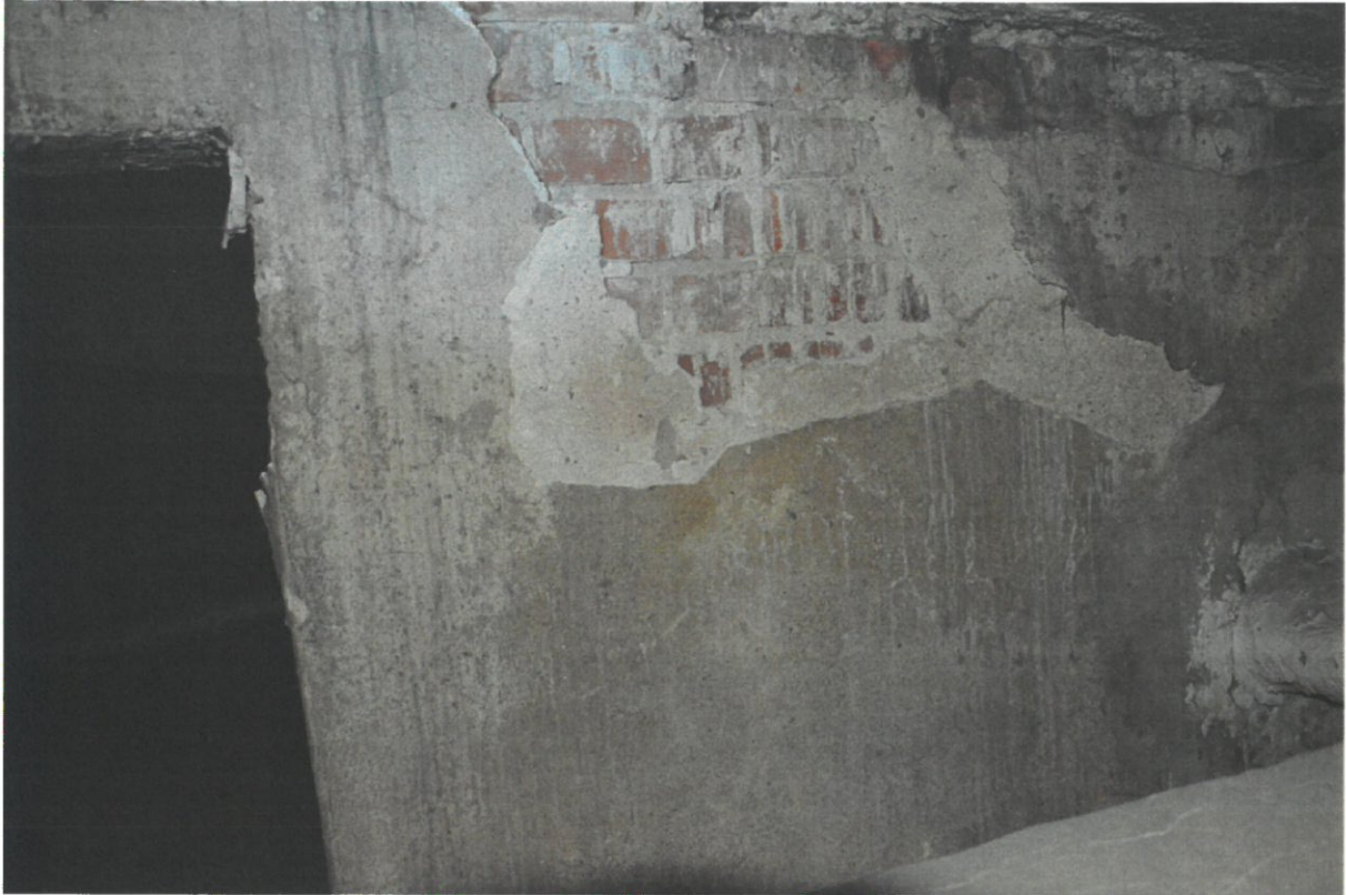
Zdj.25 Napuchnięte i zawilgocone tynki wewnętrzne na kominie penetrowanym przez wodę opadową
