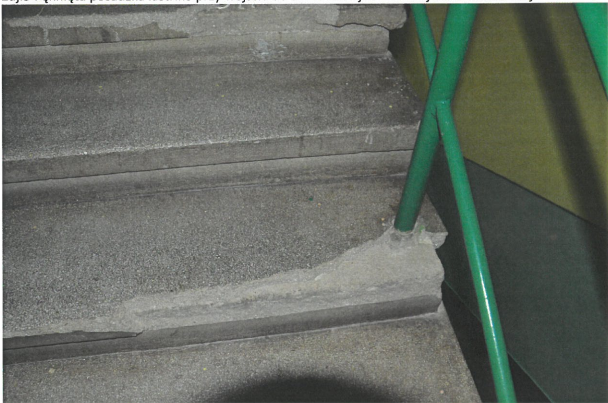
Zdj.6 Uszkodzony fragment schodów bocznej klatki schodowej
