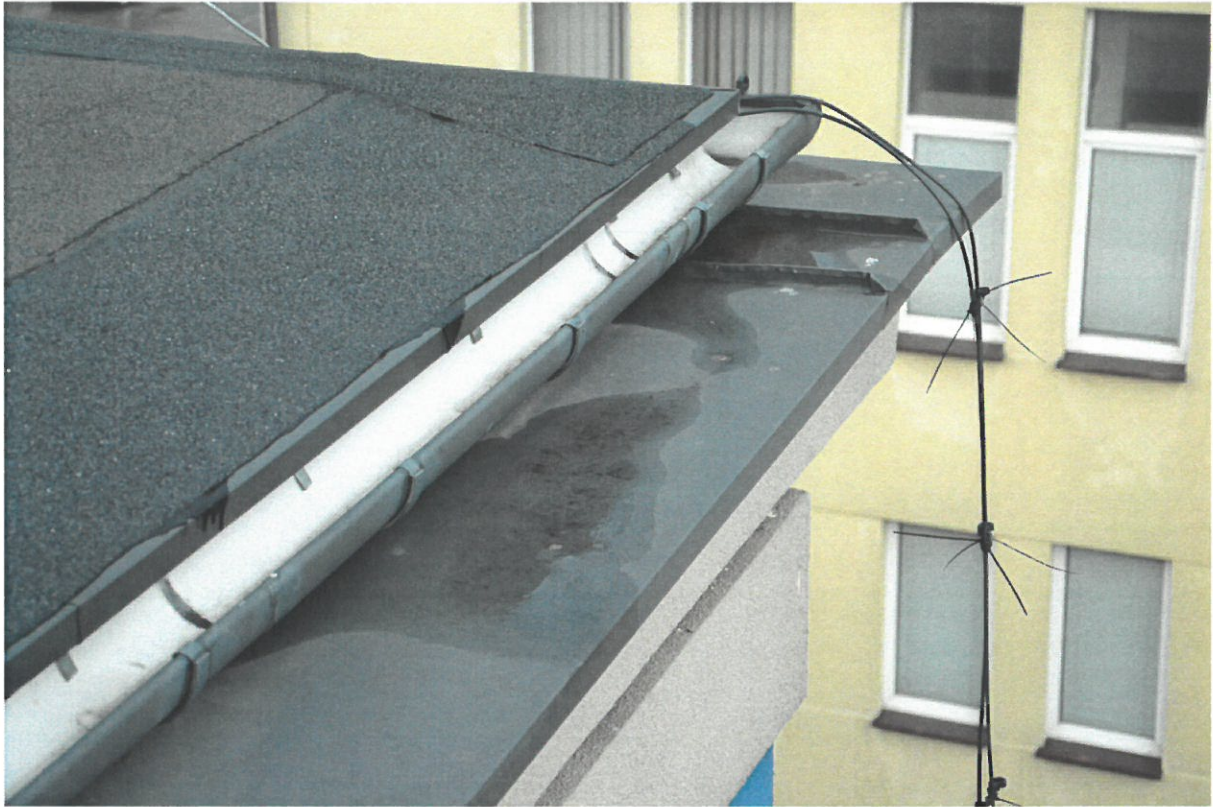
Zdj.14 Nieprawidłowo wy poziomowana obróbka nad gzymsem przyrynnowym-widoczna zalegająca woda
