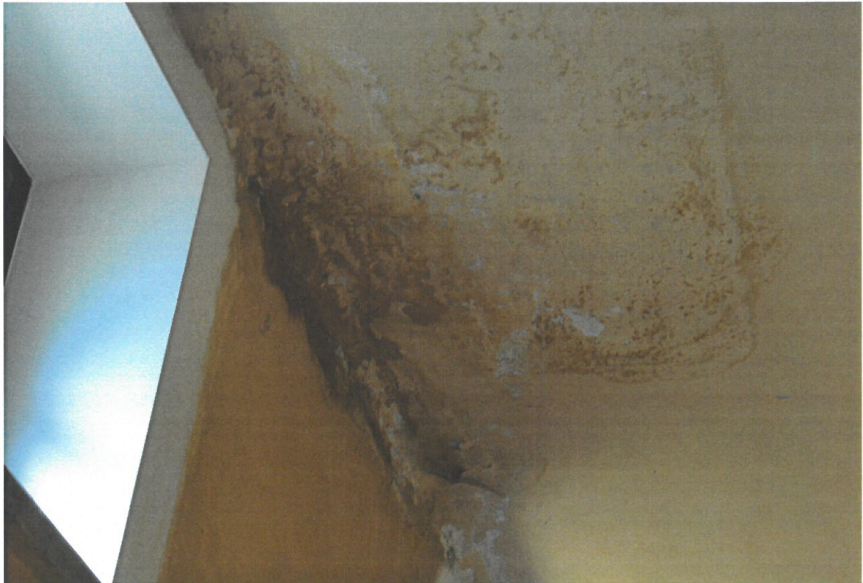
Zdj.3 To samo miejsce widziane od spodu sufitu – widoczne liczne ślady po zalaniach
