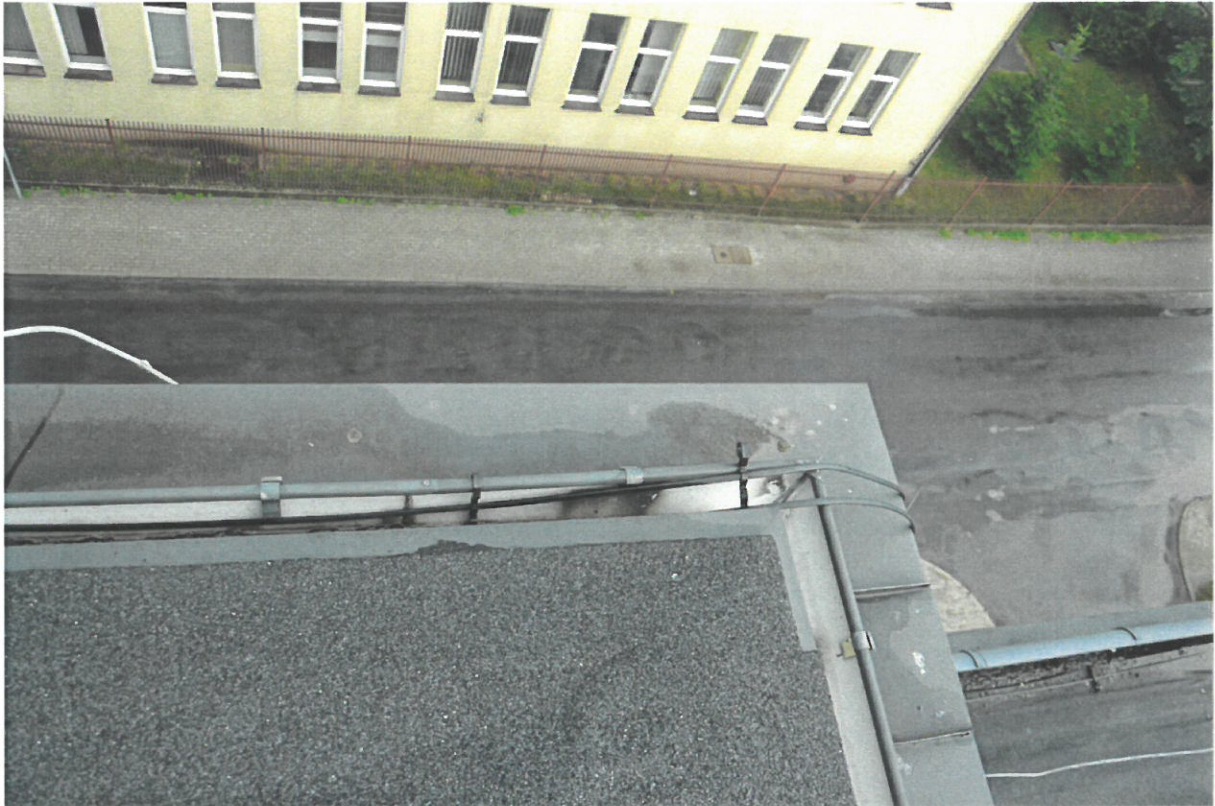
Zdj.16 Zalegająca woda na obróbkach przyrynnowych
