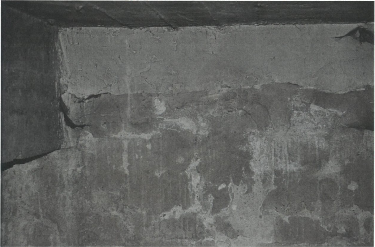
Zdj.26 Widoczne naloty na zawilgoconej ścianie przy okapie
