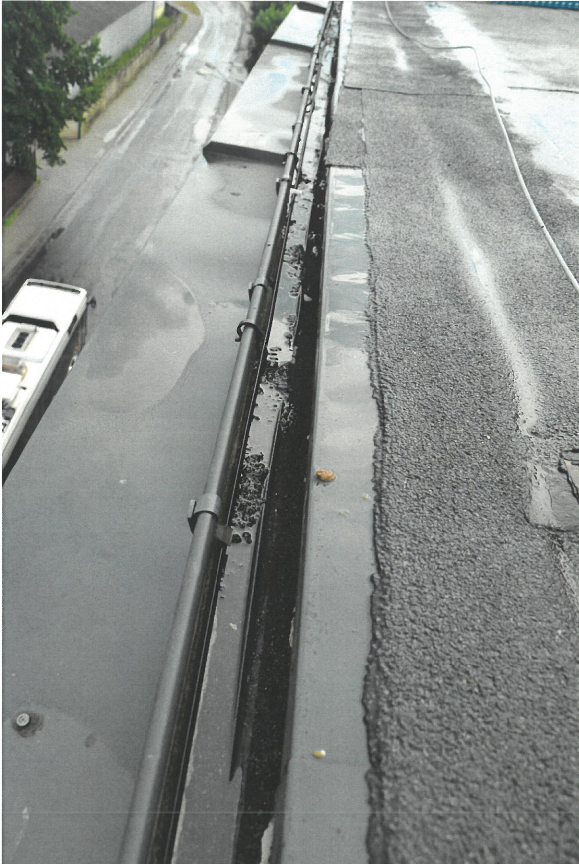
Zdj.11 Zalegająca woda w rynnach i nieprawidłowo wyprofilowanych obróbkach
