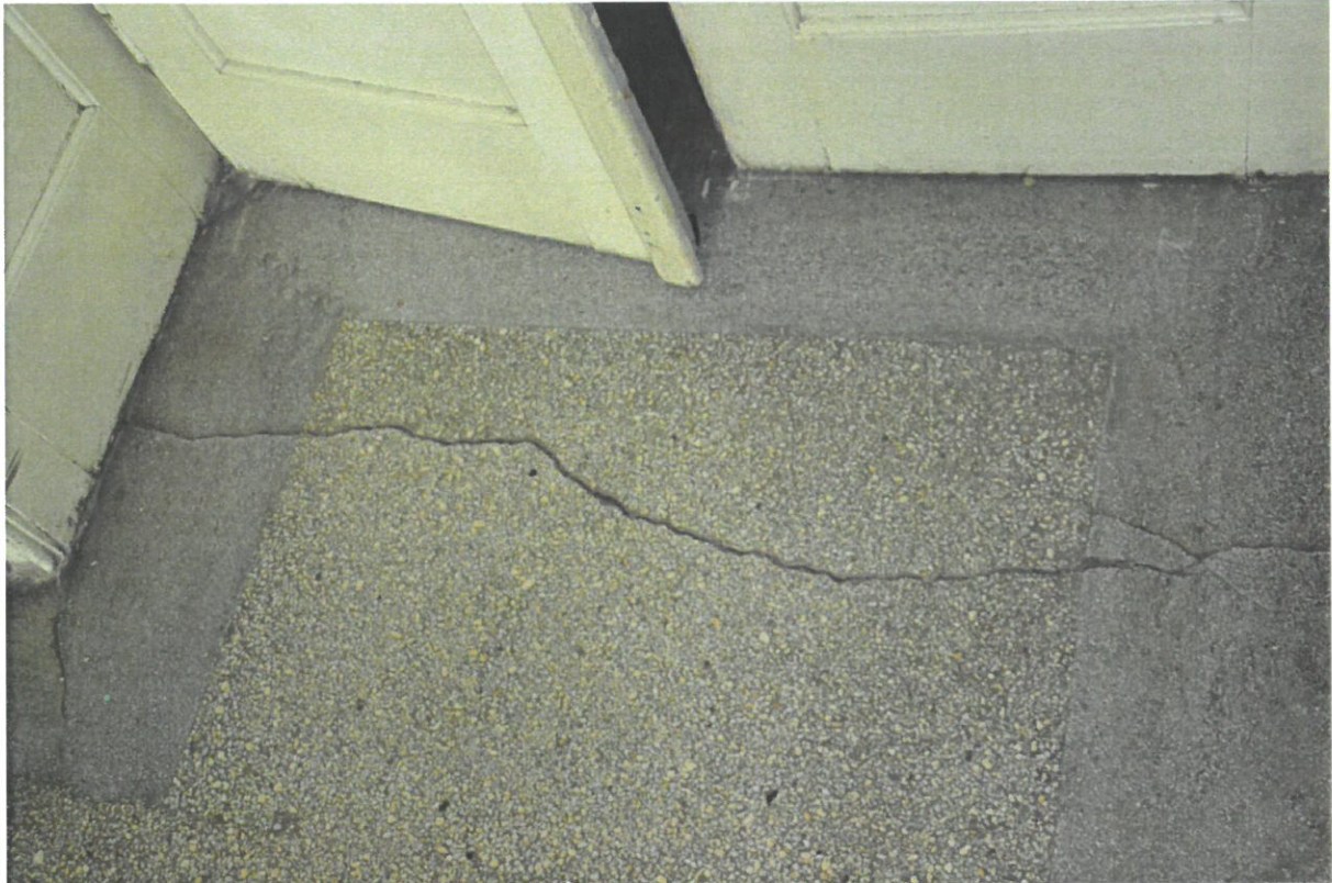
Zdj.5 Pęknięta posadzka lastriko przy wejściu do Sali kinowej od bocznej klatki schodowej
