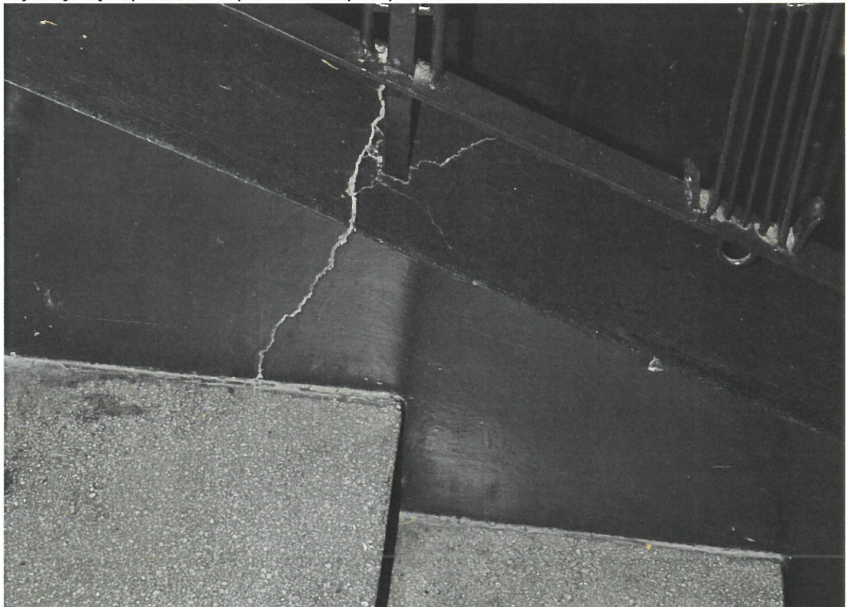
Zdj.10 Pęknięcia belek policyzkowych schodów głównych
