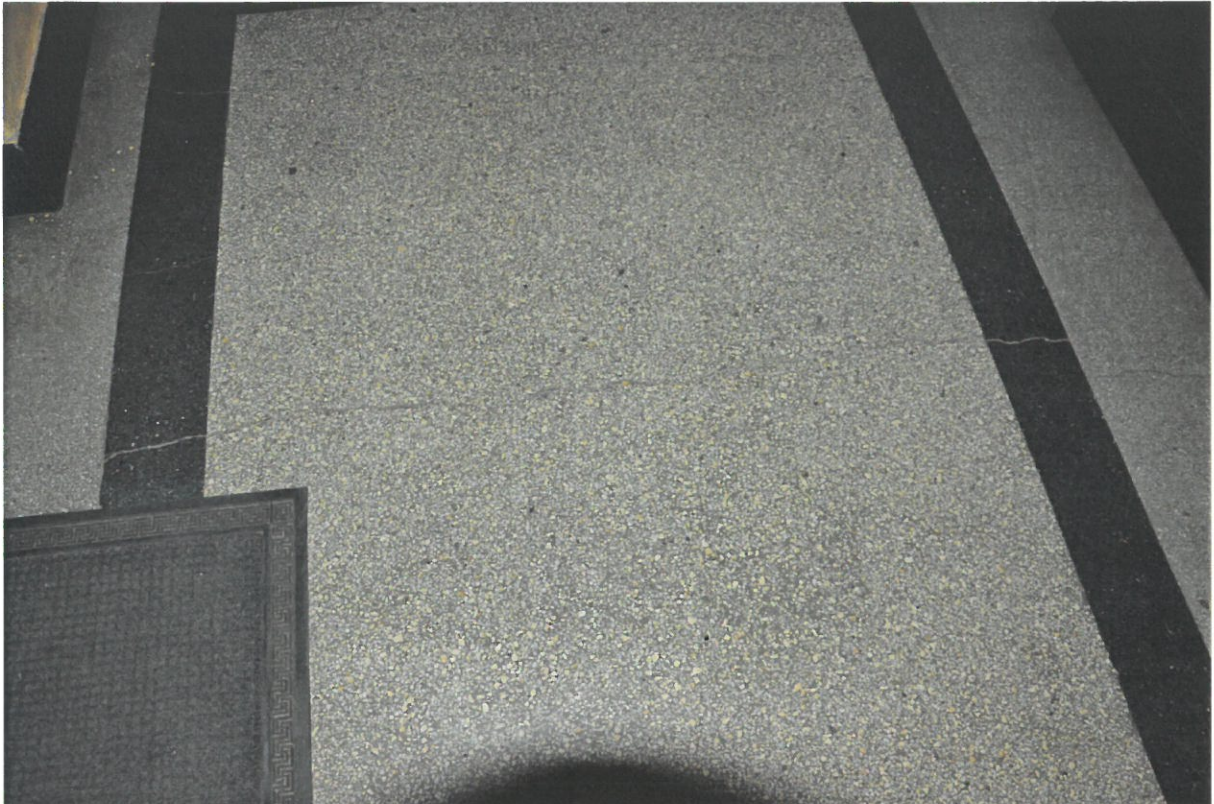
Zdj.9 Pęknięcia powierzchni posadzek korytarzy z lastriko
