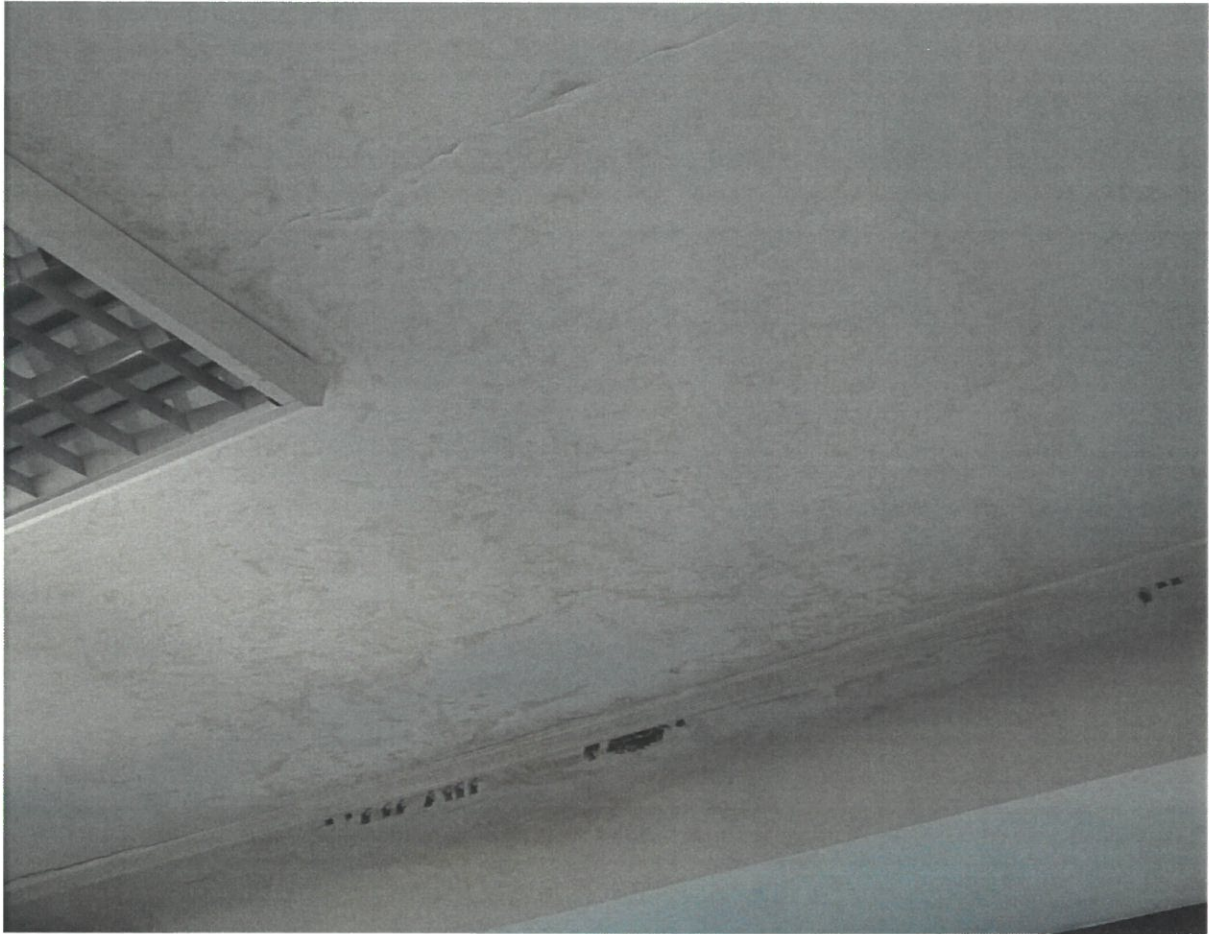
Zdj.27 Fragment zalanego sufitu w pomieszczeniach prób orkiestry
