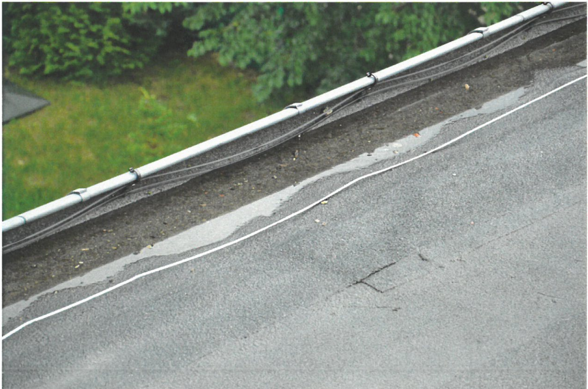
Zdj.15 Woda stojąca w rynnach – brak możliwości odpływu na skutek niewłaściwych spadków
