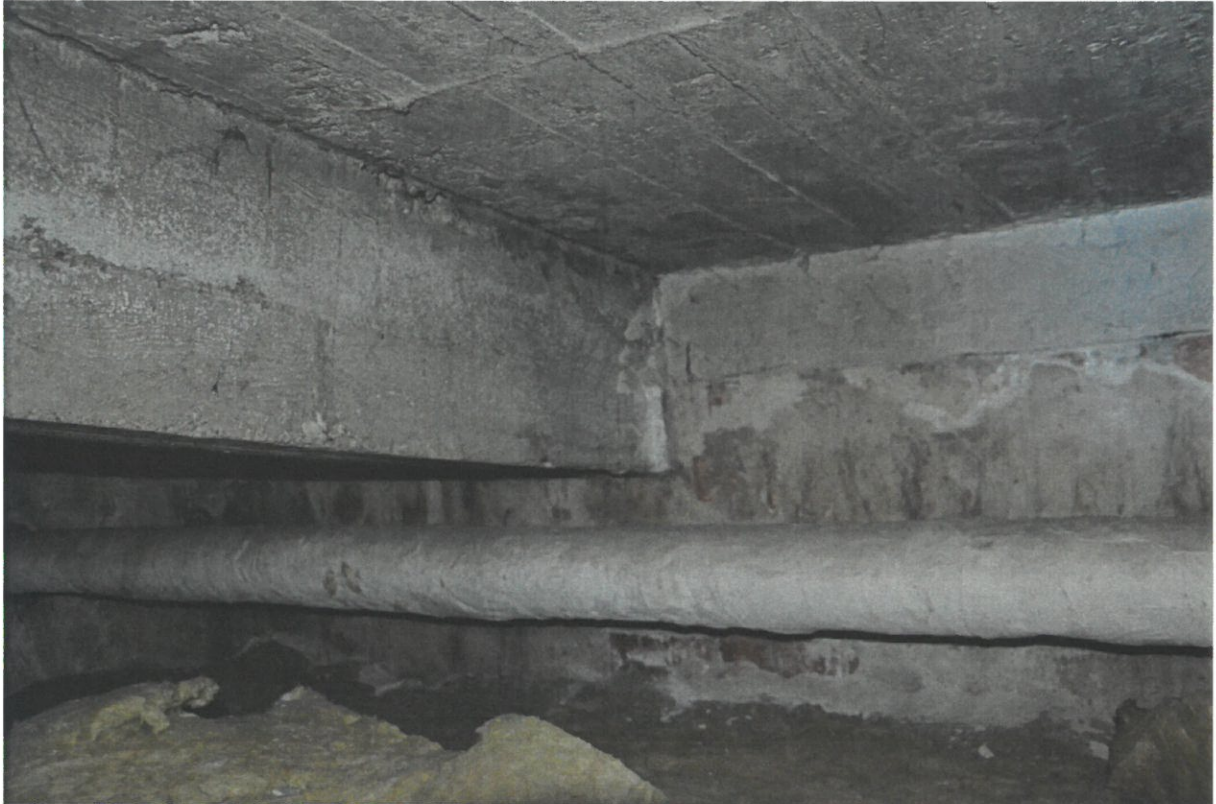
Zdj.23 Strych – widok na połączenie ściany ze stropodachem – widoczne liczne zacieki i ślady krystalizacji na ścianach poniżej żelbetowego wieńca.
