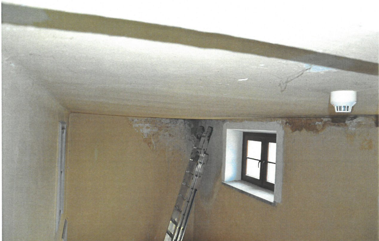
Zdj.1 Ugięty sufit podwieszany nad klatką schodową do mieszkań prywatnych
