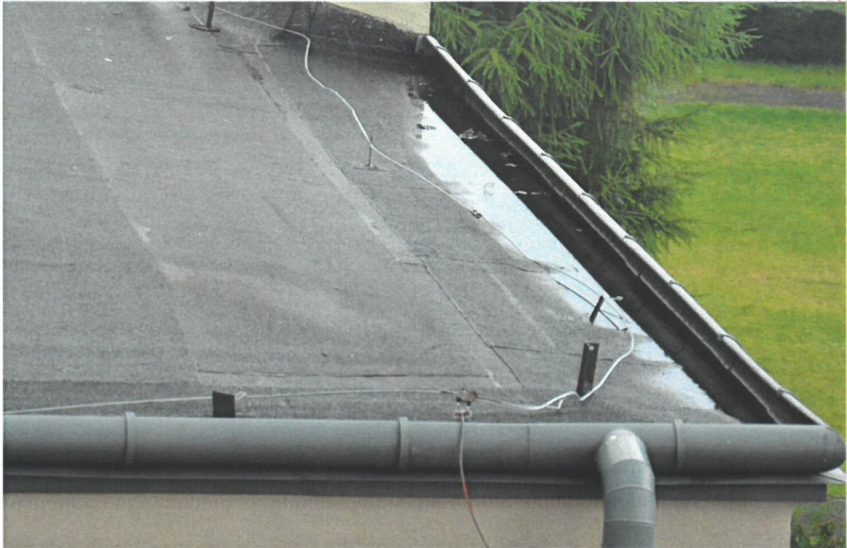
Zdj.12 Brak prawidłowych spadków rynien
