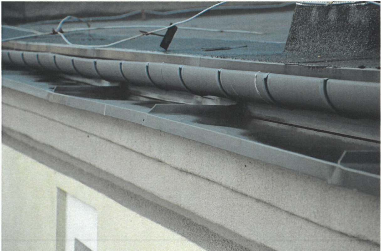
Zdj.17 Ewidentnie błędnie wykonane obróbki gzymsu – widoczna woda i korozja obróbek
