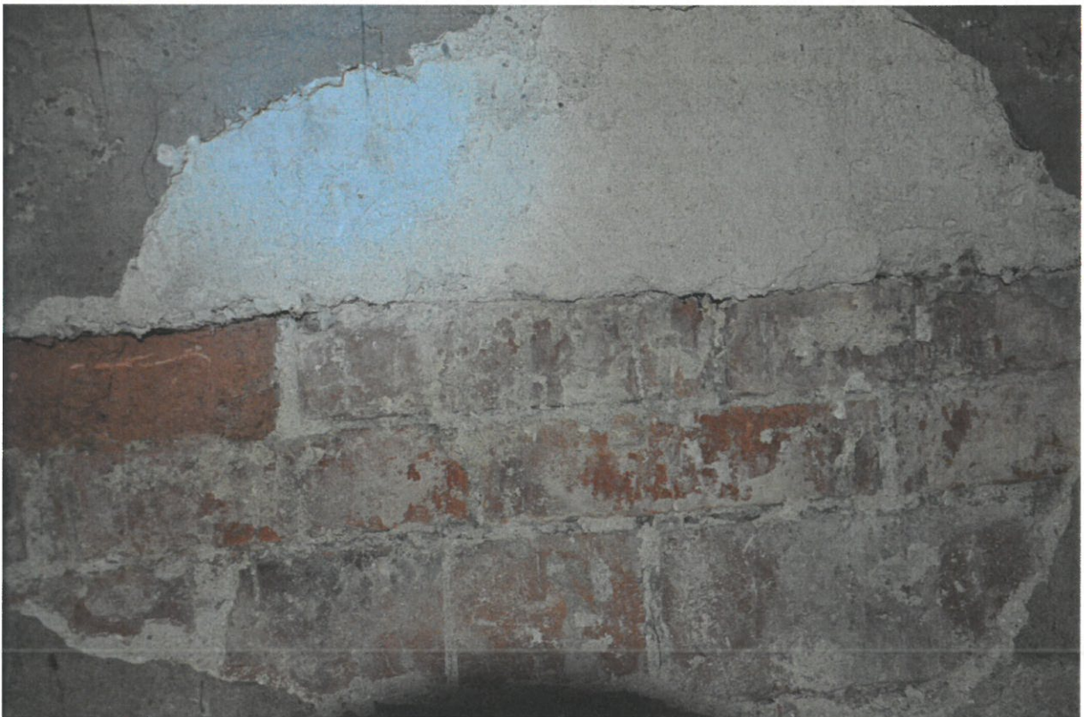
Zdj.24 To samo miejsce po skuciu napuchniętego tynku.
