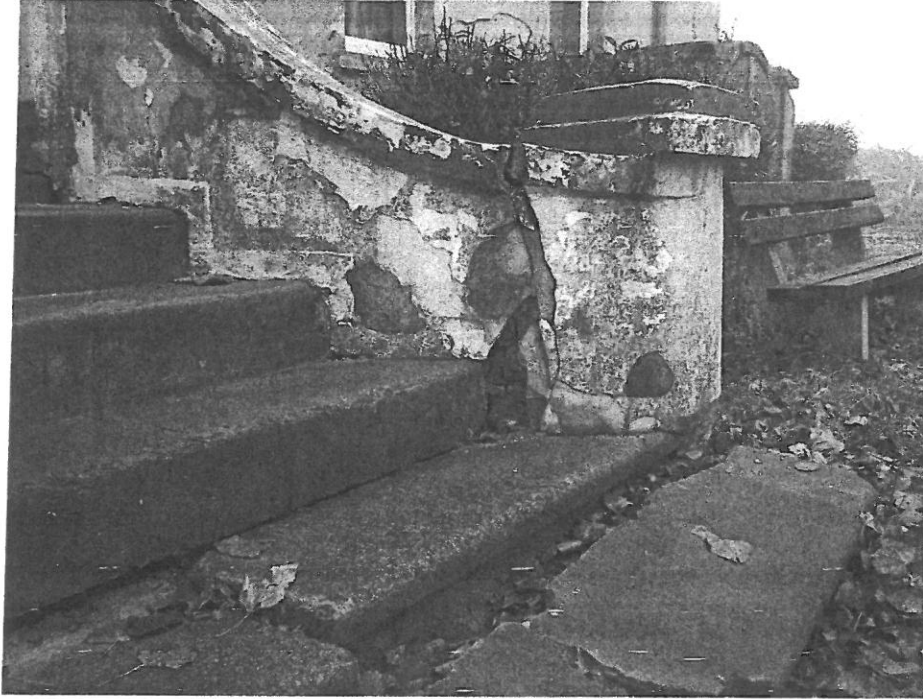
Fot. 7 Zniszczona balustrada schodów zewnętrznych.
