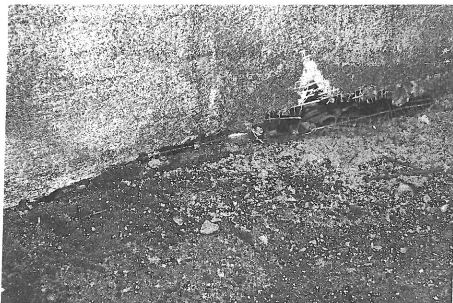
Fot. 12 Niedokładne wykonanie izolacji ściany południowej.
