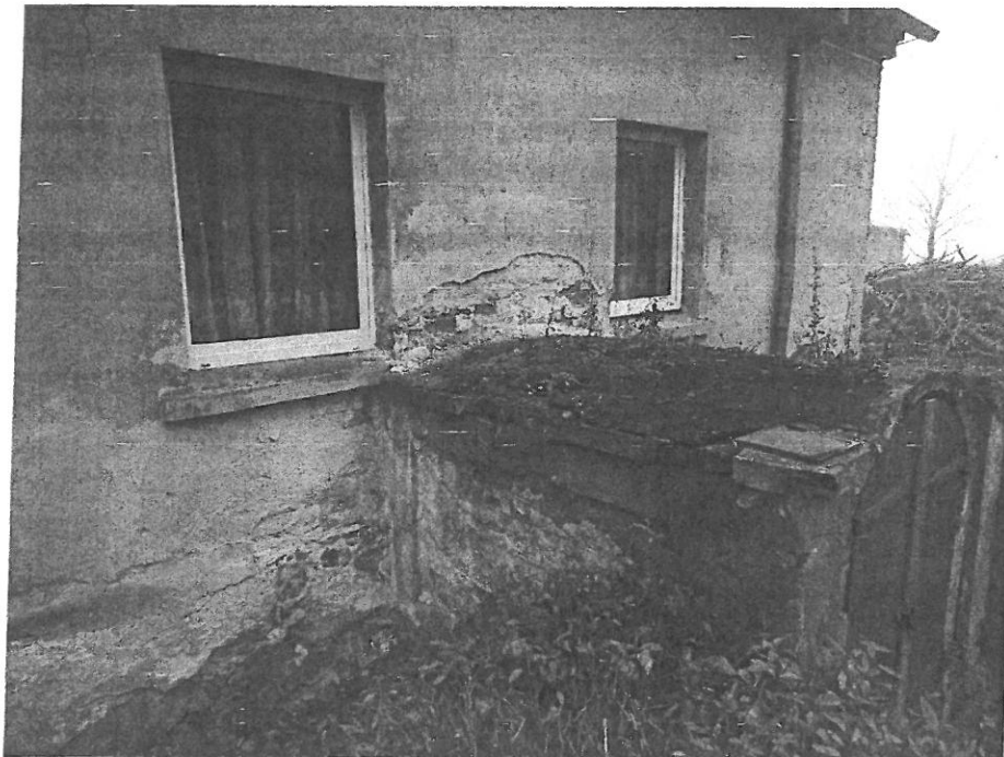
Fot. 8 Zniszczony dach nad zejściem do piwnicy.
