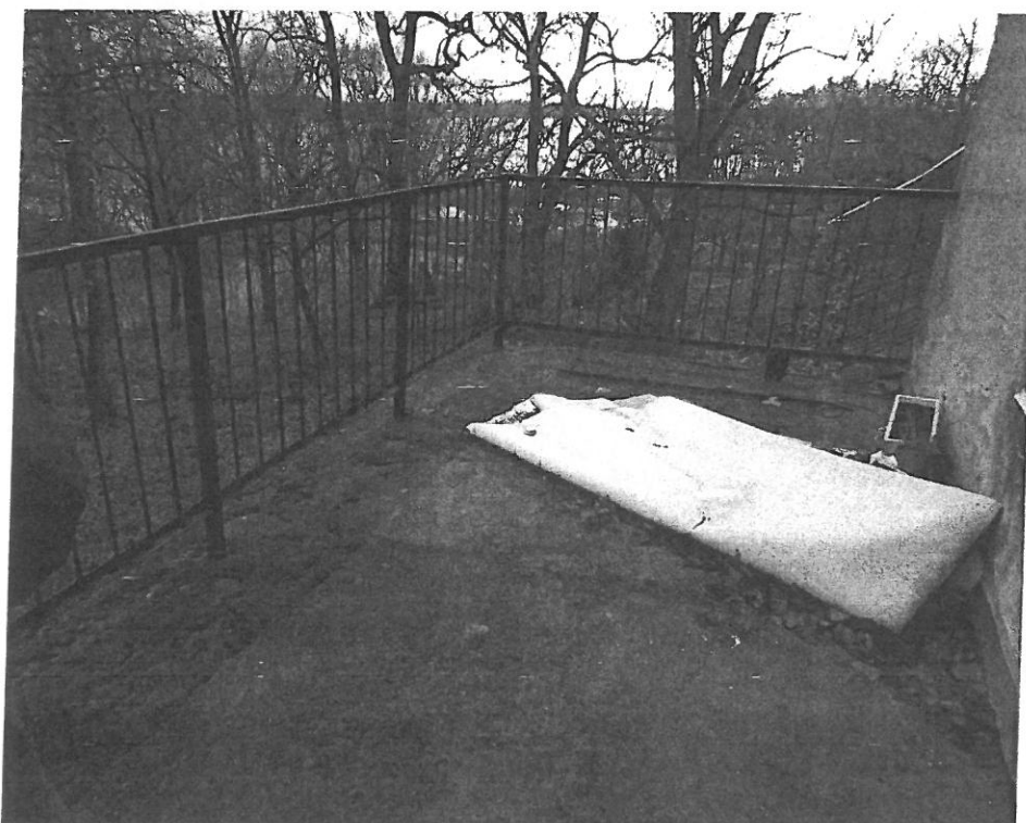
Fot. 10 Zaniehbana powierzchnia balkonu od strony wschodniej.
