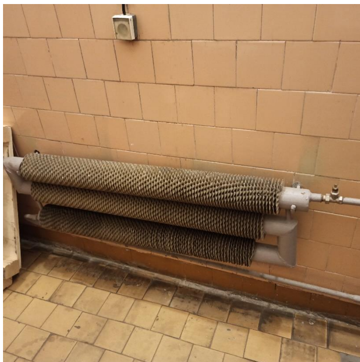
Fot.20 Łazienka – grzejnik Faviera, deformacja i zabrudzenia na płytkach; korozja i łuszcząca się farba na instalacji ciepłej
