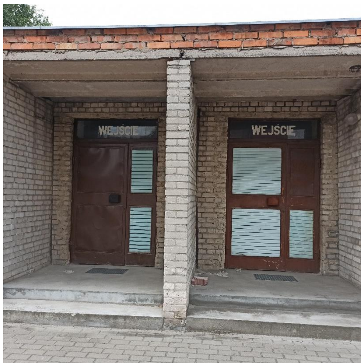
Fot. 8 Elewacja północna – zniszczona ślusarka drzwiowa (brak przeszklenia) i zawilgocone schody bet.
