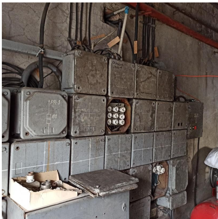
Fot.22 Wentylatornia – przestarzała instalacja elektryczna
