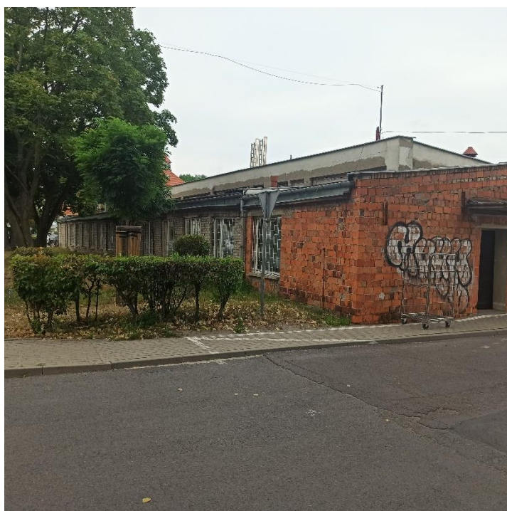
Fot. 1 Elewacja południowa – brak otynkowania na ścianach zewnętrznych i opaski betonowej
