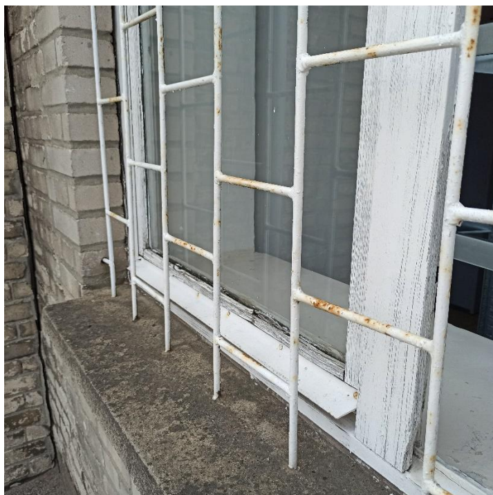
Fot.10 Elewacja północna – brak obróbki parapetów; wypaczone skrzydła, łuszcząca się farba i ubytki kitu w oknach drewnianych; korozja metalowych krat
