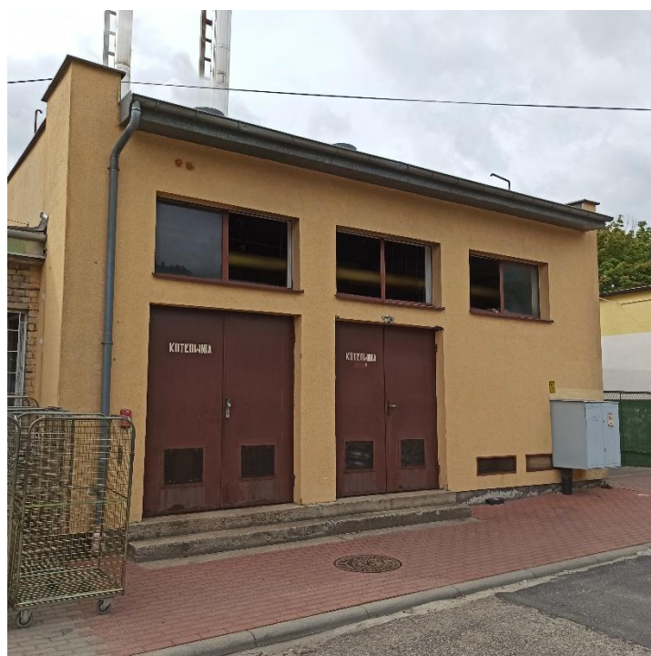
Fot. 11 Elewacja północna (kotłownia) – brak obróbki i ubytki w schodach betonowych oraz cokole
