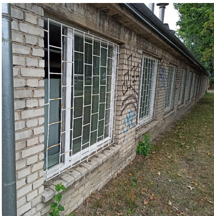
Fot. 15 Elewacja południowa – zawilgocenie, ubytki betonu i deformacja obróbki blacharskiej na gzymsie
