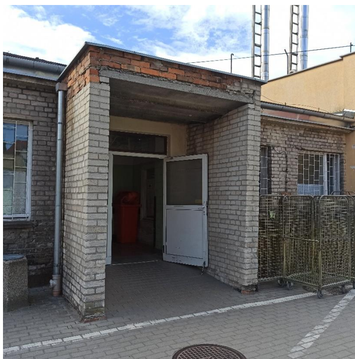
Fot. 9 Elewacja północna – brak wiązania pomiędzy ścianą i zadaszaniem wiatrołapu
