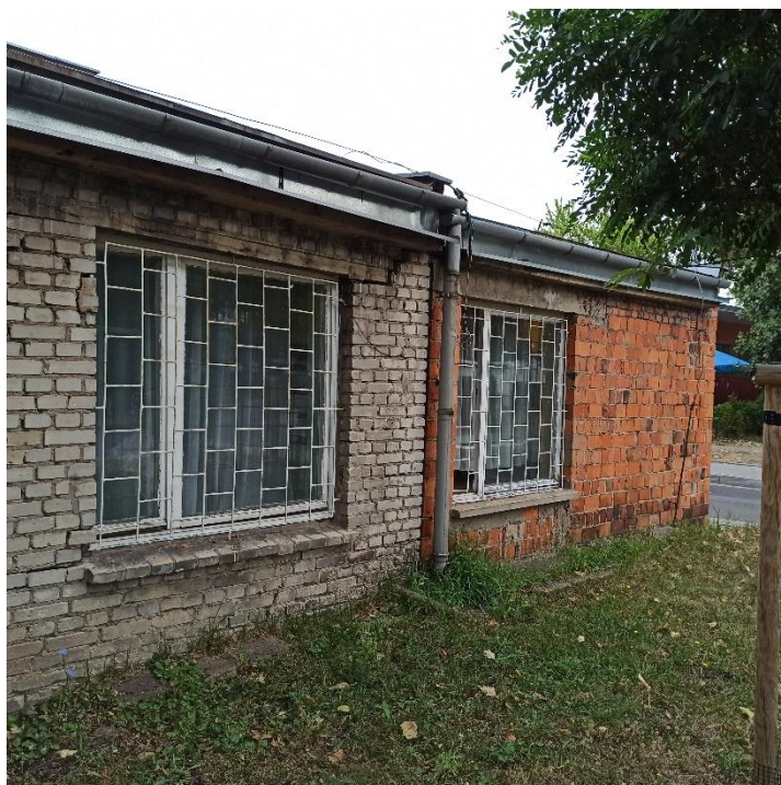
Fot.16 Elewacja południowa – zawilgocenie i pęknięcie części licowej ściany; 3cm dylatacja pomiędzy ścianami
