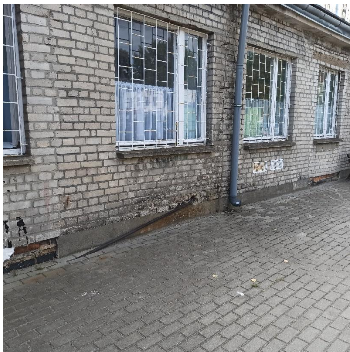
Fot. 6 Elewacja północna – niezabezpieczona instalacja przechodząca przez ścianę zew.
