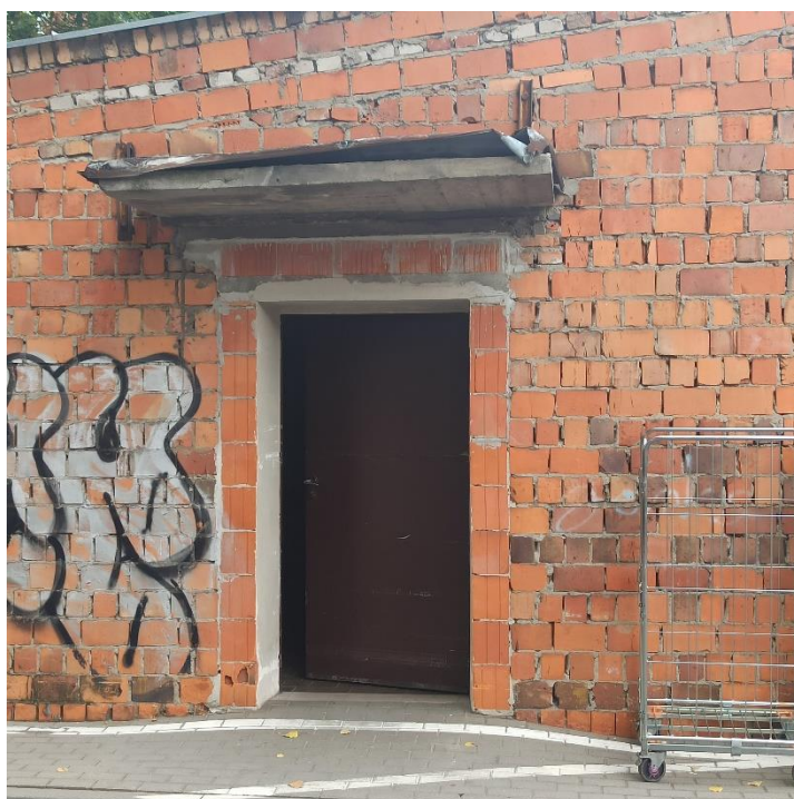
Fot. 3 Elewacja wschodnia – korozja i wygięcie obróbki blacharskiej betonowego daszku nad wejściem
