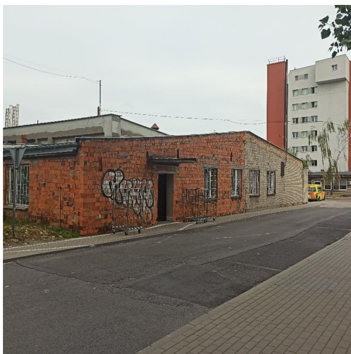
Fot. 2 Elewacja wschodnia – brak tynku zewnętrznego, zawilgocenie
