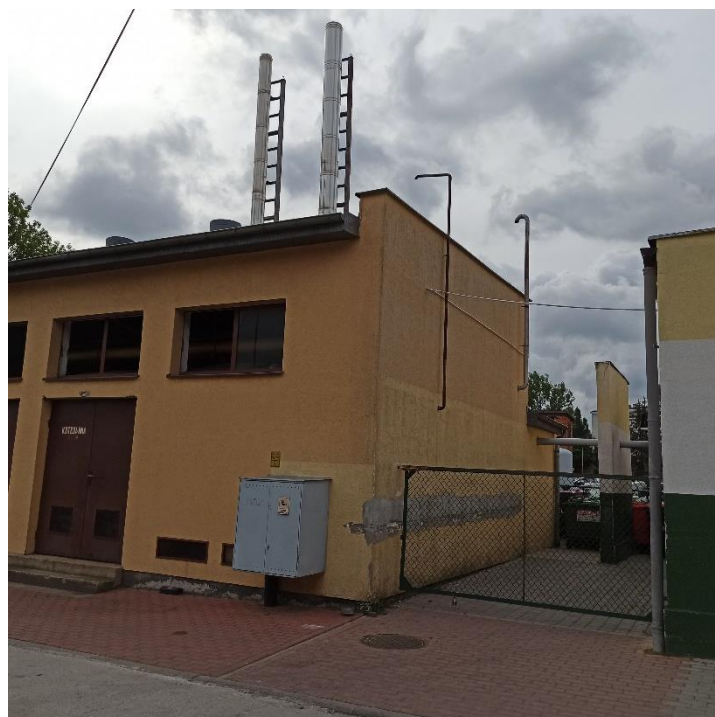
Fot.12 Widok na kotłownię – niewłaściwe uzupełnienie i ubytki w tynku zewnętrznym
