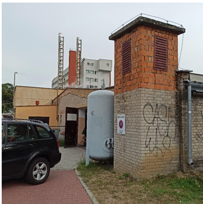
Fot.14 Elewacja zachodnia – zawilgocona ściana, zardzewiałe kratki wentylacyjne i inst. odgromowa
