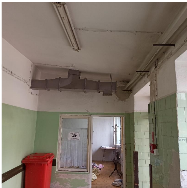
Fot.18 Śluza – popękana i brakująca okładzina z płytek ściennych
