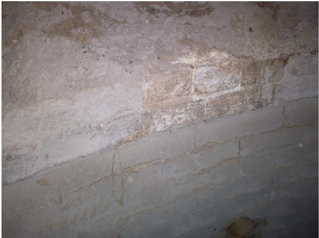
Fot. 50. Dylatacja +42 m spoiny od zewnątrz kruche, ubytki 1÷5 mm (ca 15% powierzchni)
