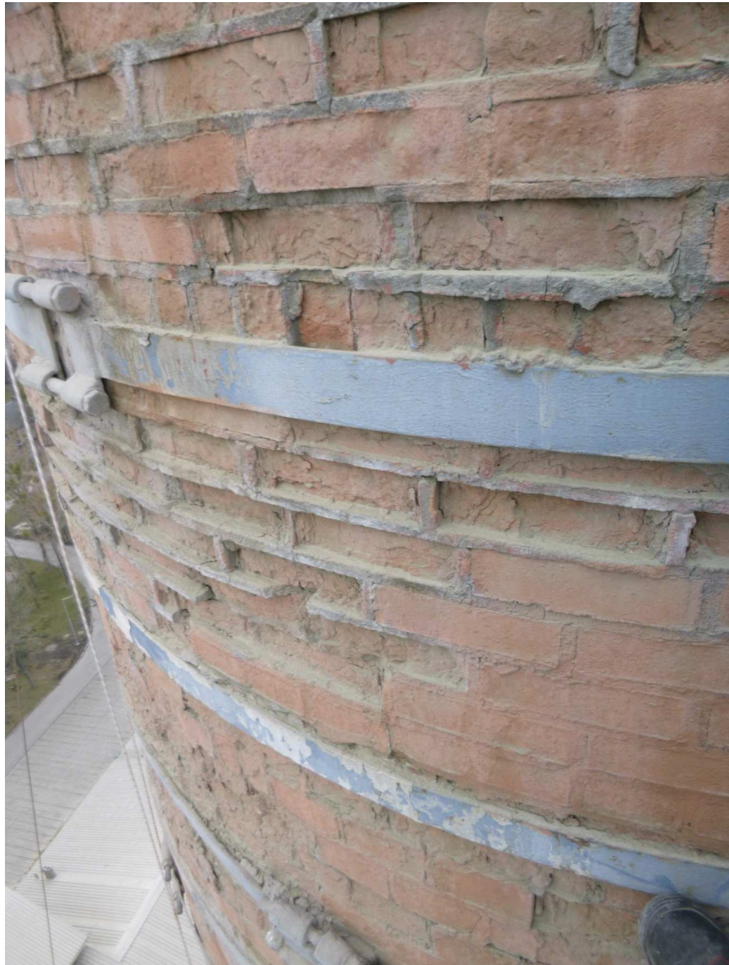
Fot. 17. Degradacja lic cegieł na szczytowym odcinku trzonu – ubytki do 4 cm
