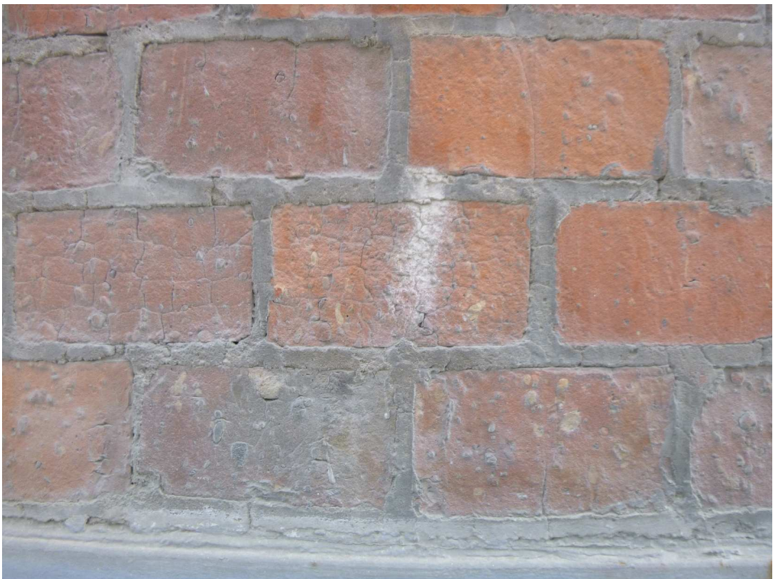
Fot. 34. Lica cegieł porysowane
