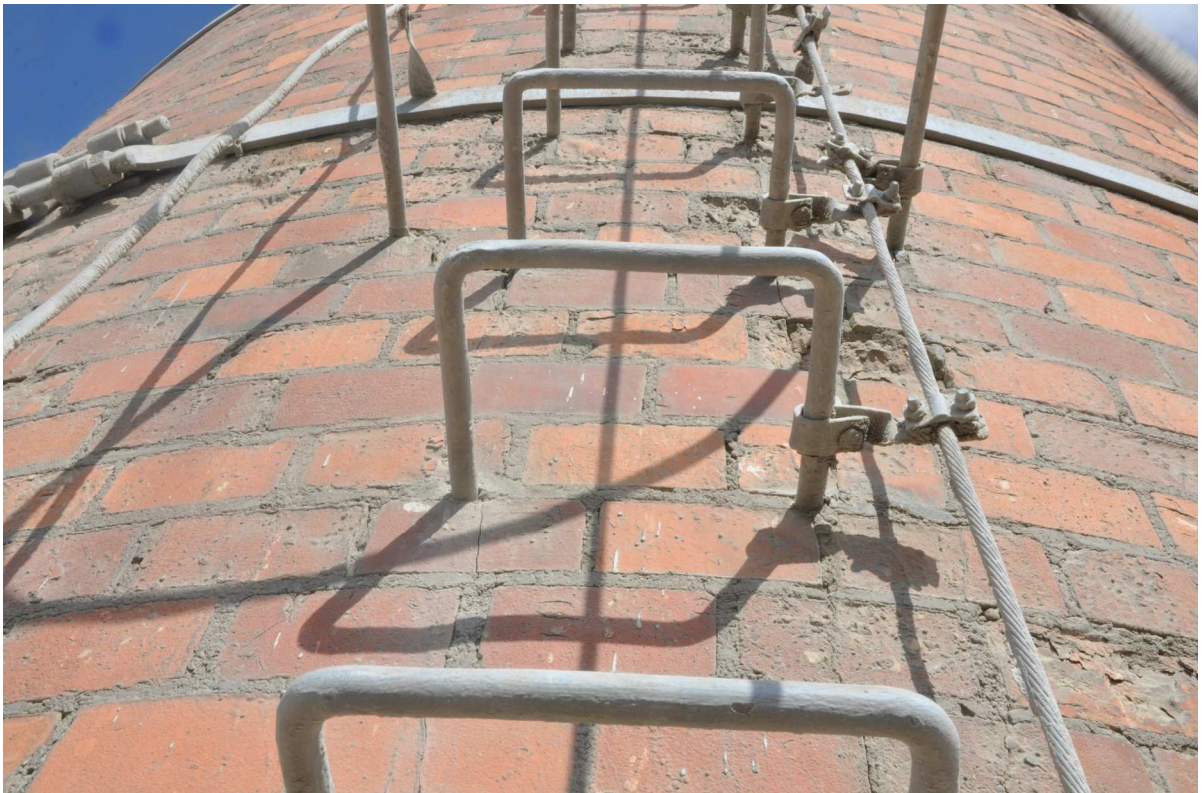
Fot. 67. Dobry stan szczelbi włazowych
