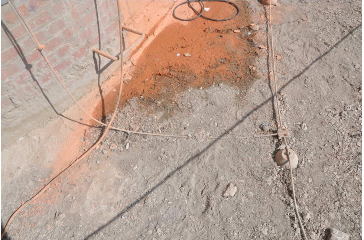
Fot. 72. Uziemienie - zbyt mały przekrój
