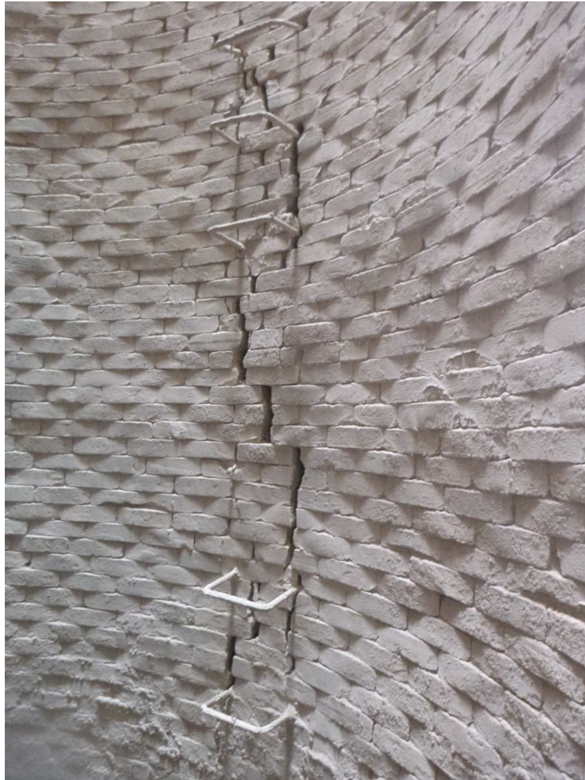
Fot. 47. Pęknięcia wykładziny (poz. +43÷48 m)
