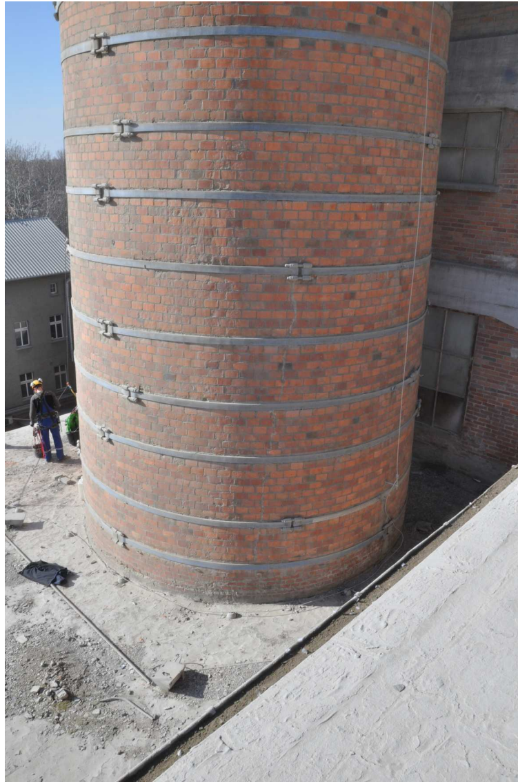
Fot. 5. Trzon komina ponad dachem hali – widoczne pęknięcia (naprawiane)
