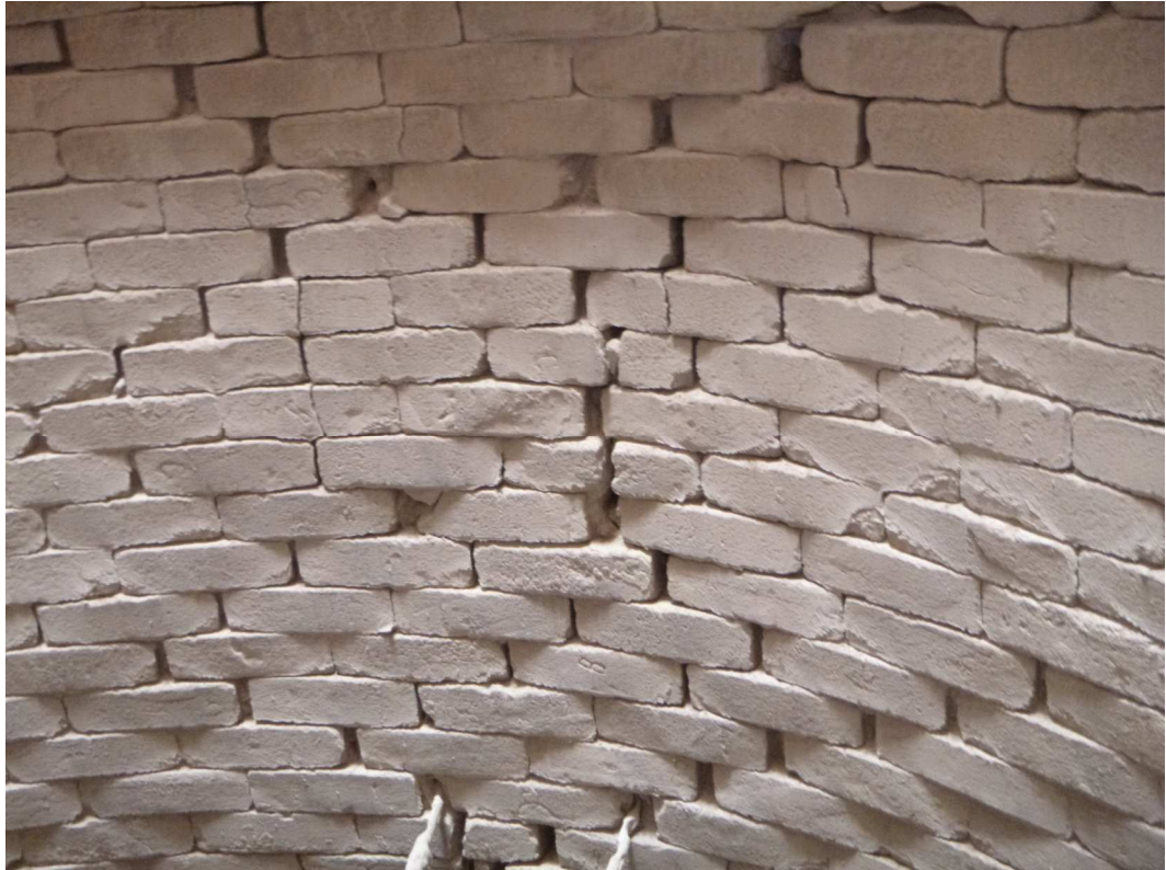
Fot. 49. Pęknięcia i przemieszczenia wykładziny, liczne uszkodzenia cegieł (Poz. ca+47 m)
