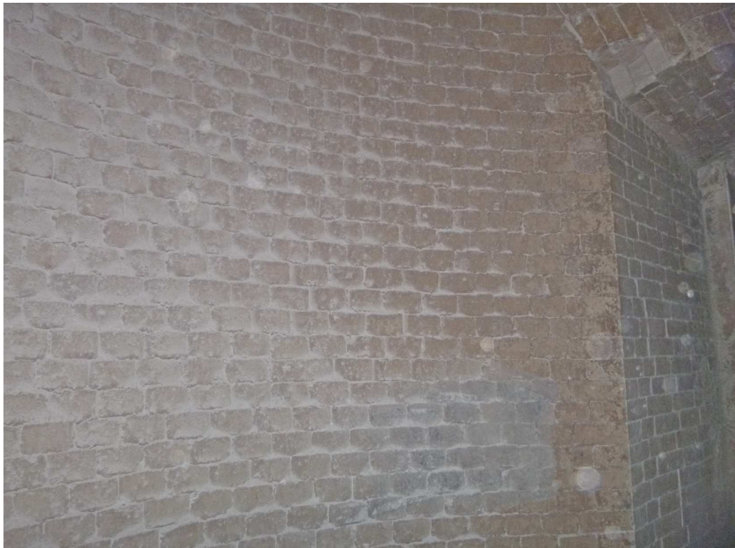
Fot. 60. Okolice wlotu czopuchowego - stan muru zadowolający, pęknięcia po bokach
