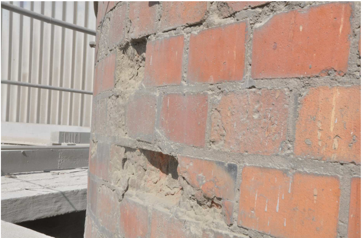
Fot. 36. Głębokie ubytki lic cegieł
