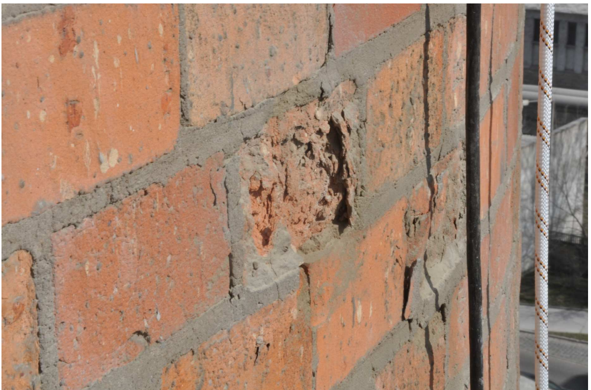
Fot. 32. Złuszczenia warstwowe lica cegieł
