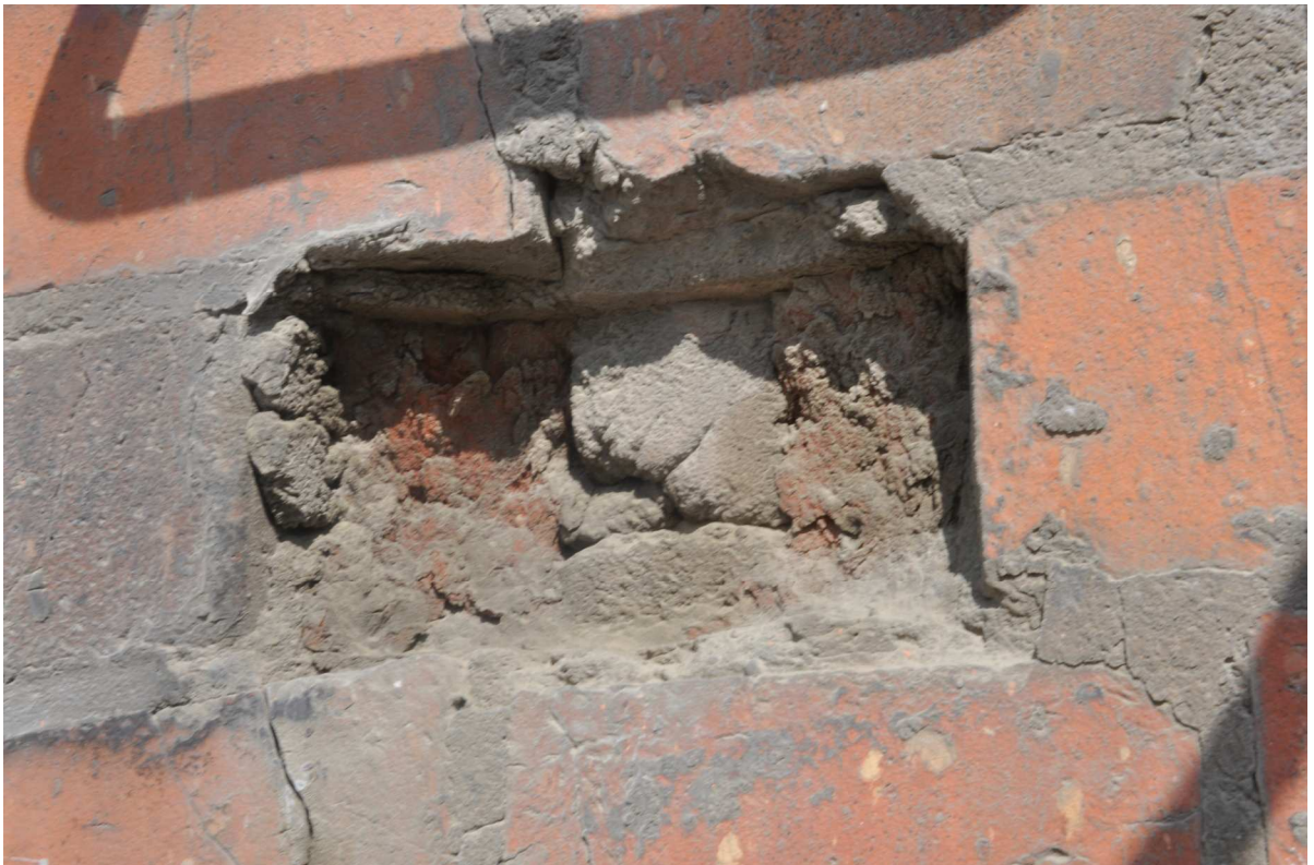
Fot. 30. Ubytki lica niektórych cegieł o głębokościach 2÷4 cm
