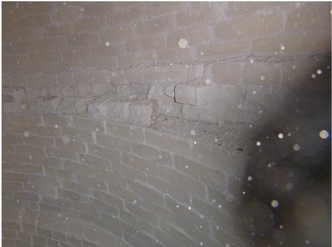
Fot. 58. Dylatacja poz. +15 m - liczne ubytki cegieł kapinosowych na całym obwodzie
