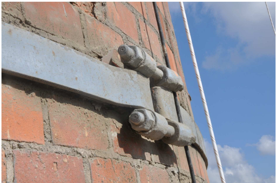
Fot. 65. Dość dobry stan obręczy, nieznaczna korozja
