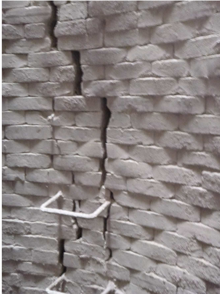
Fot. 48. Pęknięcia wykładziny (poz. +43÷48 m), rozwartość do 4 cm
