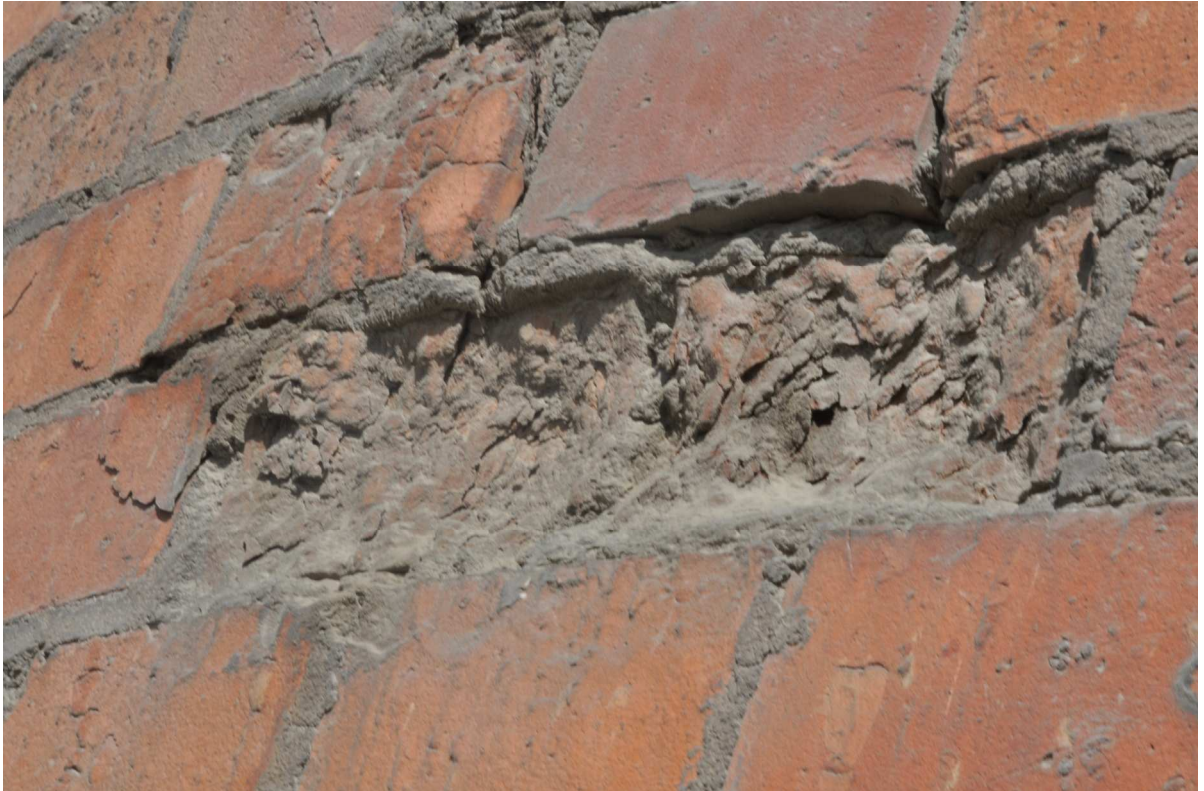
Fot. 29. Degradacja cegieł w trzonie komina
