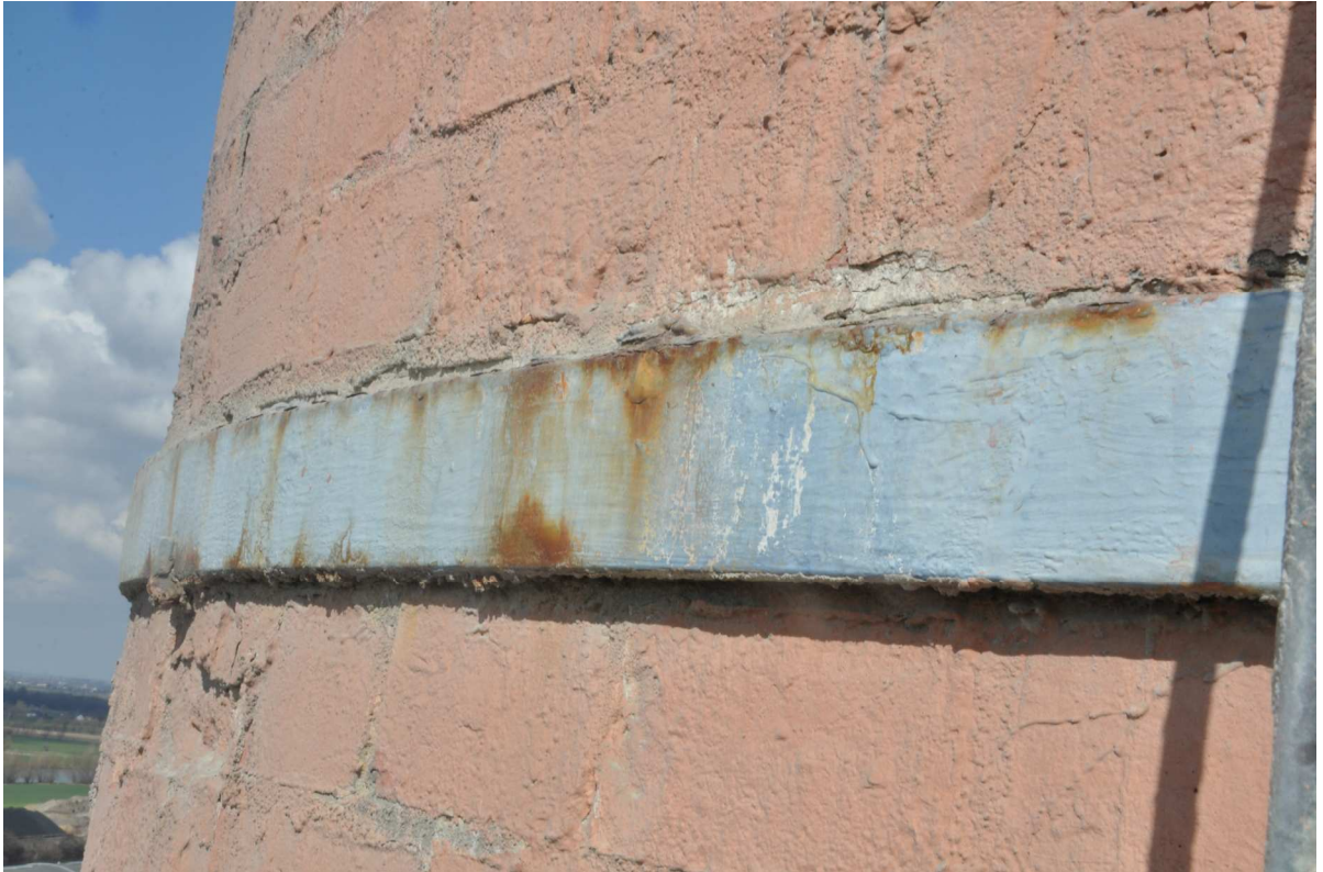
Fot. 66. Miejscowa korozja obreczy
