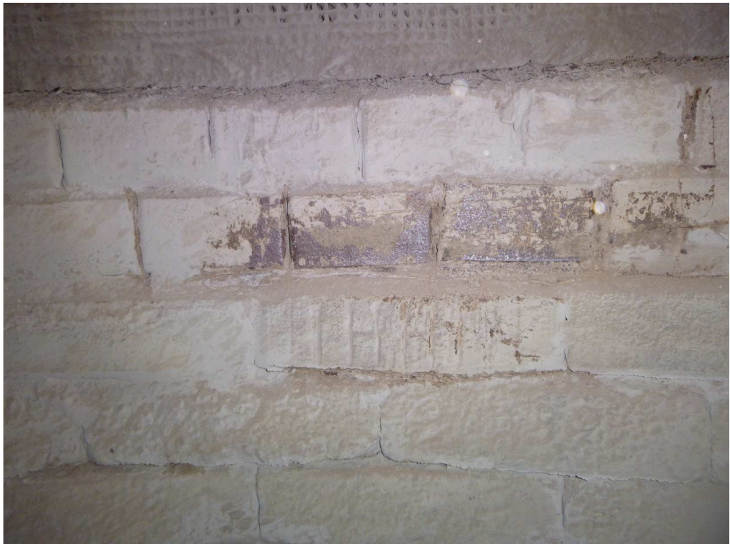
Fot. 45. Dylatacja poz. +51 m, ubytek spoin, lico cegieł twarde
