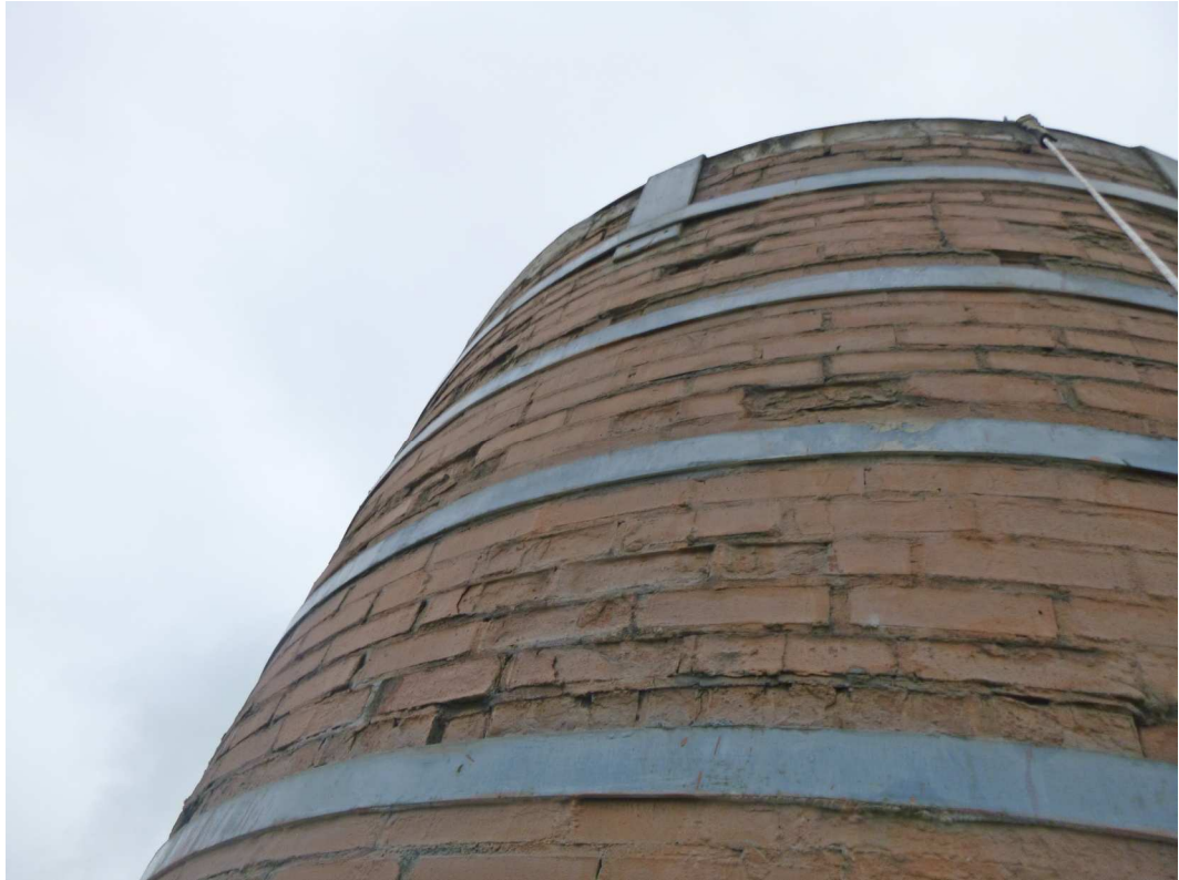
Fot. 15. Szczytowa część trzonu ceramicznego – uszkodzenia korozyjne cegieł
