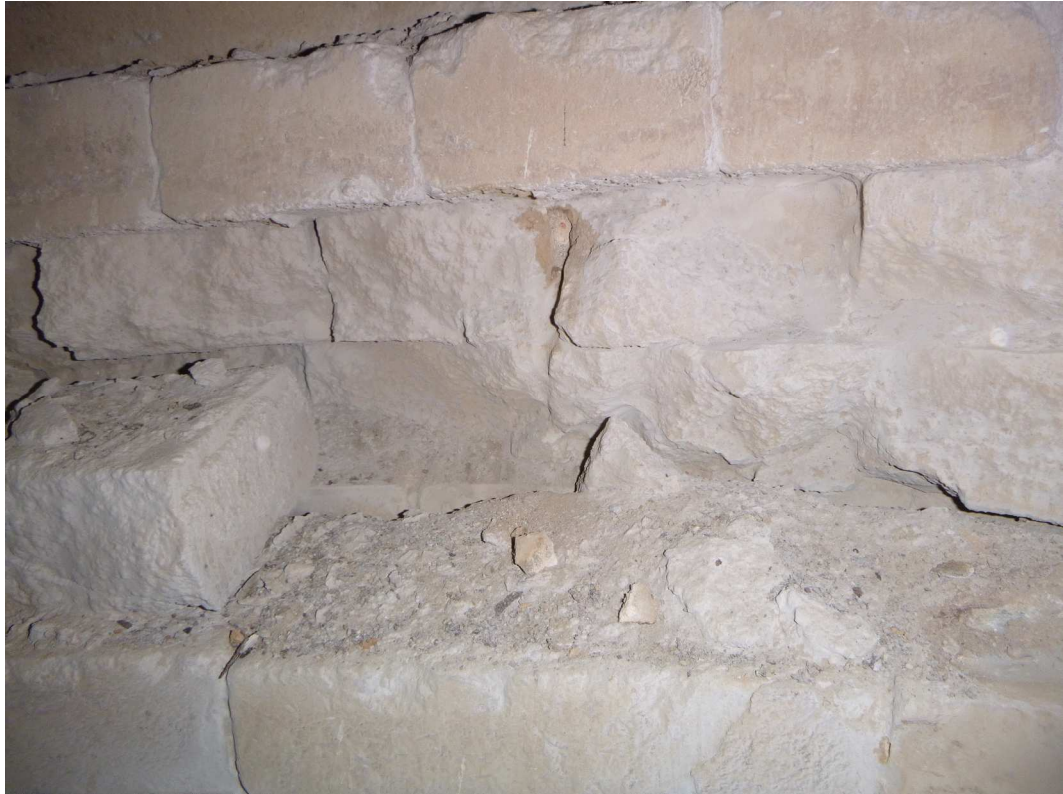
Fot. 59. Dylatacja poz. +15 m - liczne ubytki cegieł kapinosowych na całym obwodzie
