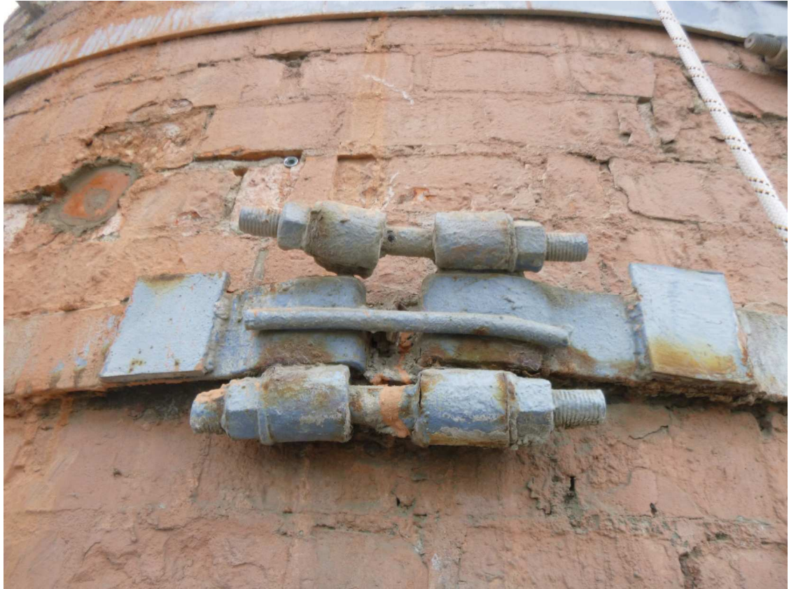
Fot. 64. Uszkodzenie zamka obręczy wzmacniającej na poz. +54,7 m
