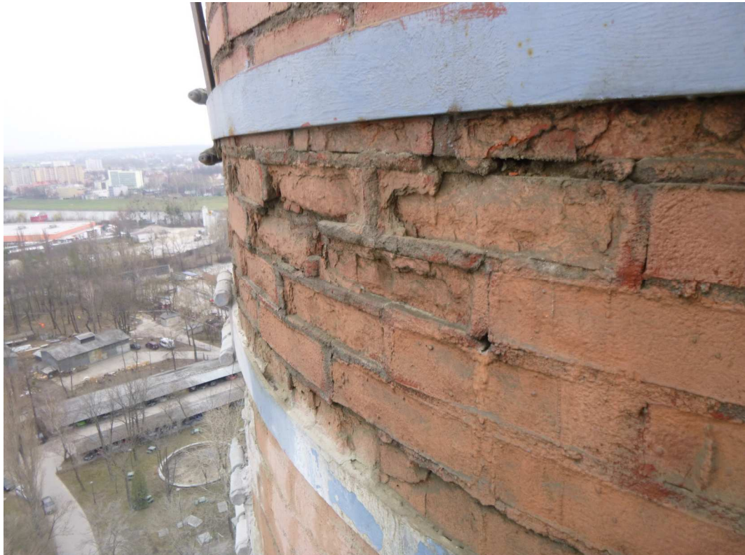
Fot. 18. Silna degradacja lic cegieł w górnej części komina
