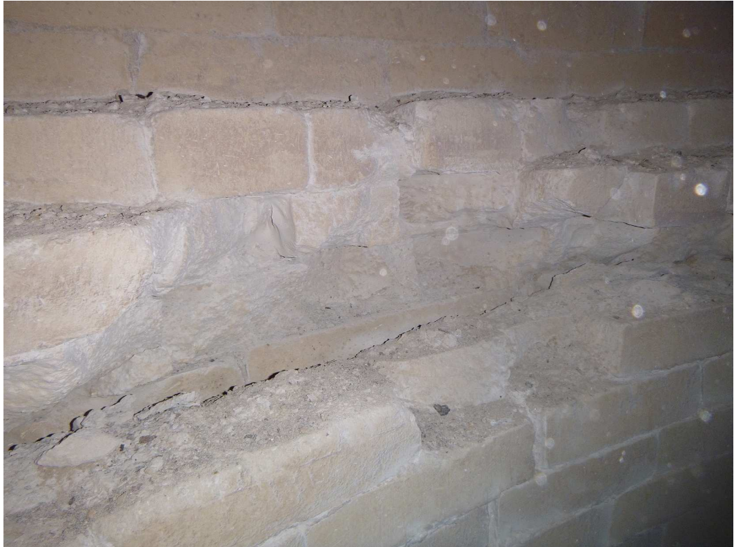
Fot. 57. Dylatacja poz. +24 m - ubytki cegieł kapinosowych na całym obwodzie
