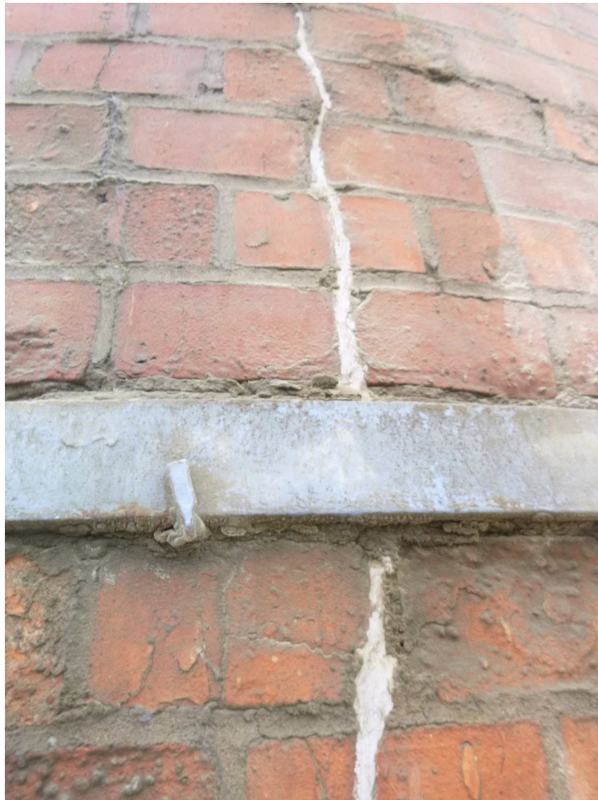
Fot. 38. Pęknięcia pionowe naprawiane kitem elastycznym
