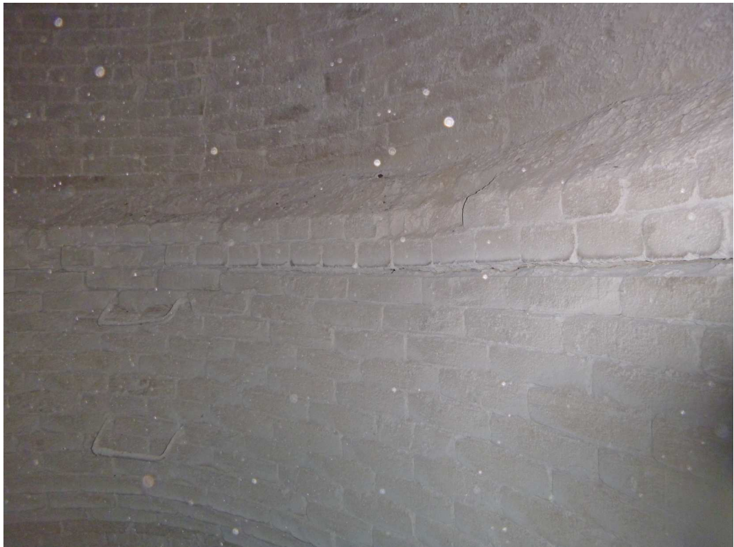
Fot. 54. J.w. - drobne rysy pionowe, miejscowe ubytki cegieł
