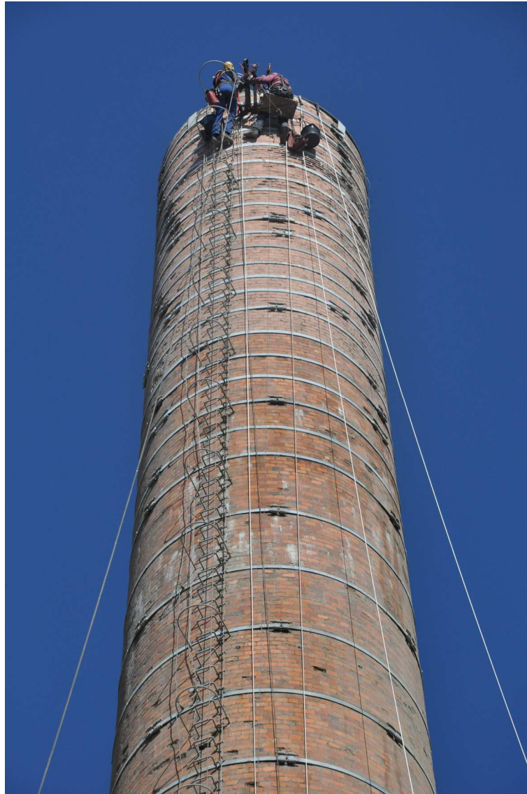
Fot. 3. Część szczytowa komina – liczne uszkodzenia i wycieki
