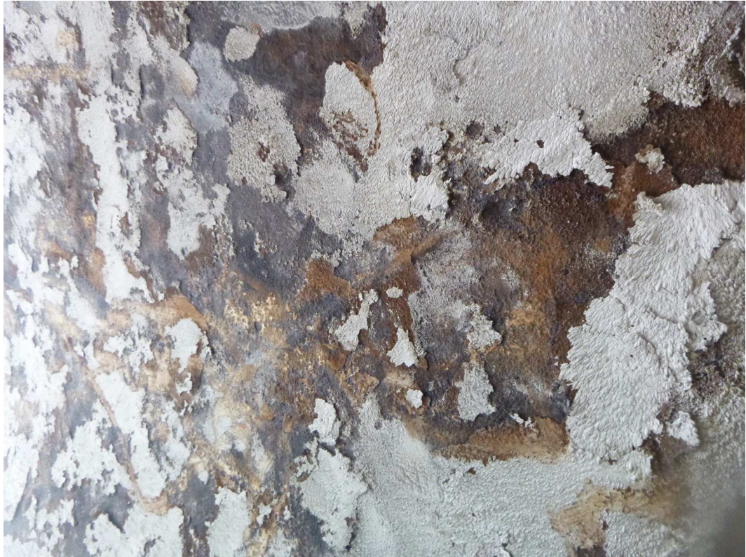
Fot. 11. Powierzchnia wewnętrzna zwężki – korozja powierzchniowa
