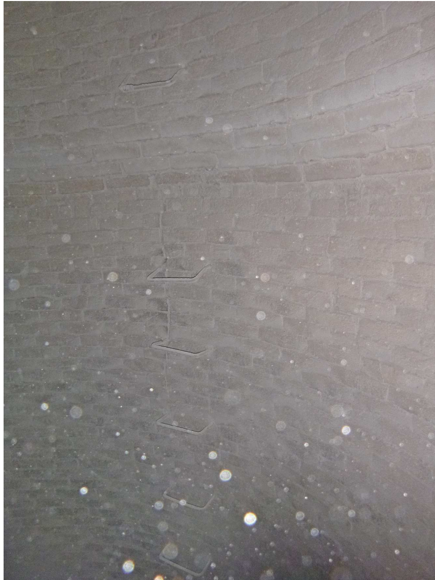
Fot. 56. Pionowe rysy pod dylatacją na poz. +33 m
