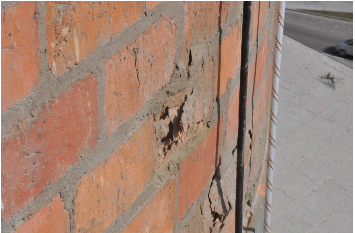
Fot. 31. Złuszczenie lica cegieł jako efekt procesów korozyjnych wywołanych przepływem wilgoci
