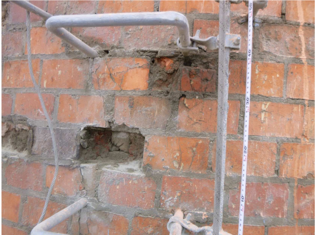
Fot. 35. Głębokie ubytki lic cegieł
