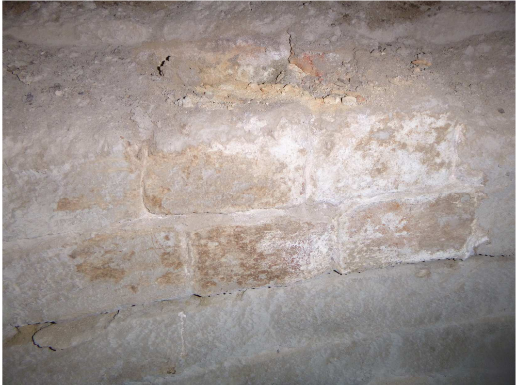
Fot. 53. Dylatacja +33 m - spoina krucha z ubytkami do kilku mm
