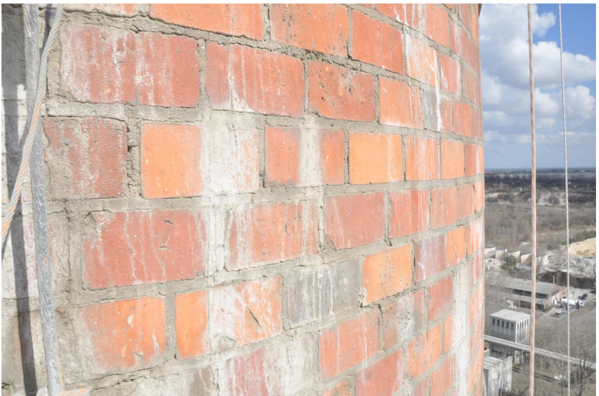
Fot. 24. Efekty przecieków przez trzon kominia
