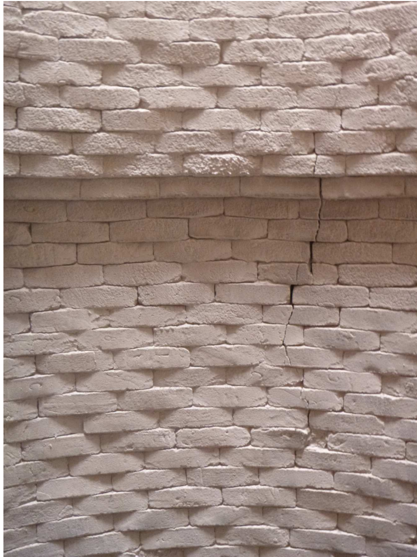
Fot. 46. Pęknięcie wykładziny na poz. +49÷50 m
