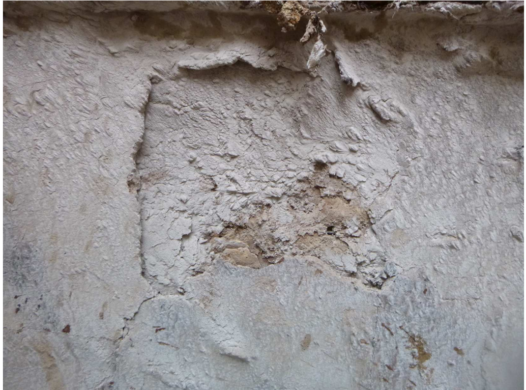
Fot. 40. Odspojenie i ubytek szpachli naprawczej od wewnątrz (poz. +60 m)
