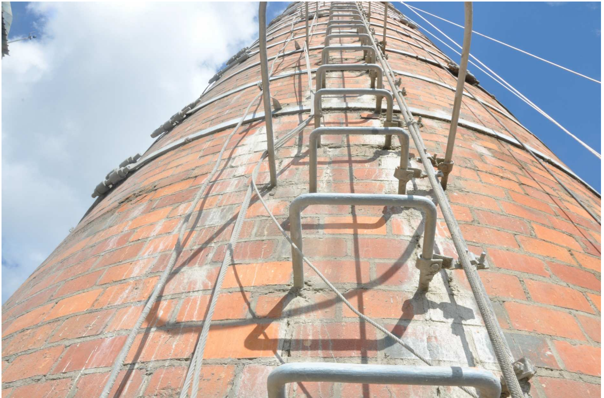
Fot. 23. Wycieki z wykrystalizowanymi osadami
