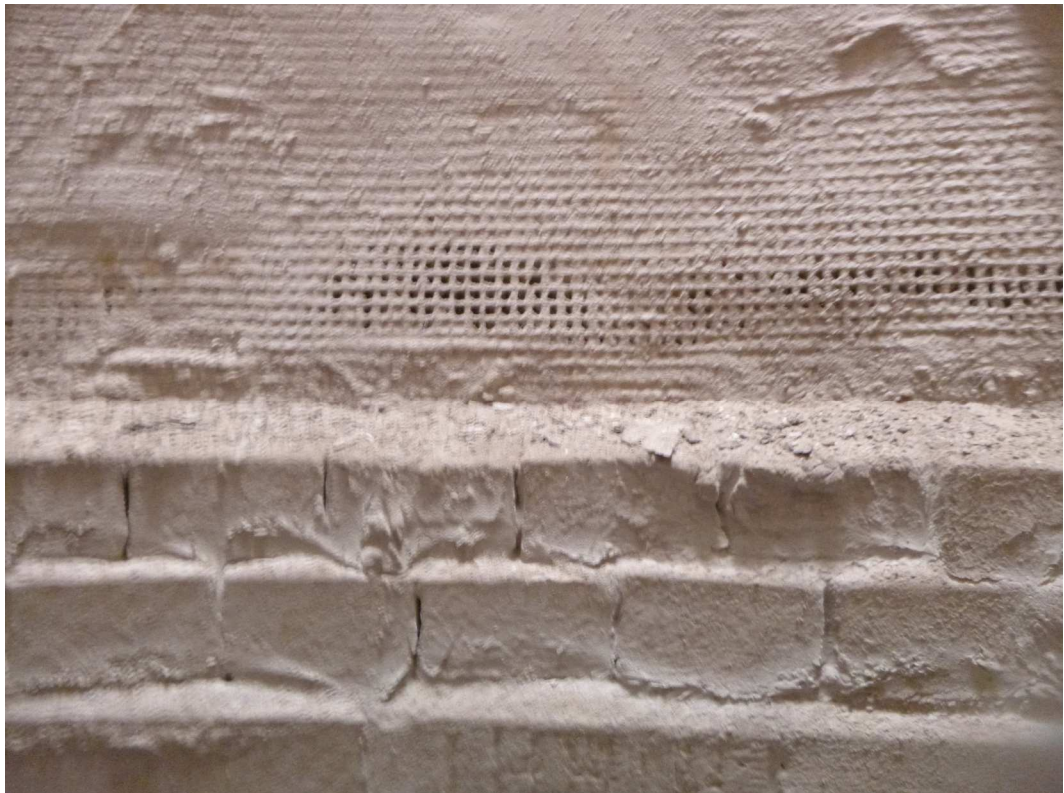
Fot. 43. Brak ciągłości masy uszczelniającej (nad dylatacją + 51 m)
