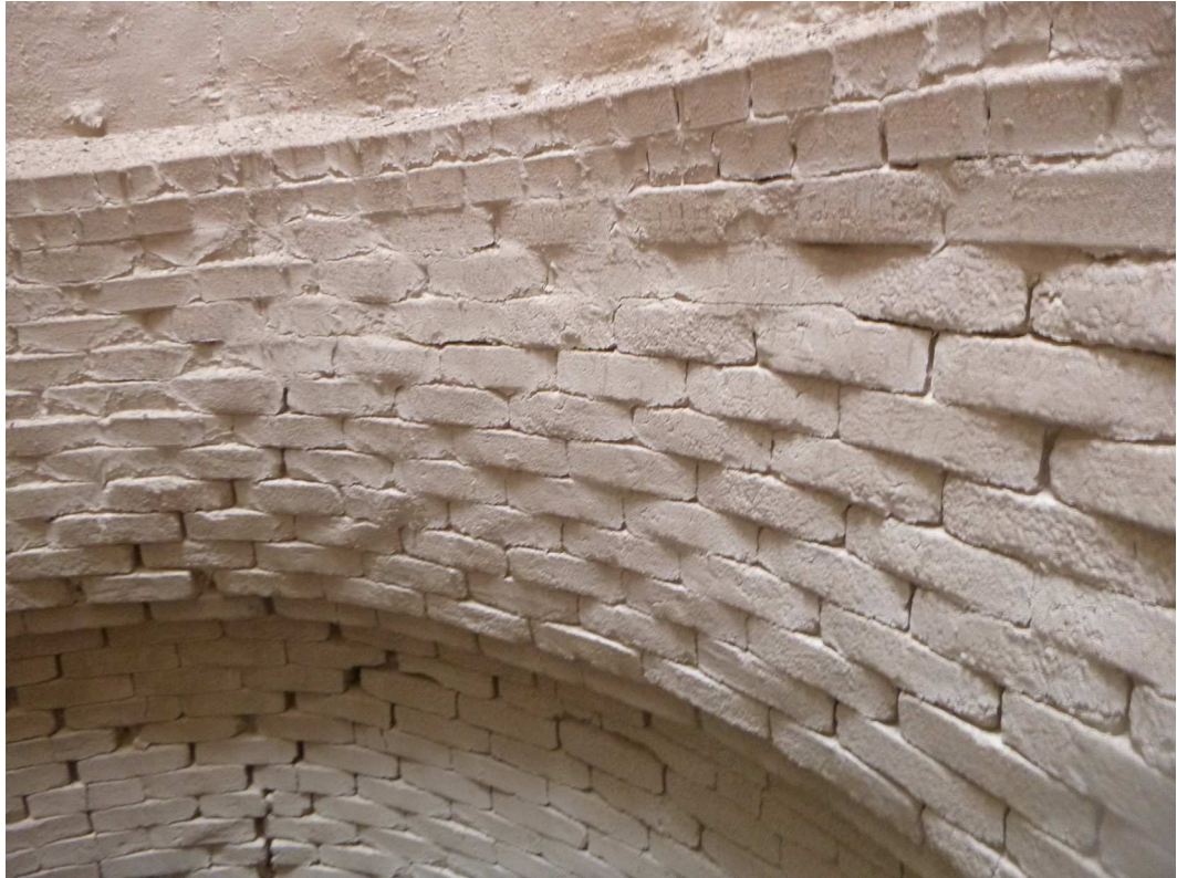
Fot. 44. Dylatacja +50÷51 m - ubytki spoin, poniżej pęknięcie o rozwartości 1÷2 cm
