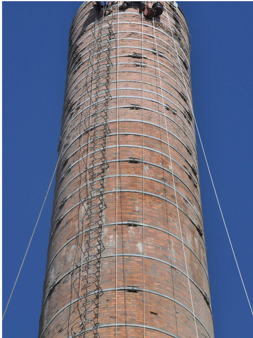
Fot. 4. Strefa intensywnych wycieków
