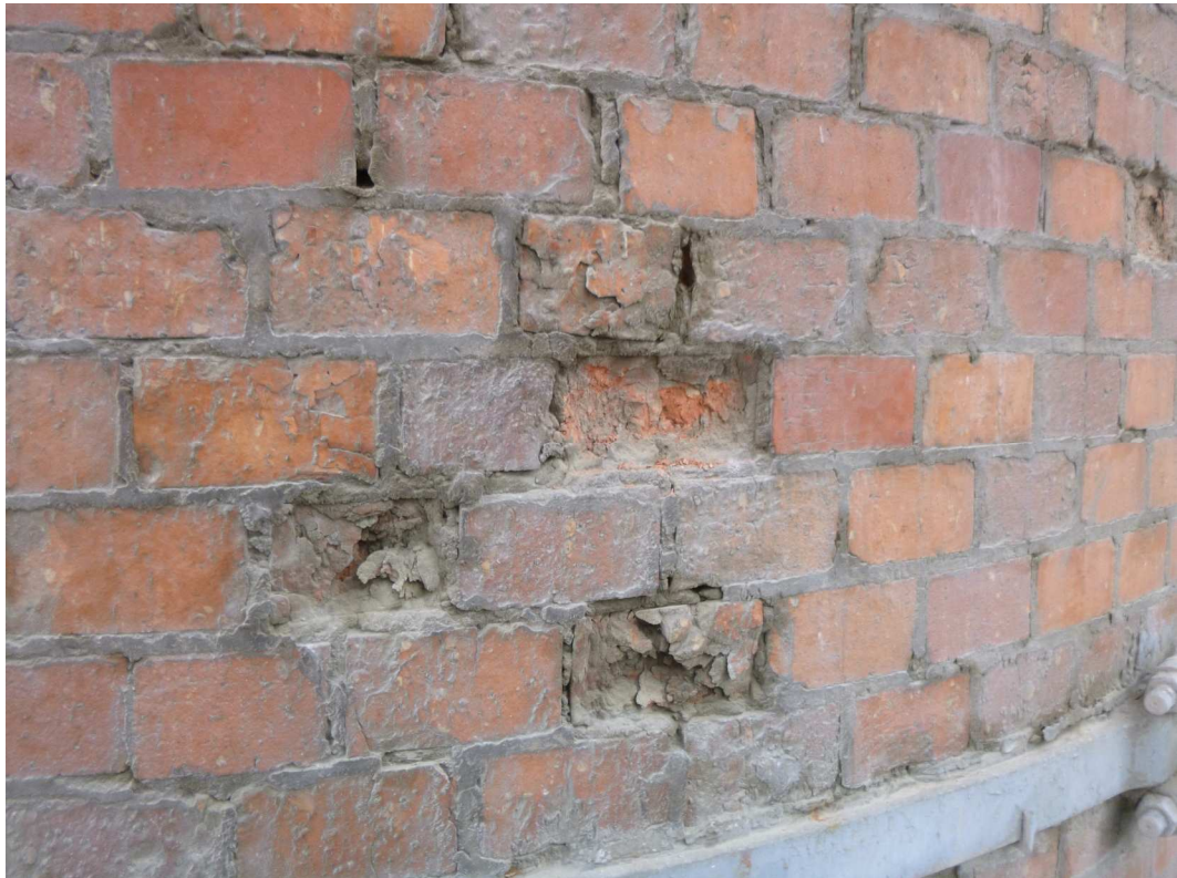
Fot. 27. Silna destrukcja cegieł, złuszczenia warstwowe
