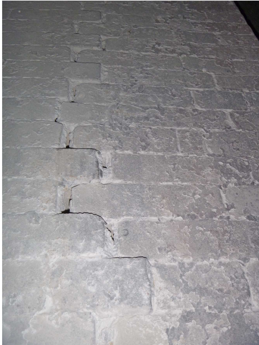
Fot. 61. Długie pęknięcie z boku otworu czopuchowego
