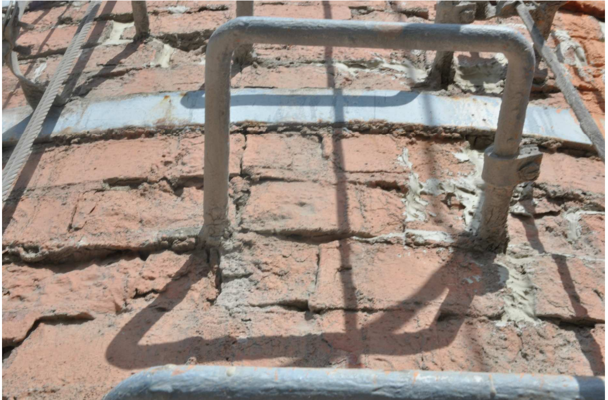
Fot. 68. Ubytki korozyjne szczelbi przy połączeniu z murem
