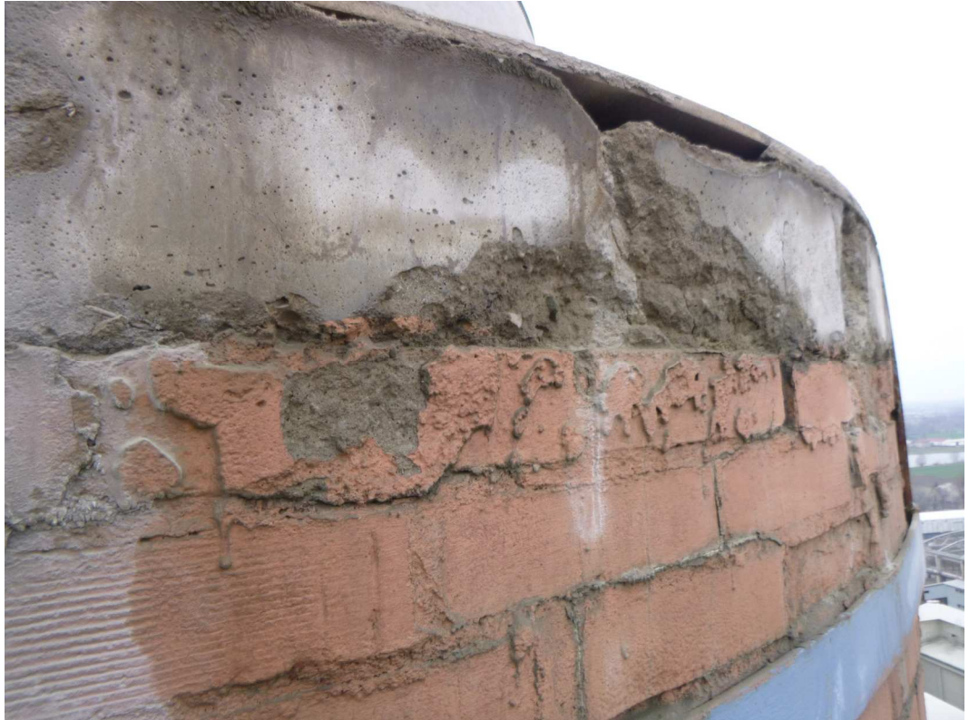
Fot. 13. Zwieńczenie trzonu komina – brak okapu zwężki chroniącego wieniec przed zaciekami
