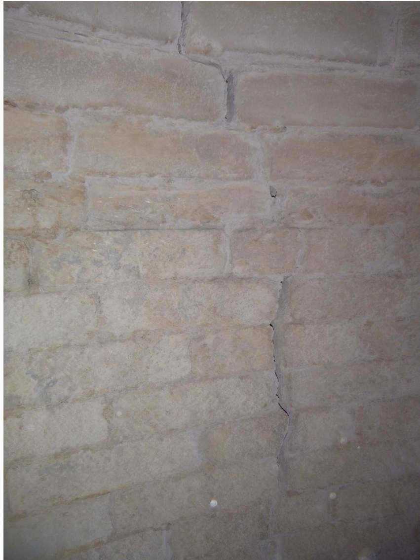
Fot. 55. Poziom +28-32 m - rysy na obwodzie o rozwarości 1-2 cm
