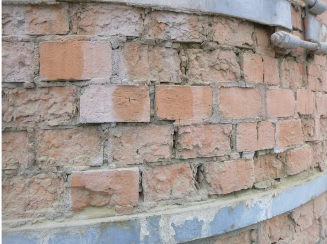
Fot. 20. Degradacja cegieł w górnej części komina
