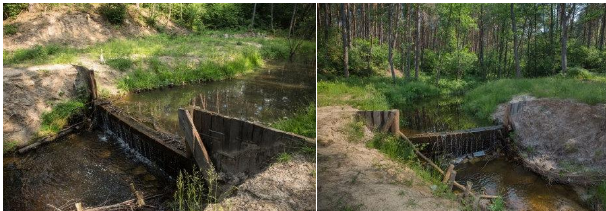
Próg wygięty pod presją naporu wody. Źródło: Archiwum CKPŚ.
