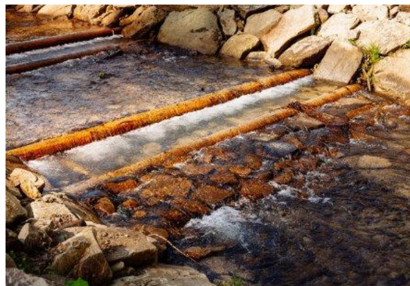
Gurt ubezpieczający próg – gurt zabezpieczony narzutem kamiennym – rozwiązanie podobne do rys na rycinie a) Źródło: Archiwum CKPŚ
