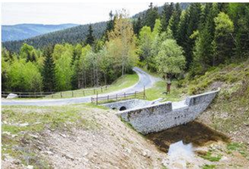
Opróżniona z zalegającego rumoszu wysoko położona na zboczu góry zapora w Nadleśnictwie Świeradów. Źródło: Archiwum CKPŚ.
