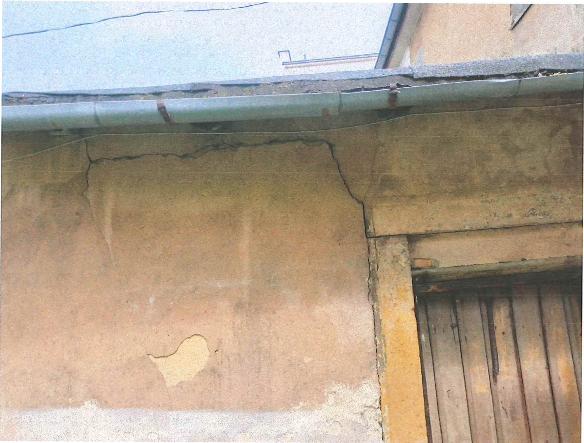
spękanie ściany podłużnej tylnej budynku gospodarczego
