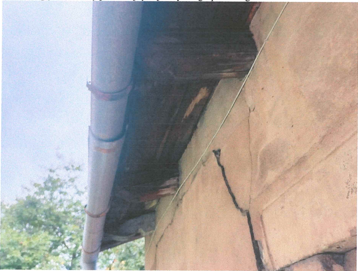
spękanie z przemieszczeniem ściany podłużnej tylnej budynku gospodarczego
