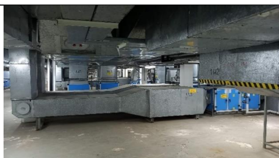
Zdjęcie nr 4 – wentylatornia kuchni
