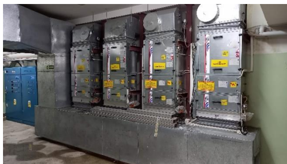
Zdjęcie nr 5 – centrale obsługujące magazyn rezerwowy
