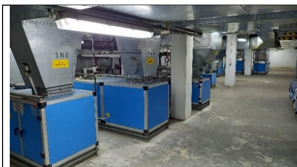
Zdjęcie nr 3 – wentylatornia kuchni
