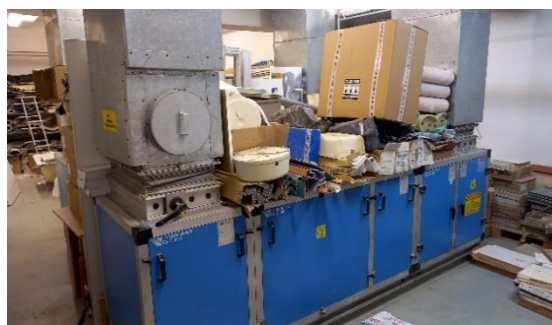
Zdjęcie nr 7 – wentylatory obsługujące pomieszczenie agregatów
