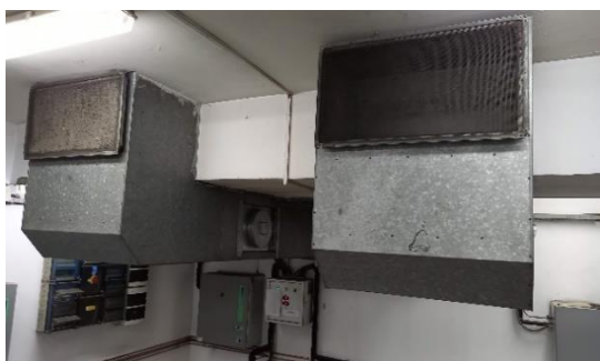
Zdjęcie nr 6 – wyrzutnie z pomieszczenia agregatów chłodniczych
