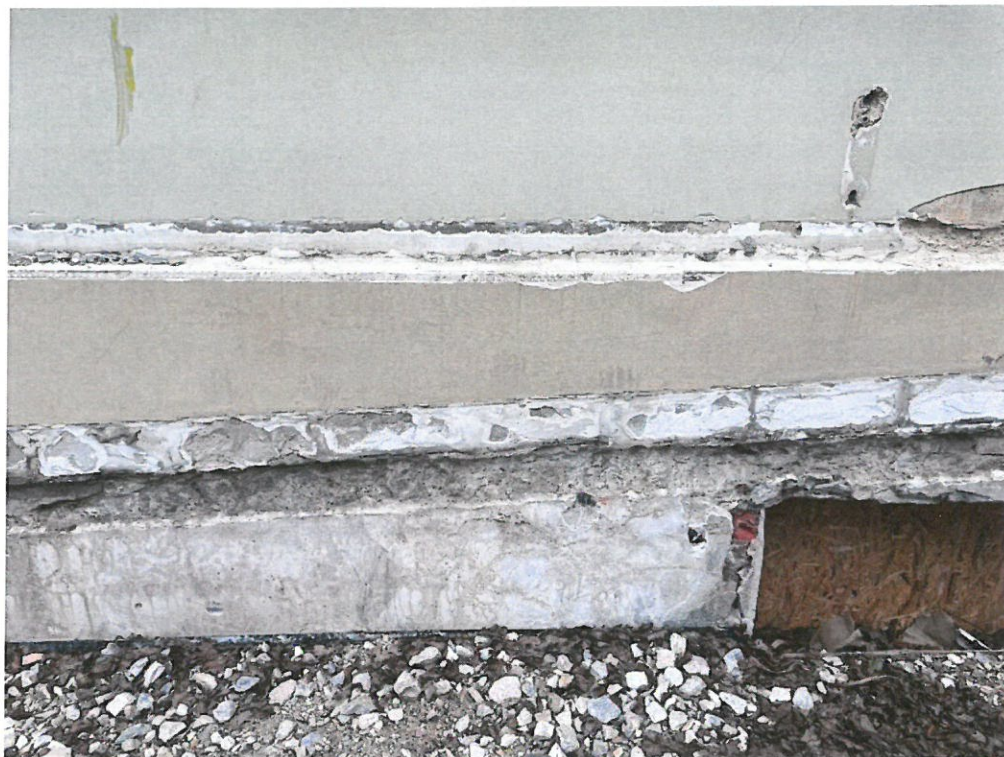
Ubytki w cokole.
