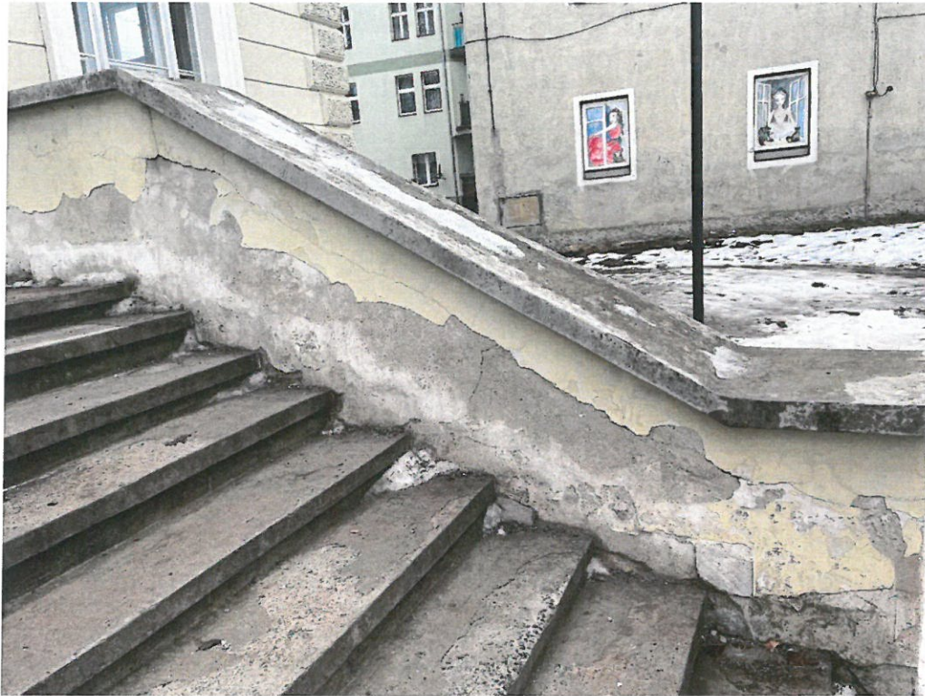
Odpryski tynku – schody wejście główne – elewacja frontowa
