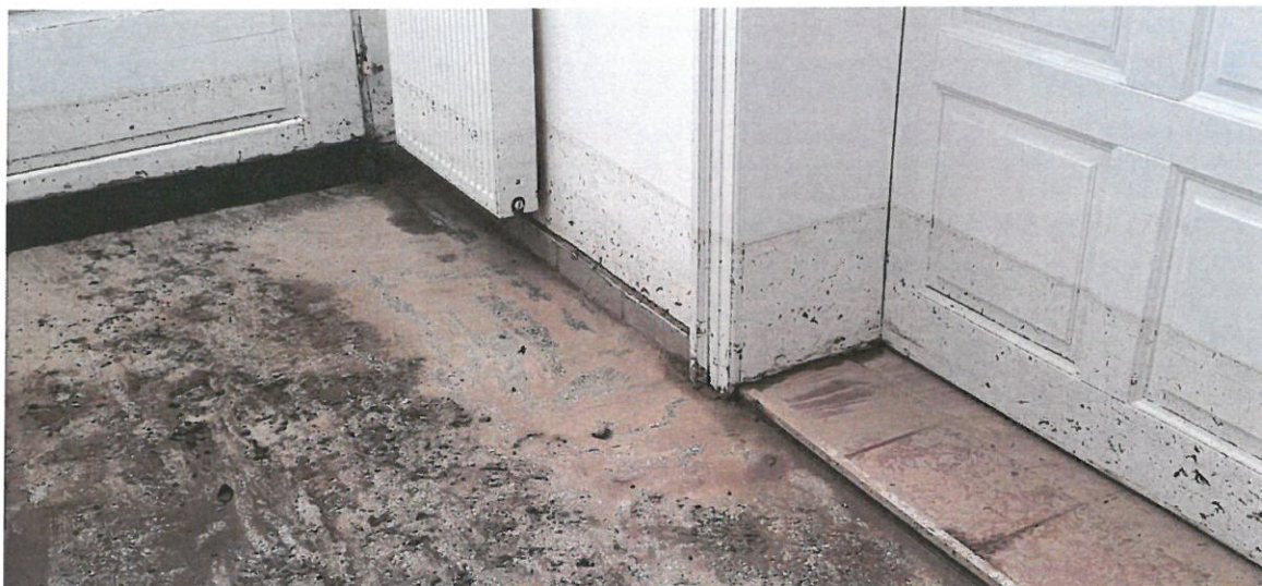
Widoczny poziom wysokości wody wewnątrz – hol i drzwi do biblioteki (parter budynku)
