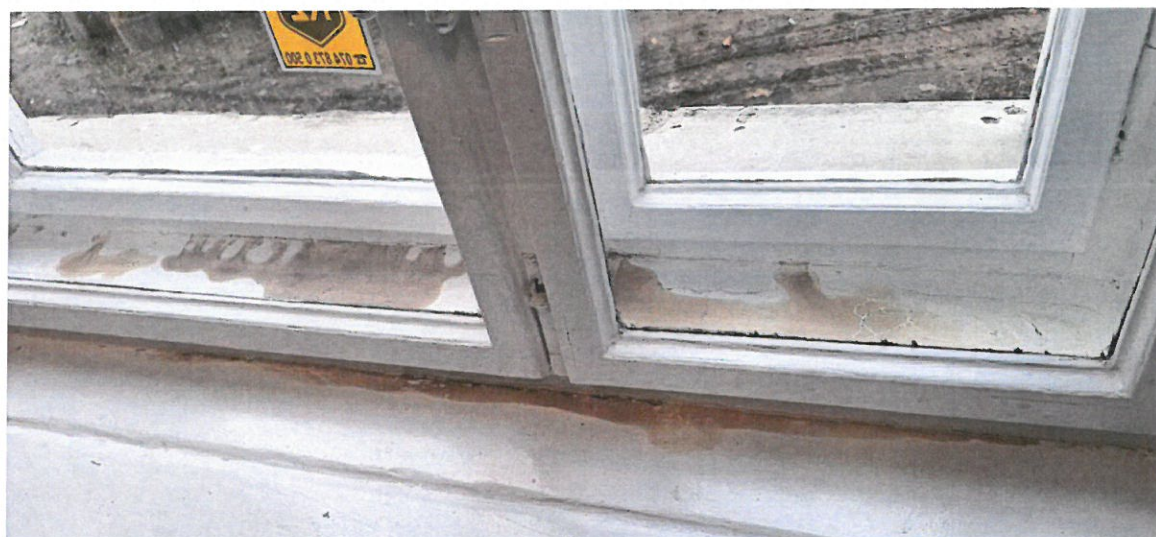
Widoczne pozostałości nanosów na parapetach i w skrzynkach okien w bibliotece
