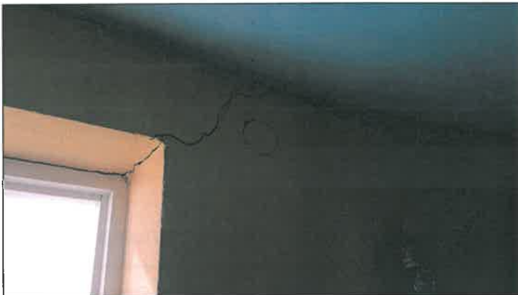
Zdjęcie 3. Pęknięcie w ścianie wewnętrznej podłużnej na poddaszu w skrzydle północno-zachodnim nad salą nr 16 – widok od strony okapu
