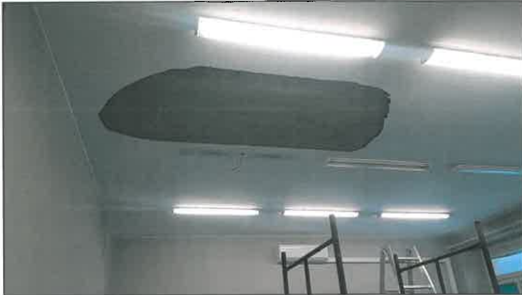
Zdjęcie 2. Odspojony tynk od stropu nad 2. piętrem (sala nr 16)
