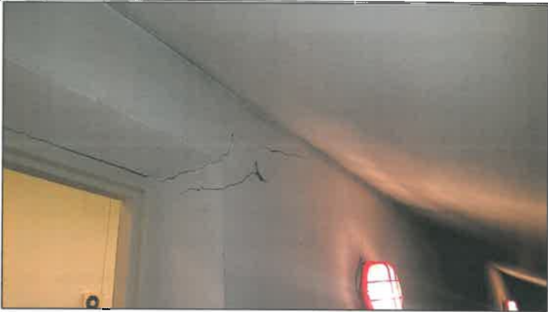
Zdjęcie 4. Pęknięcie w ścianie wewnętrznej podłużnej na poddaszu w skrzydle północno-zachodnim (2)
