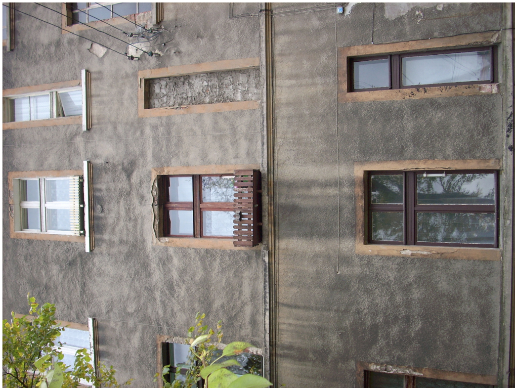
Fot. 7. Elewacja północna . Popękane nadproża.
