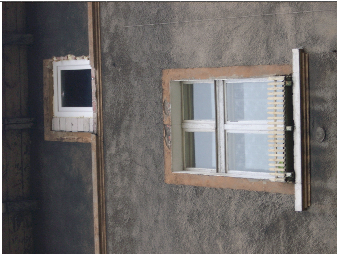
Fot. 8. Elewacja północna . Popękane nadproża.
