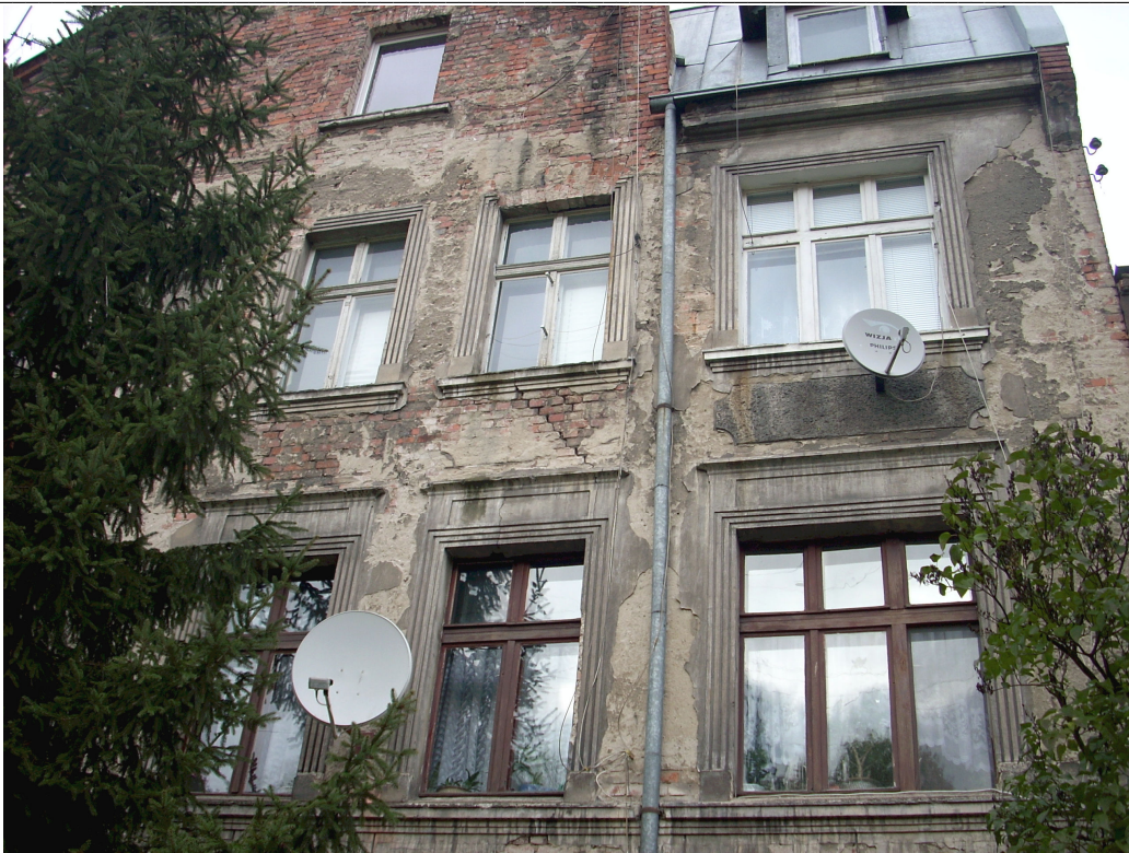
Fot. 18. Elewacja południowa . Popękane nadproża.
