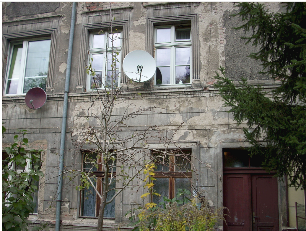
Fot. 14. Elewacja południowa . Popękane nadproża.
