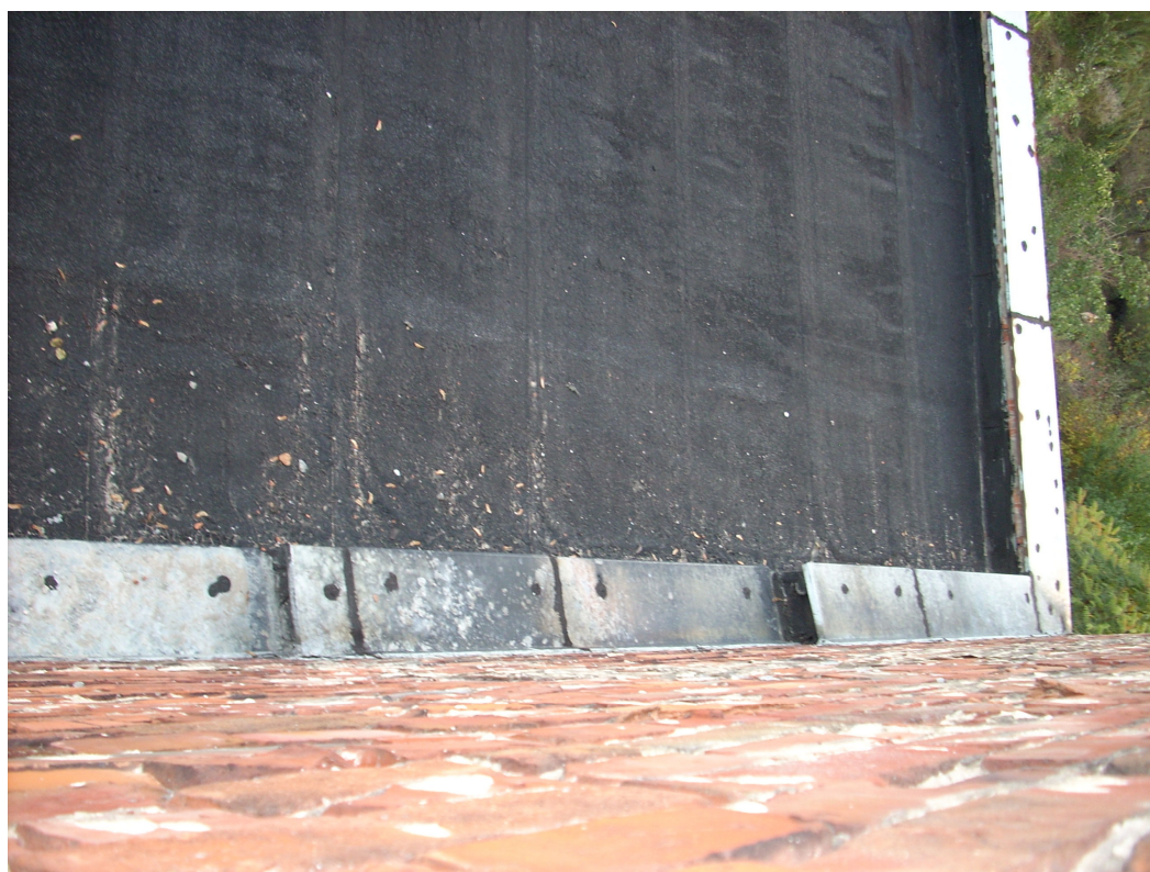
Fot. 12. Ściany attykowe .
