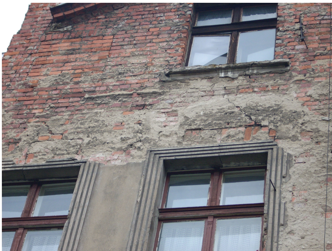
Fot. 15. Elewacja południowa . Popękane nadproża.
