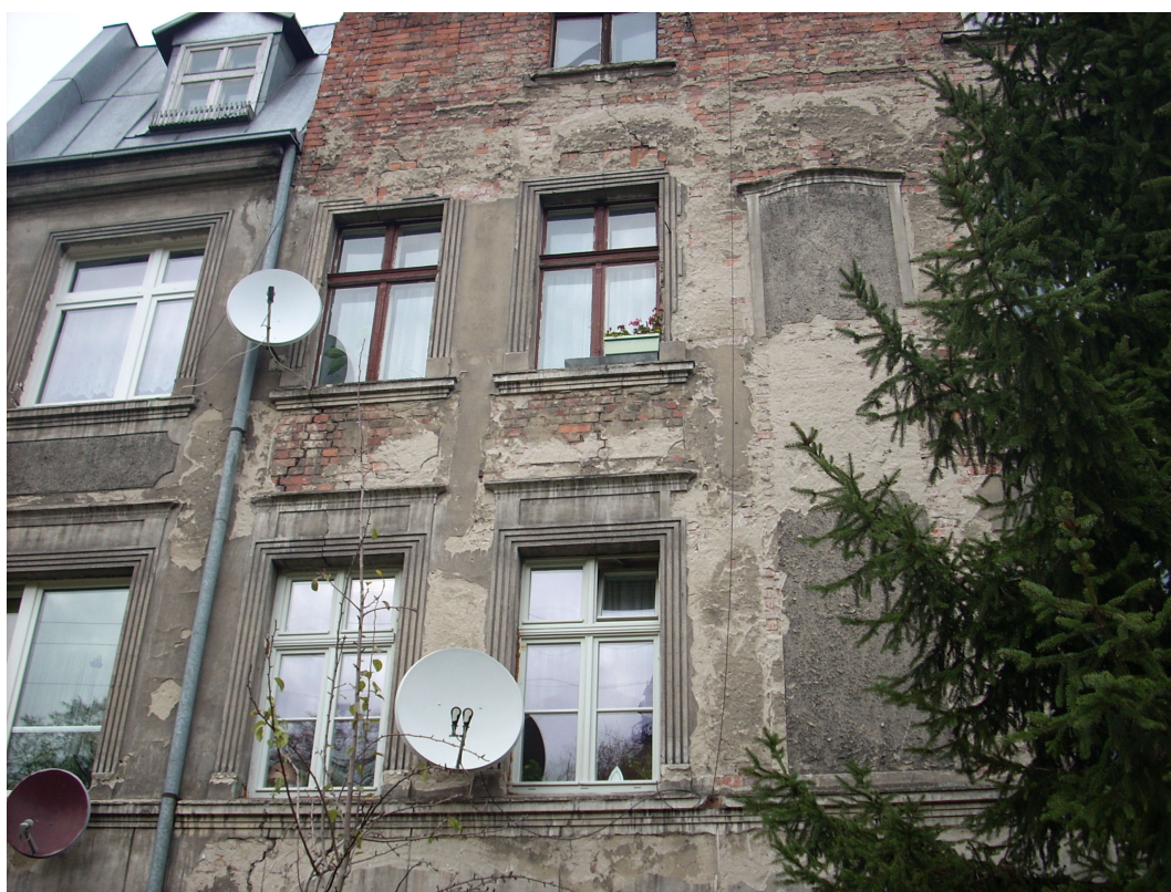
Fot. 13. Elewacja południowa . Popękane nadproża.
