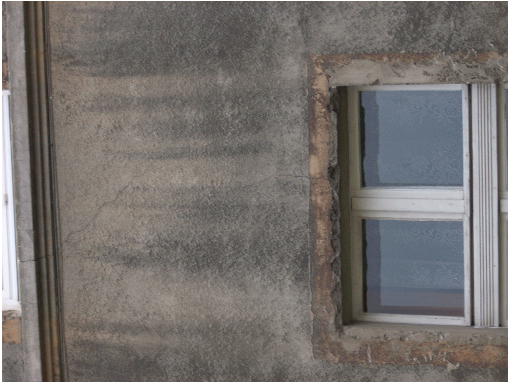
Fot. 6. Elewacja północna . Popękane nadproża.
