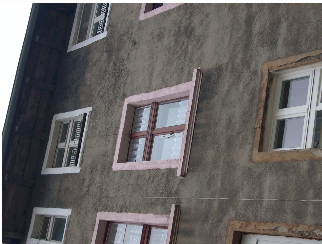
Fot. 4. Elewacja północna . Popękane nadproża.
