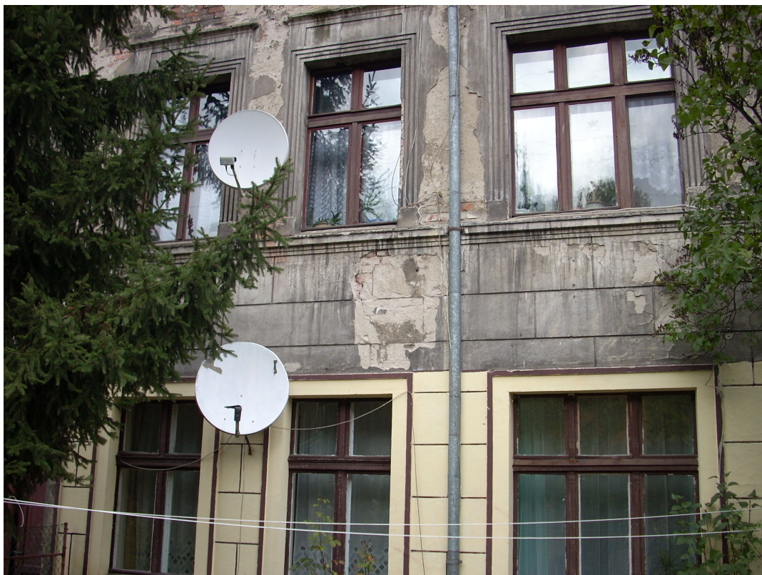
Fot. 19. Elewacja południowa . Popękane nadproża.
