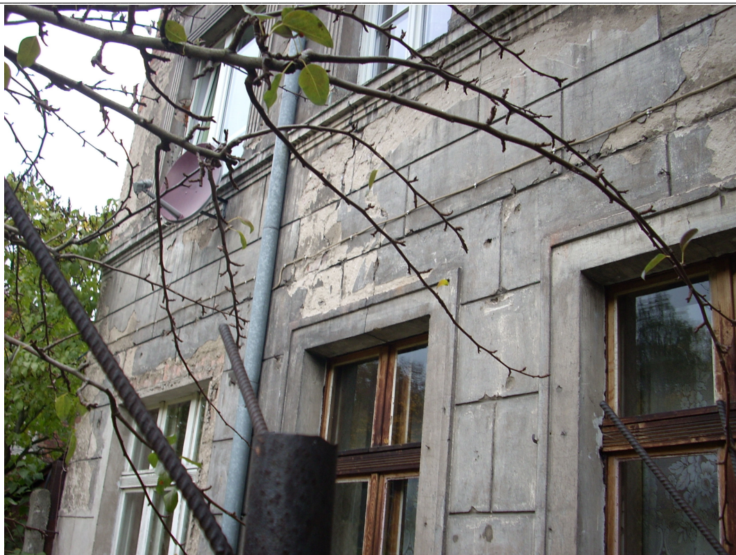
Fot. 16. Elewacja południowa . Popękane nadproża.
