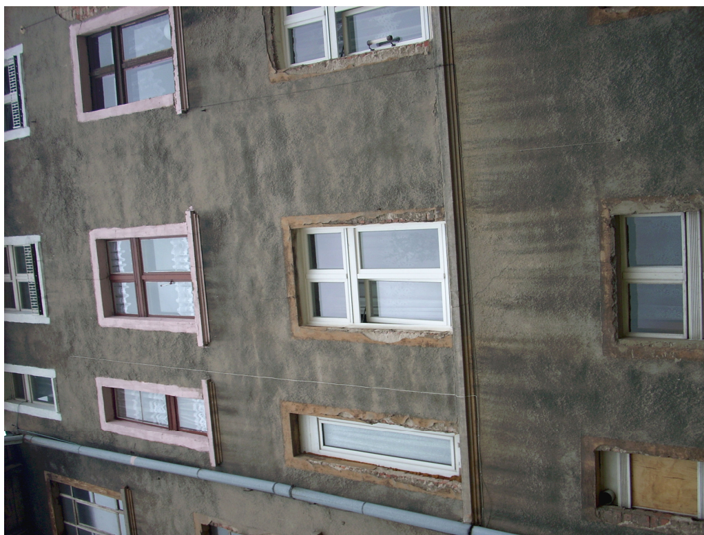
Fot. 5. Elewacja północna . Popękane nadproża.
