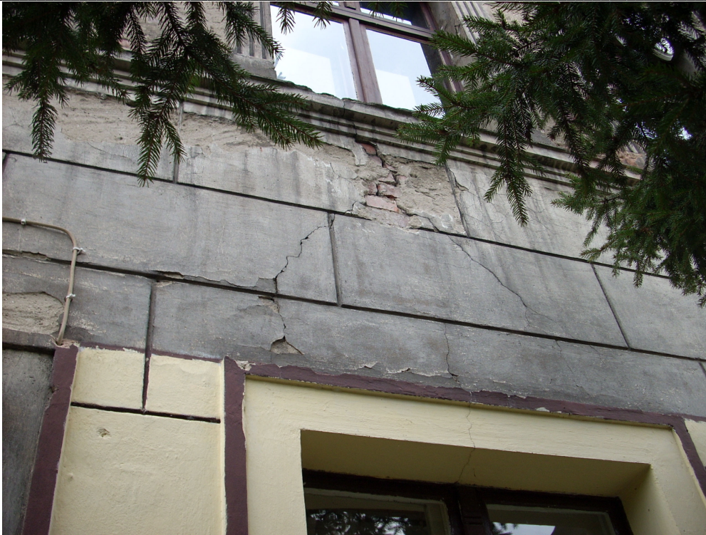
Fot. 20. Elewacja południowa . Popękane nadproża.
