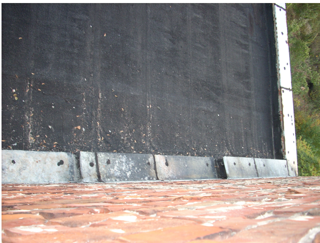
Fot. 25. Widok z okna na elewacji wschodniej na stropodach budynku sąsiedniego i jego ściany attykowe.
