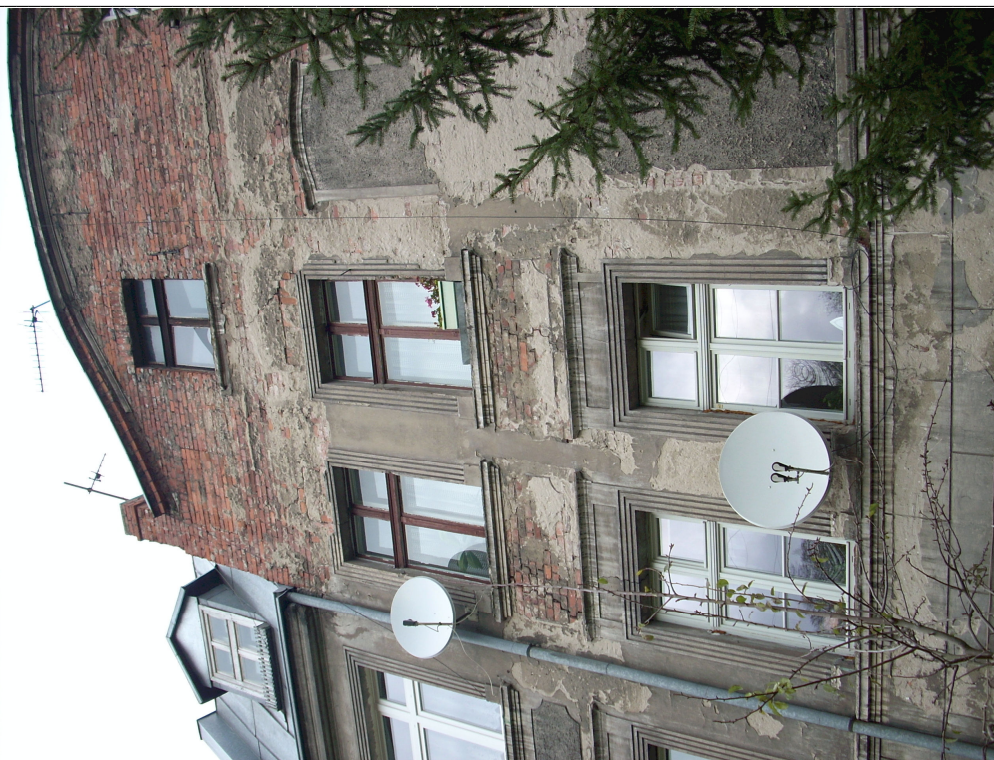
Fot. 12. Elewacja południowa . Popękane nadproża.
