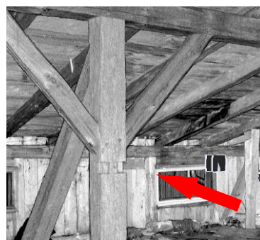
Rys. 8. Ubytki w słupie.
