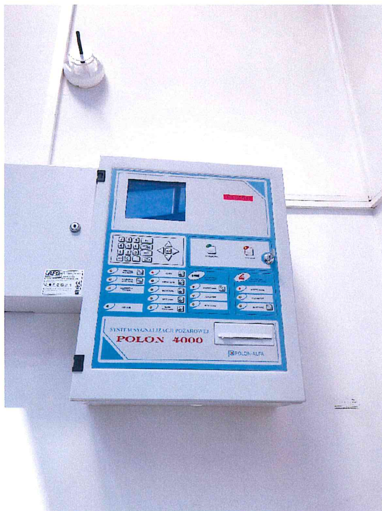
Zdjęcie nr 17 – II piętro centrala alarmowa POLON ALFA 4000
