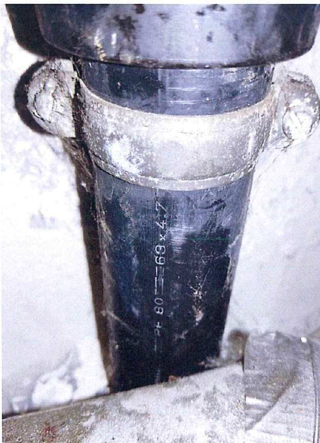
Zdjęcie nr 3 – przyłącz wodociągowy
