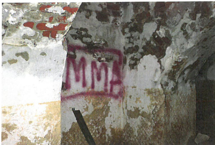
Zdjęcie nr 11. Pom. nr 2. Widok na zawalony strop z cegły
