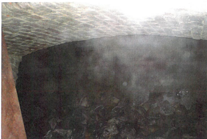
Zdjęcie nr 32. Pom. nr 8. Widok pomieszczenia z odpadami
