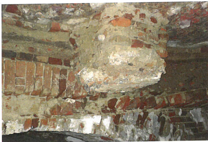
Zdjęcie nr 14. Pom. nr 2. Zwałowisko gruzu ze stropu z cegły
