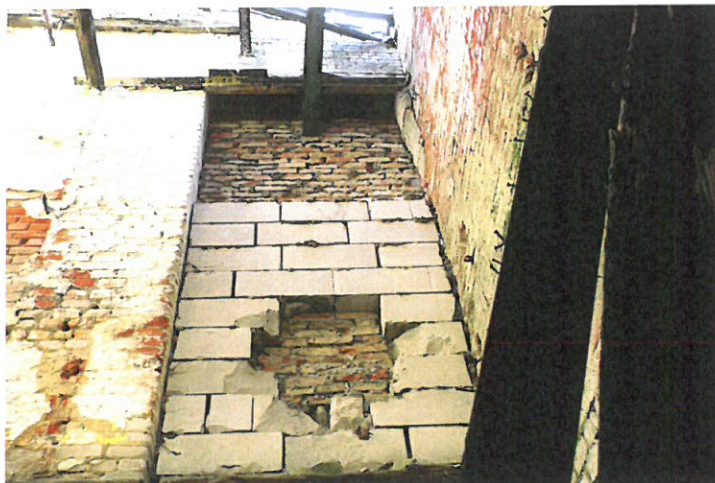
Zdjęcie nr 17. Pom. nr 3. Widok pomieszczenia z odpadami
