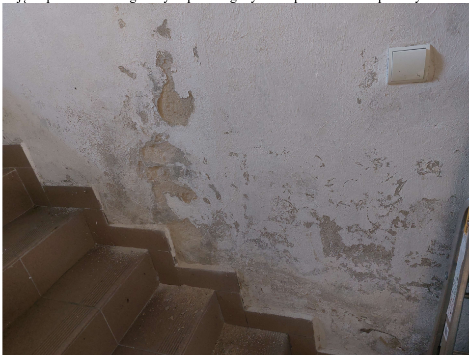
Zdjęcie przedstawia fragmenty odparzonego tynku w pomieszczeniu piwnicy
