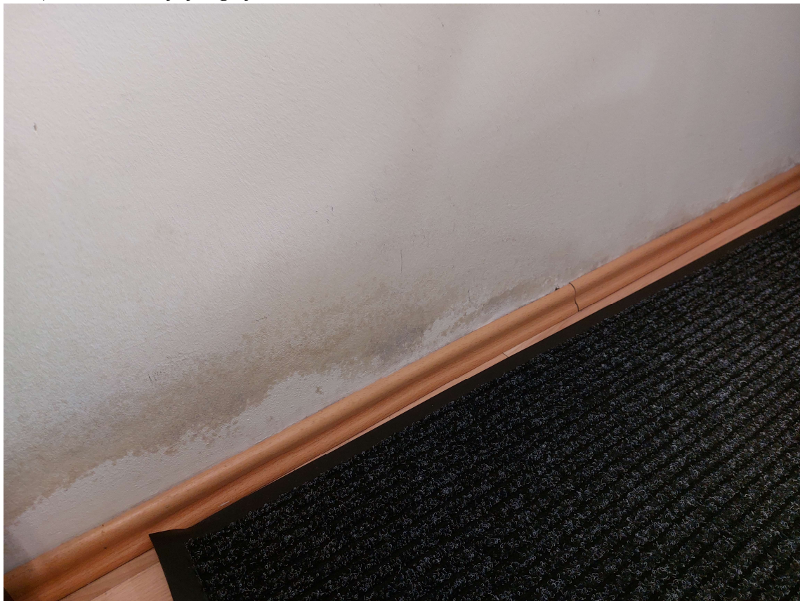
Zdjęcie przedstawia wykwit pleśni w pomieszczeniu biurowym na parterze (pok. Nr 3)
