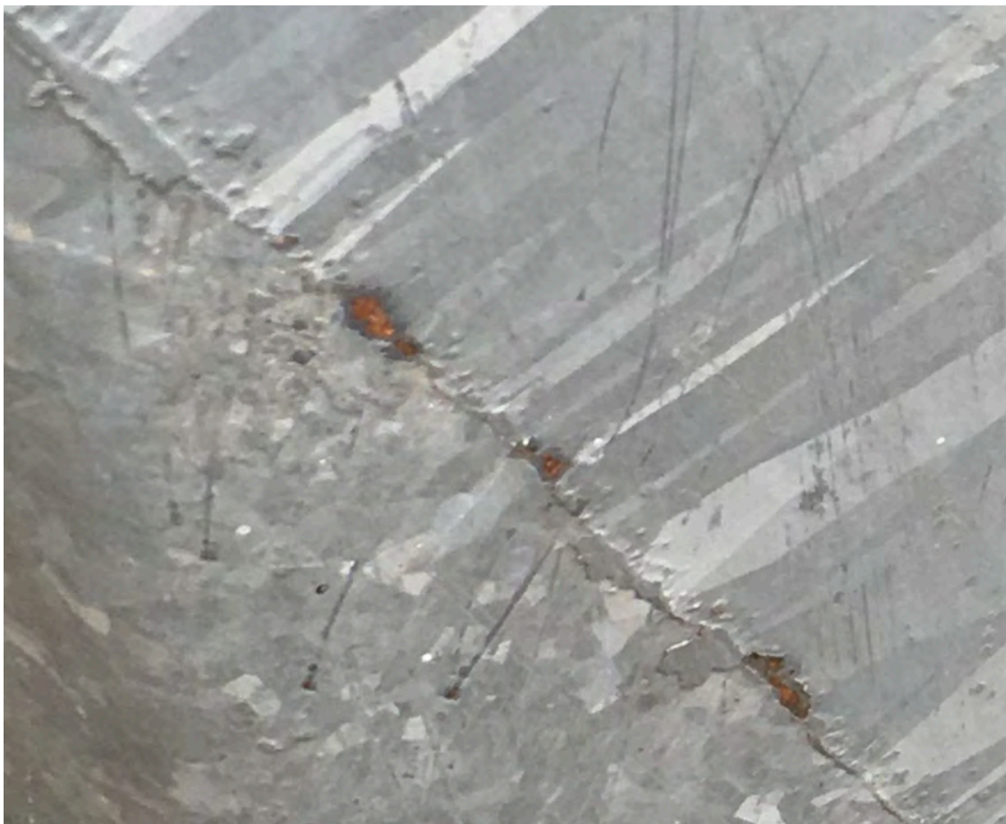
Fot. nr 10. Korozja w obrębie łączonych elementów
