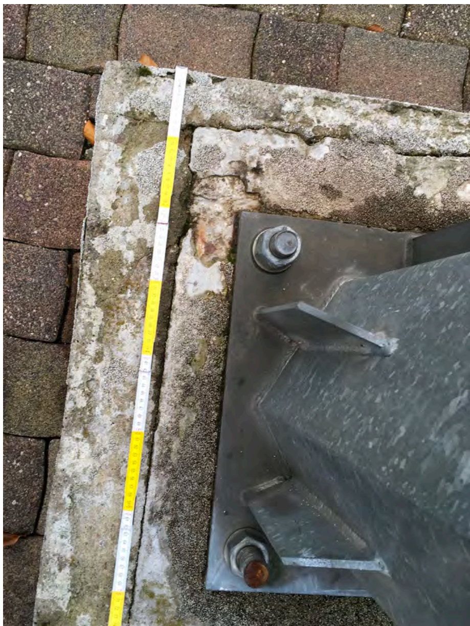
Fot. nr 8. Odspajające się uzupełnienia betonu - fundament S2
