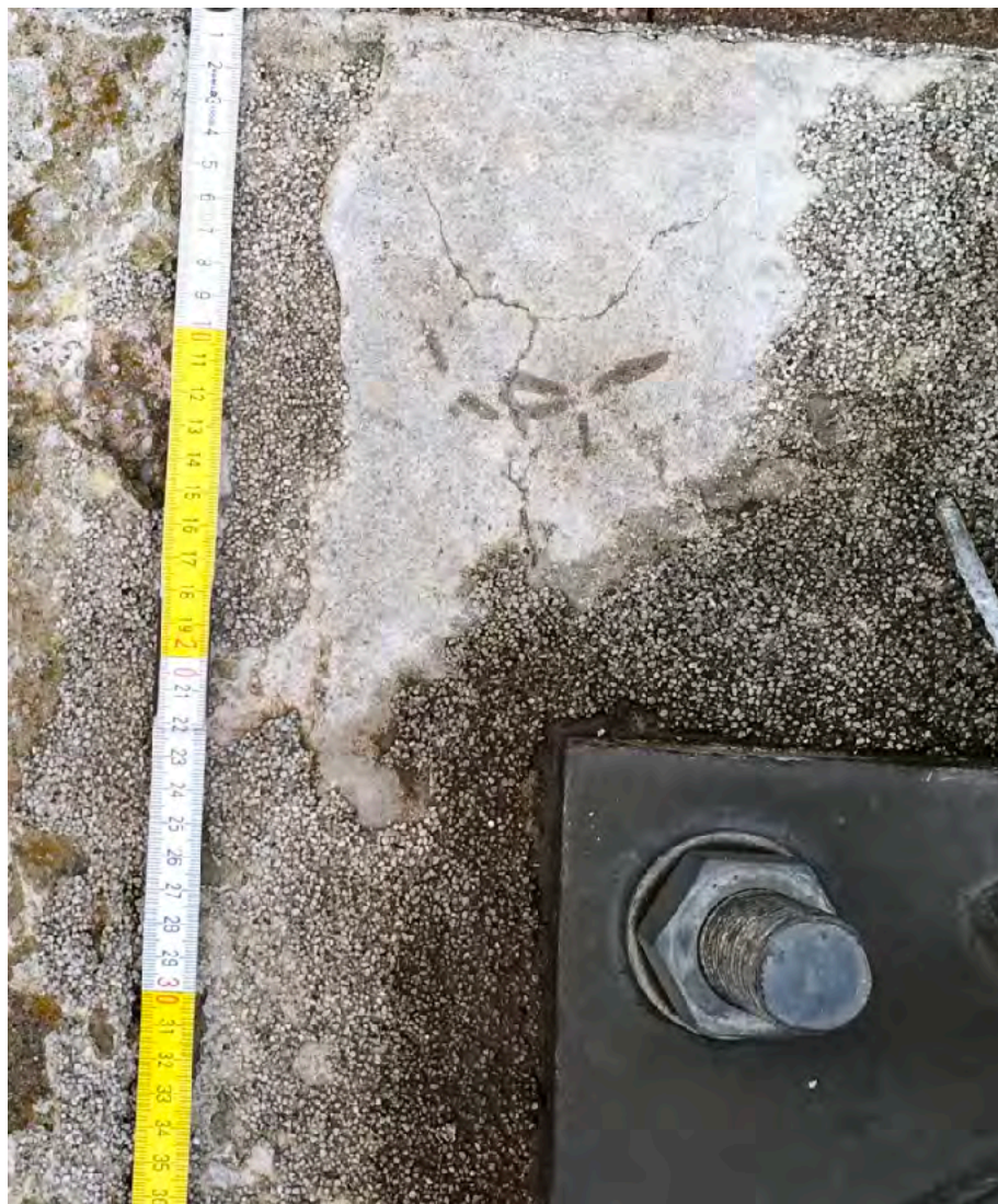
Fot. nr 7. Zarysowania betonu stopy
