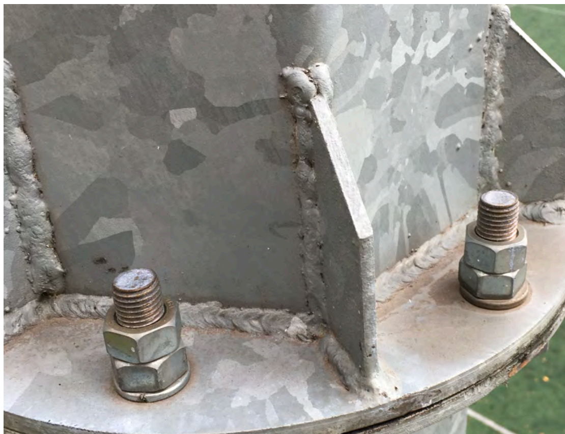
Fot. nr 13. Niestaranne wykonanie spoin pachwinowych segmentu środkowego.
