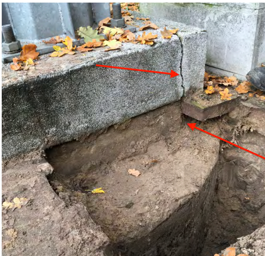
Fot. nr 6. Wyjaśnienie uszkodzenia fundamentu. Właściwe krawędzie fundamentu oznaczono strzałkami
