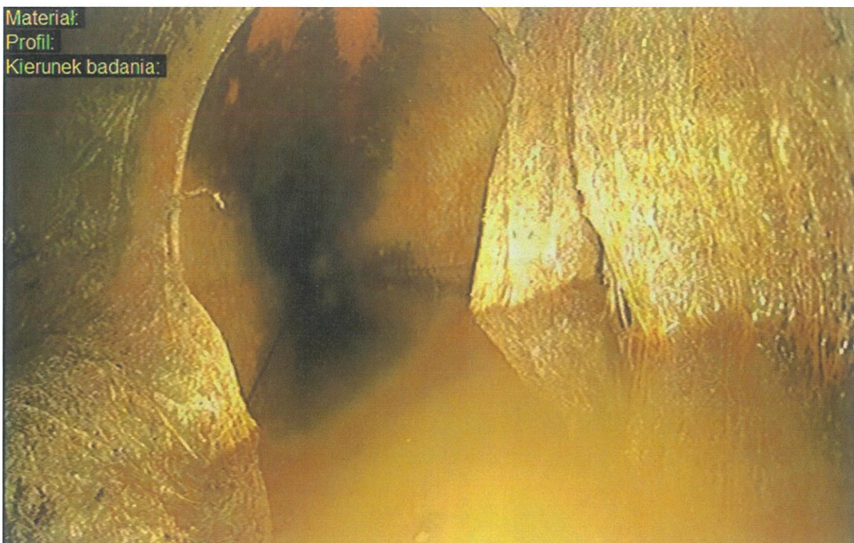
Fot. nr 8 widok stanu wnętrza rurociągu
