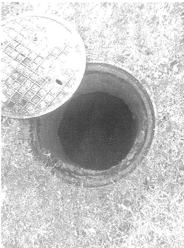
Fot. nr 4 – Studnia rewizyjna.
