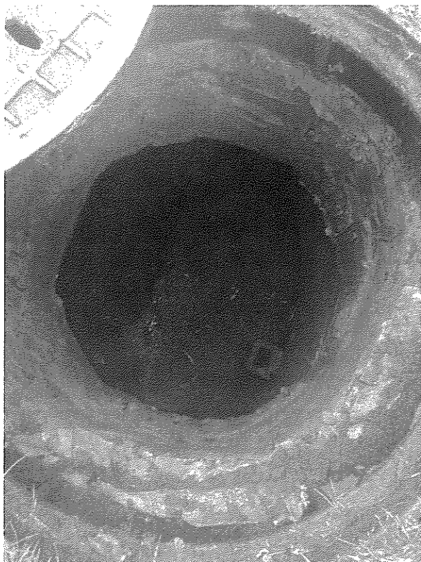
Fot. nr 3 – Studnia rewizyjna.
