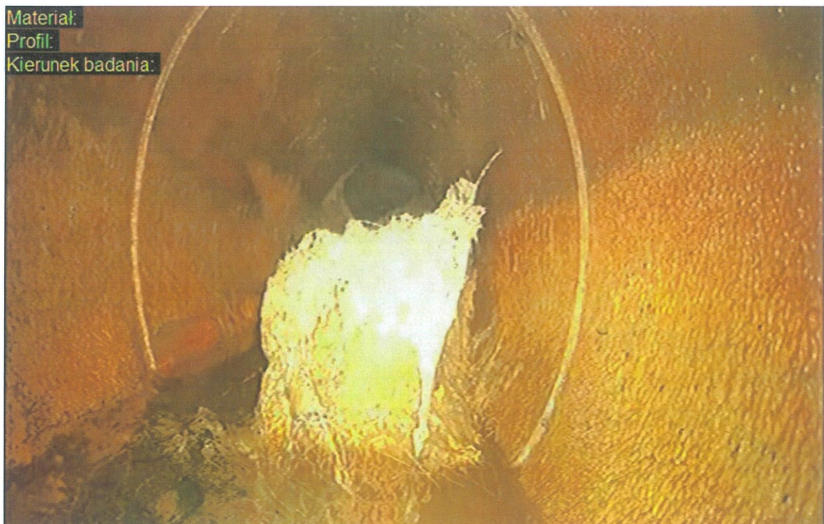
Fot. nr 7 widok stanu wnętrza rurociągu
