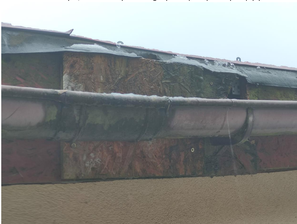
Fot. Przecieki dachu budynku głównego, zgnity okap wykonany z płyty OSB. Uszkodzone i
