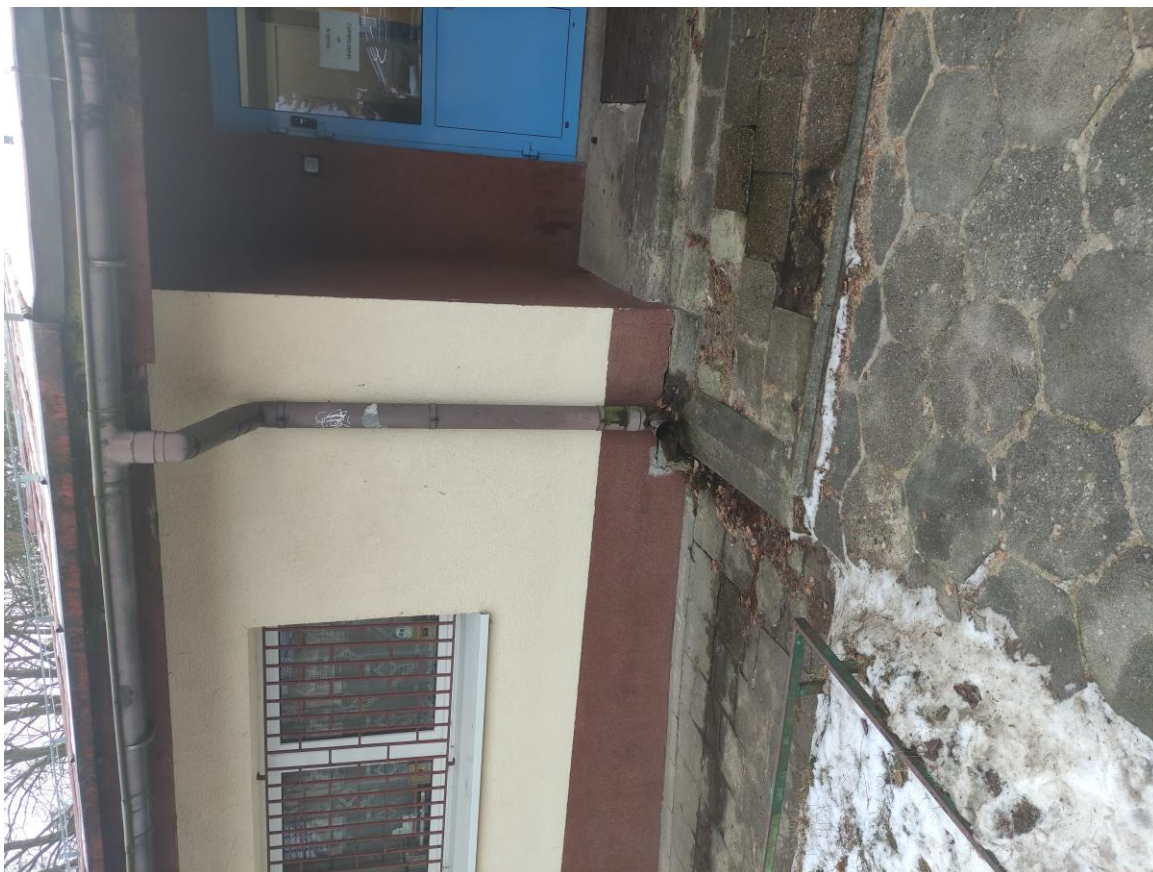
Fot. Przecieki dachu nad wejściem głównym, odwodnienie na teren posesji zalewanie ścian fundamentowych oraz wejścia głównego.
