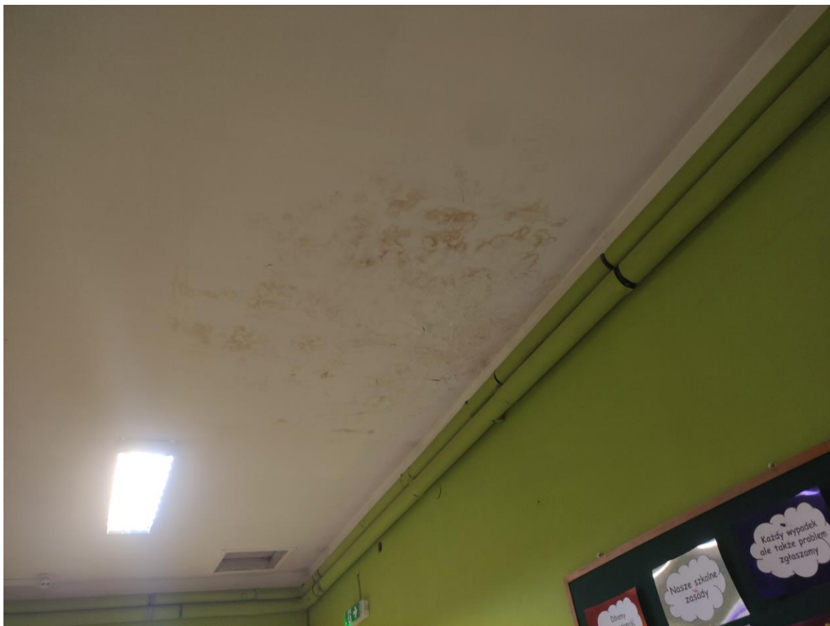
Fot. Zacieki w salach i na komunikacji.
