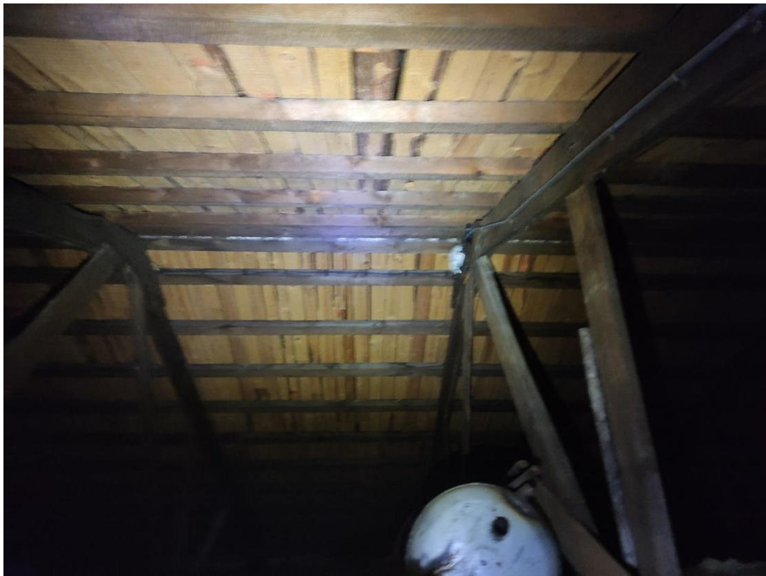
Fot. Przecieki dachu budynku głównego, nieszczelność pokrycia dachu liczne przecieki w obrębie kominów oraz przy łącznikach mocujących blachę do konstrukcji dachu, brak membrany dachowej (lub papy) pod pokryciem z blachy
