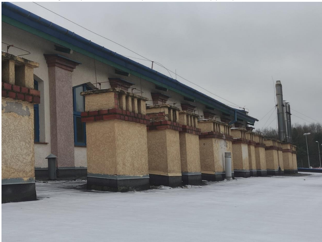
Fot. Dachy budynków szkoły– zdegradowane daszki i piony kominowe , odpadający tynk i rozwarstwiająca się cegła.
