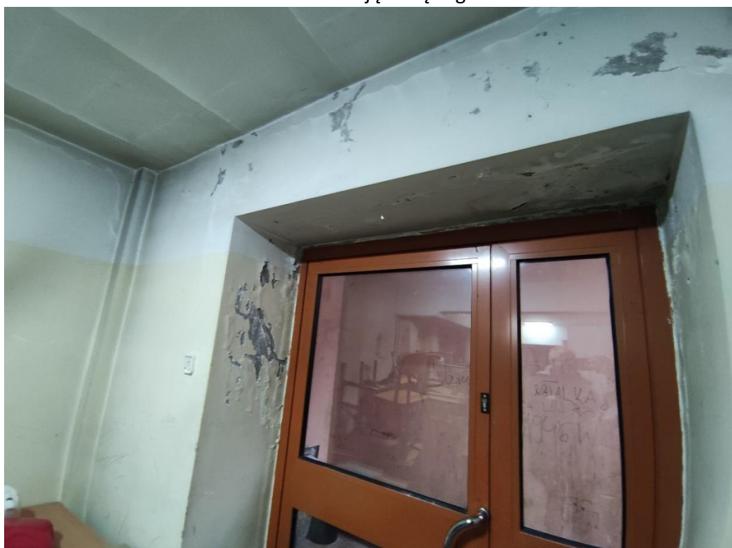
Fot. Zacieki i zagrzybenie wejścia od strony szatni – w wyniku odprowadzania wody opadowej na teren chodników przy dużych opadach woda cofa się i zalewa wejście od strony szatni.
