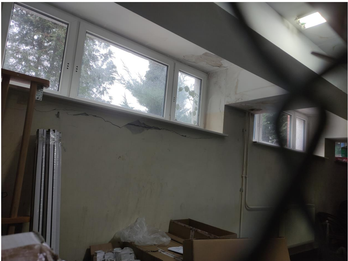
Fot. Zacieki ścian w szatni w wyniku odprowadzenia wody opadowej na teren obiektu.
