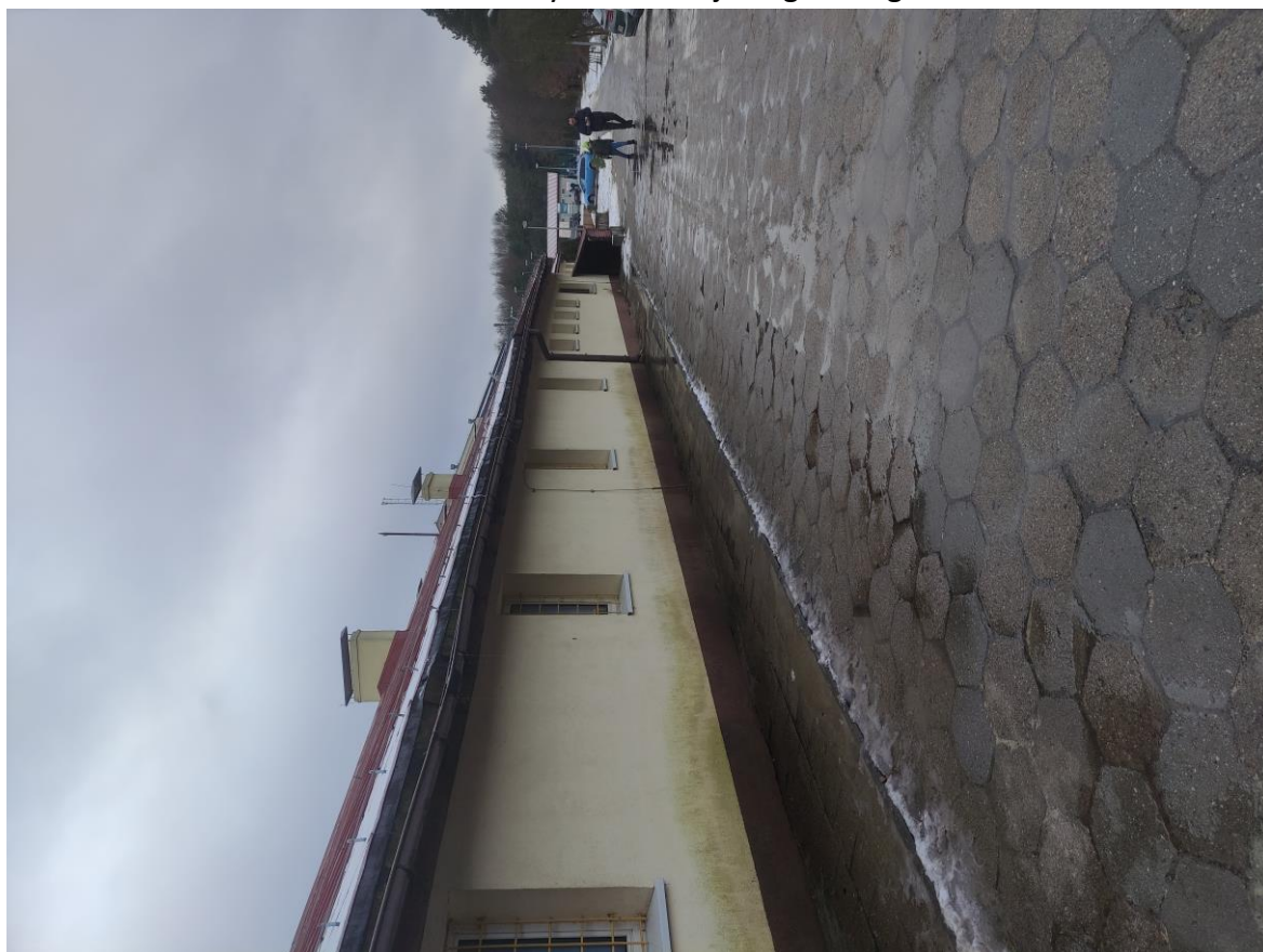
Fot. Przecieki dachu nad wejściem głównym, odwodnienie na teren posesji zalewanie ścian fundamentowych, oberwanie rynien na zgnitym okapie wykonanym z płyty OSB.
