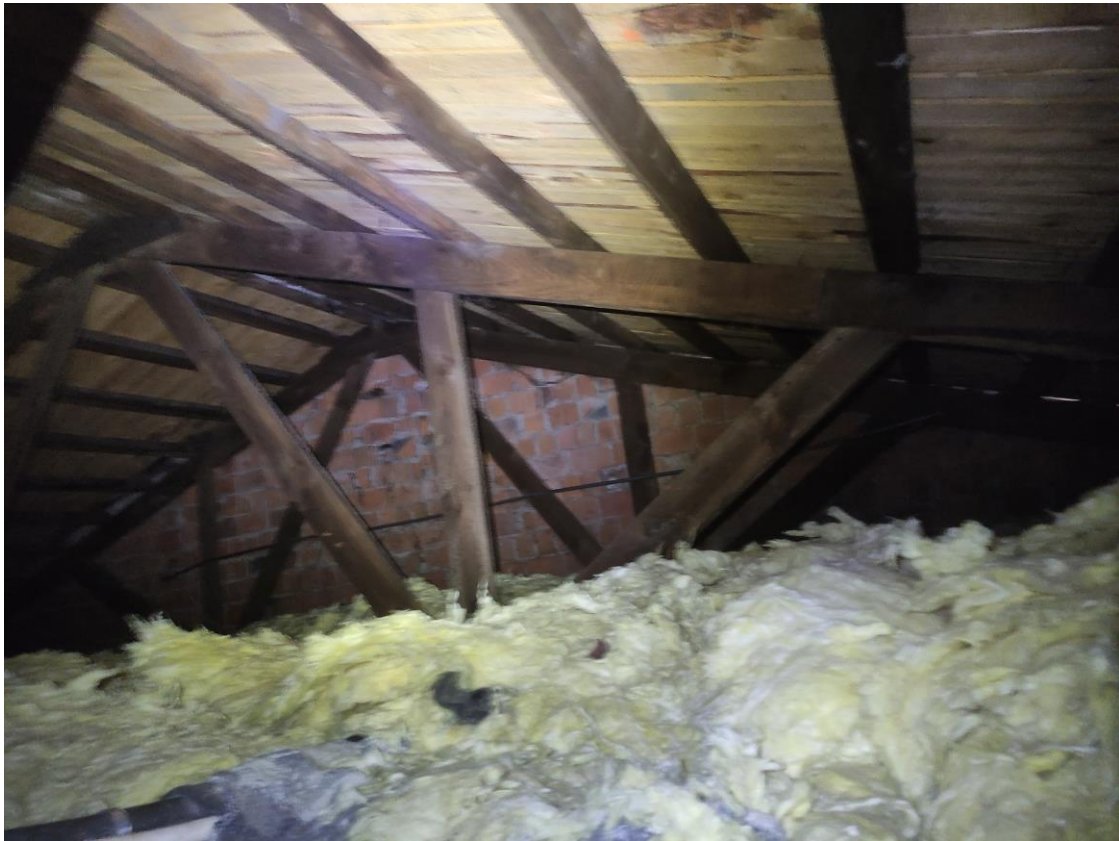
Fot. Termo izolacja stropodachu –warstwy izolacji termicznej w przestrzeni dachowej, które uległa zgniciu podczas zalania i przecieków warstwy pokrycia dachu.
