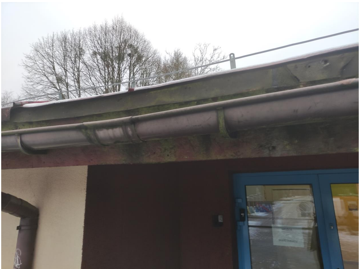
Fot. Przecieki dachu budynku głównego, zgnity okap wykonany z płyty OSB. Uszkodzone i nieszczelne obróbki blacharskie i rynny.
