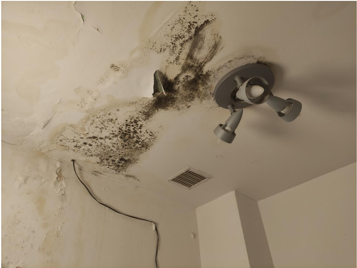
Fot. Zacieki w salach i na komunikacji.
