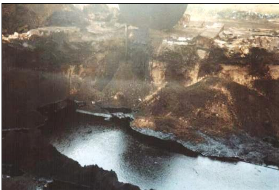
Fot. 11. Odślonienie zbiorników wraz z wylewaniem kreozotu do ziemi (2005) (fot. W. Irmiński)
