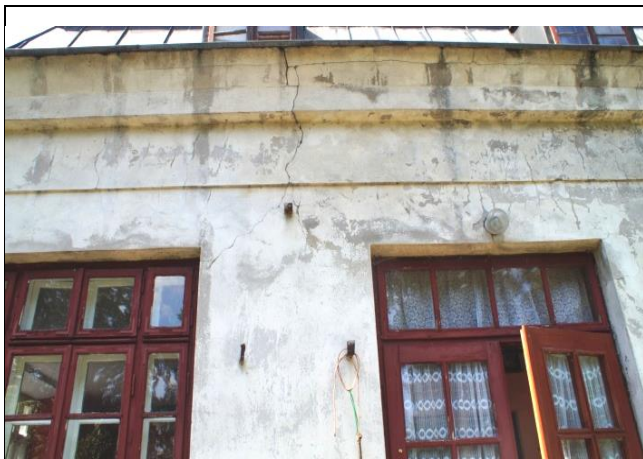
Zd.6.17. Przykład destrukcji ściany zewnętrznej parteru w postaci rys i pęknięć w poziomie pasa nadokiennego od strony zachodniej budynku.
