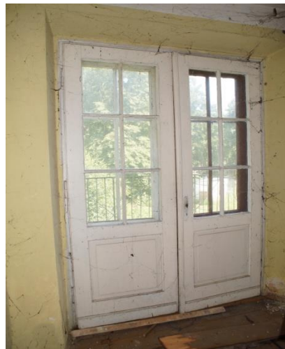
Zd. 9.18. Widok destrukcji stolarki drzwiowej poziom pierwszego piętra.
