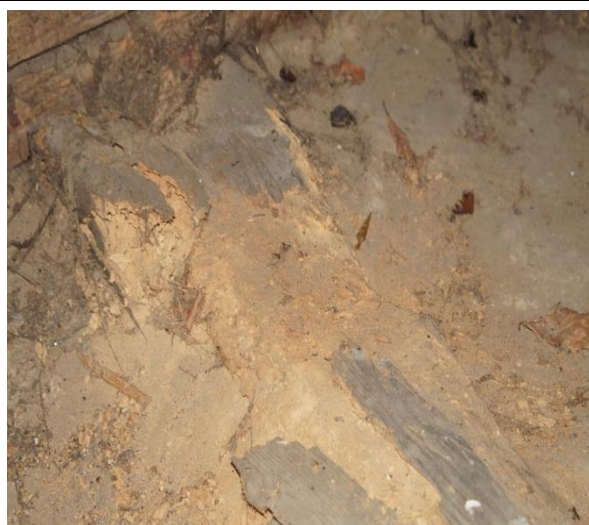
Zd.9.3. Przykład destrukcji legarów stropowych w części strychowej w osi 1-2. Miejscowa korozja biologiczna legarów w granicach 50% do 70% przekroju poprzecznego
