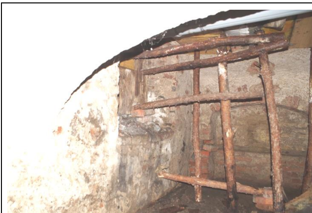
Zd.6.9. Przykład miejscowego podstemplowania awarii stropu kolebkowego w piwnicy nr 01 pod lokalem mieszkalnym nr 2. na poziomie parteru .
