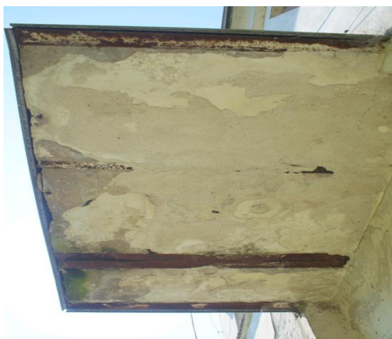
Zd. 6.25. Destrukcyjna w postaci stanu przedawaryjnego w postaci niwłaściwego zamocowania kształtowników stalowych i żelbetowej płyty balkonu pierwszego piętra pom. nr2.17.
