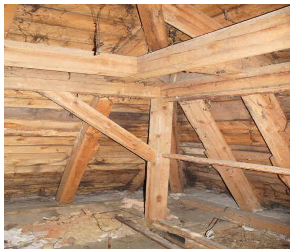
Zd.9.14. Więźba dachowa w osi 1-2. Widoczne miejscowe przedostawanie się wód deszczowych w narożu więźby dachowej. Przykład oparcia słupa nowo zrealizowanej więźby dachowej na zdezolowanej belce stropowej.
