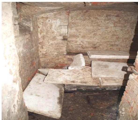
Zd.6.3. Piwnica korytarz. Ceglane sklepienia wskutek ciągłego zalewania wodą deszczową są mokre. Powstały miejscowe ubytki cegieł do głębokości 3 cm. W najbardziej uszkodzonych fragmentach powstały ubytki całych cegieł. Tynk na powierzchni sklepień całkowicie zniszczony.
