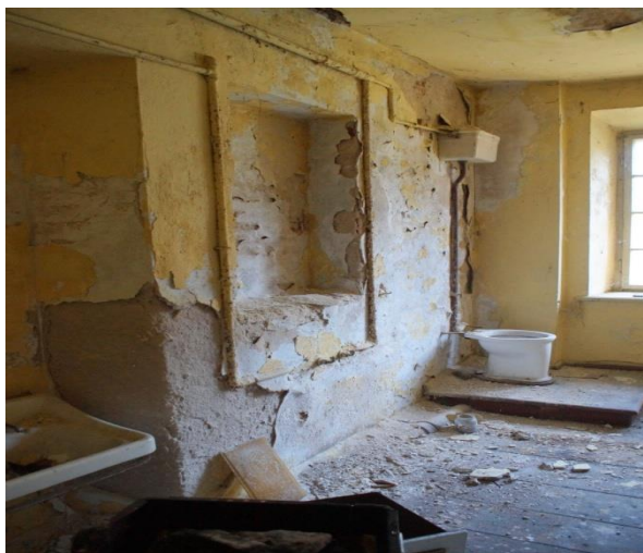
Zd. 6.21. Poziom pierwszego piętra pom. nr 2,18 destrukcja z powodu korozji biologicznej spowodowanej wilgocią. Odształcenie stropu konstrukcji drewnianej w narożu. pomieszczenia.
