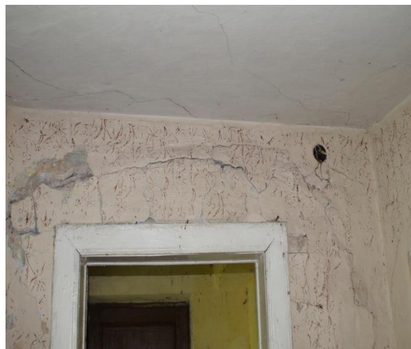
Zd. 6.22. Rysa konstrukcyjna P4 nadproże drzwiowe w nieużytkowanym lokalu pom. nr2.14 na poziomie pierwszego piętra.
