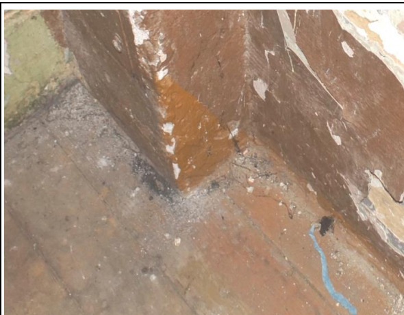
Zd.9.5. Destrukcja desek podłogowych stropu nad parterem poprzez odkształcenie, deformację, ubytku w płaszczyźnie wierzchniej. Korozja biologiczna spowodowana wilgocią.
