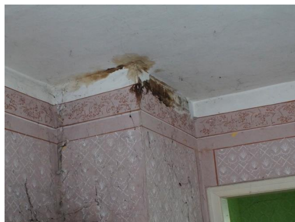
Zd.9.12. Przykład destrukcji stropu nad pierwszym piętrem w pom. nr 2.24. poprzez zalewanie wodami deszczowymi przy konstrukcji komina z cegły ceramicznej pełnej,
