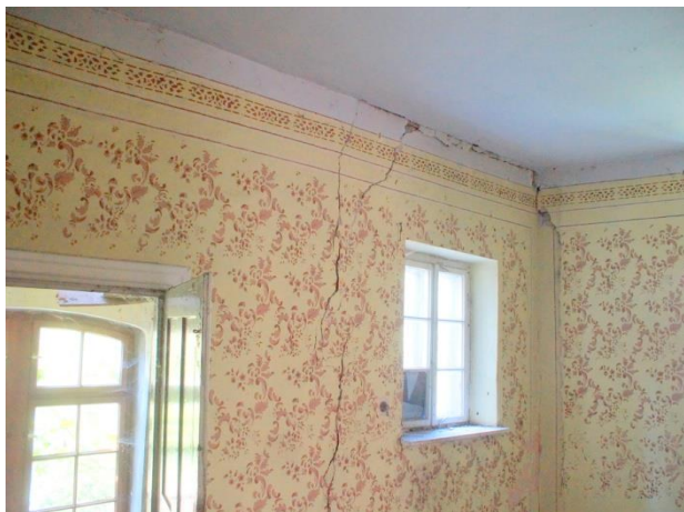
Zd.6.19. Poziom pierwszego piętra pom. nr 2.21. Rysy pionowe, ukośne na powierzchni ściany konstrukcyjnej zewnętrznej od strony zachodniej
