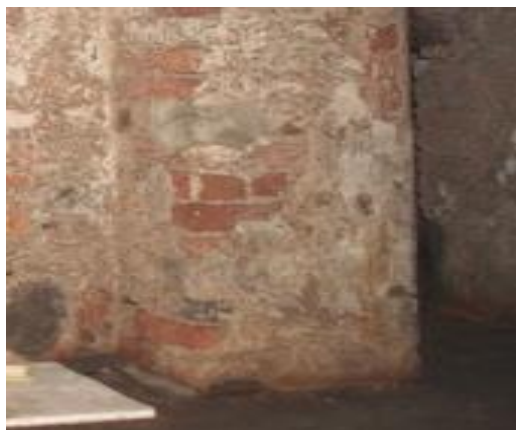
Zd.6.1. Piwnica. nr 01 część południowo -zachodnia.. Zawilgocenie oraz odpadający tynk ścian fundamentowych piwnic. Wilgotność powierzchniowa murów zewnętrznych w większości wykazuje na stan mokry powyżej 16 %.
