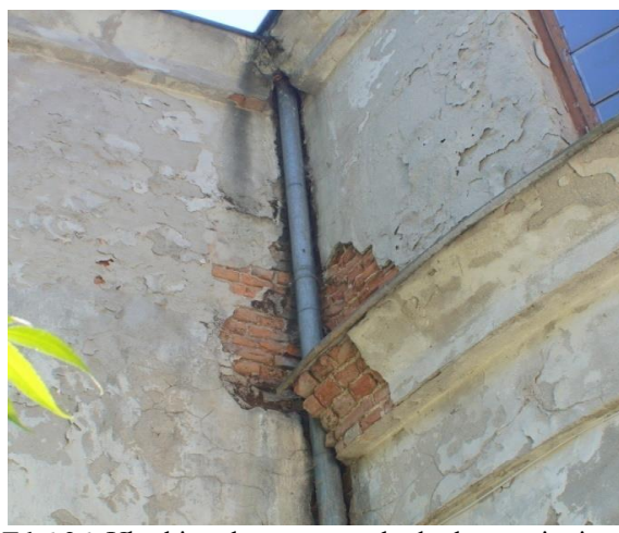
Zd. 6.26. Ubytki tynku w narożu budynku w rejonie gzymsu od strony wschodniej budynku.
