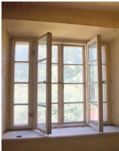
Zd. 9.17. Widok destrukcji okna poziom pierwszego piętra
