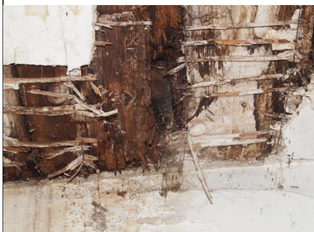
Zd. 9.9. Przykładowa destrukcja miejscowa stropu konstrukcji drewnianej nad pierwszym piętrzem pom. nr 2.16.
