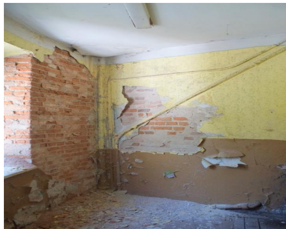
Zd.6.20. Poziom pierwszego piętra pom. nr 2,19 destrukcja z powodu korozji biologicznej spowodowanej wilgocią. Odształcenie stropu konstrukcji drewnianej w narożu pomieszczenia.
