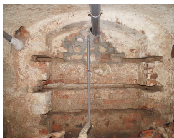
Zd.6.12. Strop kolebkowy z cegły ceramicznej pełnej. Destrukcja sklepienia ceglanego naświetla piwnicy.
