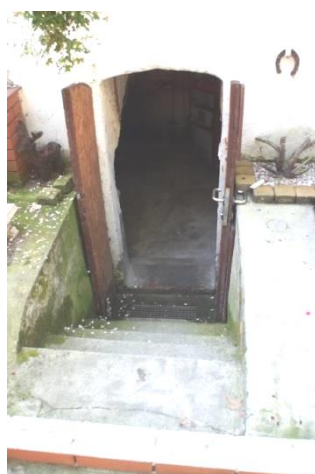
Zd.6.13. Schody do piwnicy nr 02. Przykład destruktacji spowodowanej wilgocią korytarza poziomego piwnic. Brak uporządkowania odpływu wód deszczowych z podwórca powoduje ich napływ w czasie nadmiernego zrzutu do pomieszczeń piwnicy.
