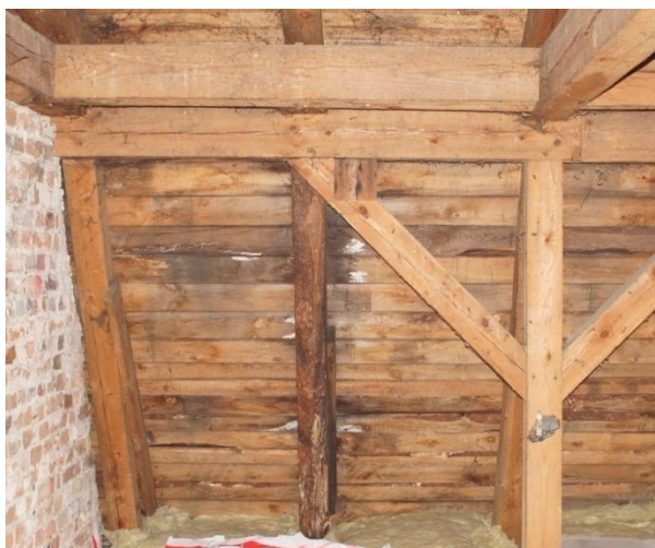
Zd.9.13. Więźba dachowa w osi 1-2. Miejscowa destrukcja w postaci wykwitów solnych na deskowaniu więźby dachowej. Przykład pozostawienia tzw. „świadka” w postaci części środkowej krokwi. Układ deskowania połaci dachu na styk ułożono niejednolicie niezachowując wymaganych wymiarów desek. Zastosowano deski nierówne nieobrzynane miejscami z pozostałościami po okorowaniu.
