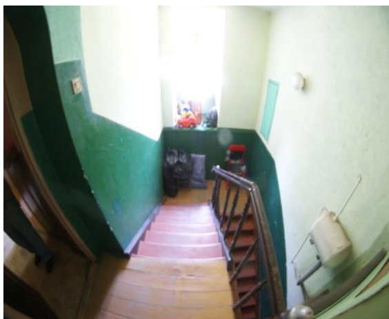
Zd.9.15. Klatka schodowa prowadząca na pierwsze piętro. Degradacja pomieszczenia poprzez amortyzację czasową konstrukcji drewnianej oraz wilgoć.
