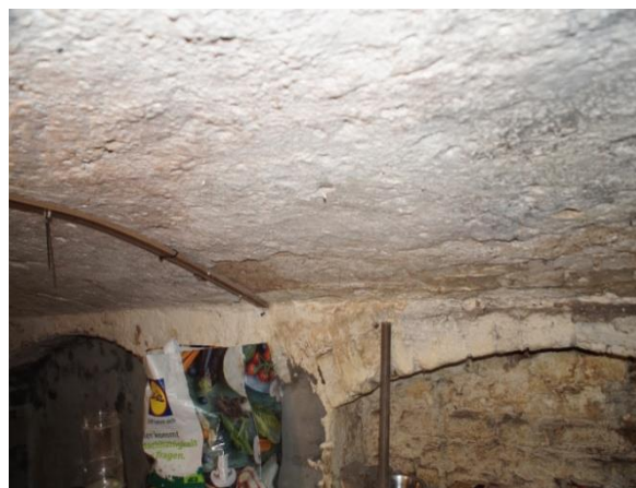
Zd.6.14. Destrukcja sklepienia kolebkowego z cegły ceramicznej pełnej przy wejściu do piwnicy nr 02.
