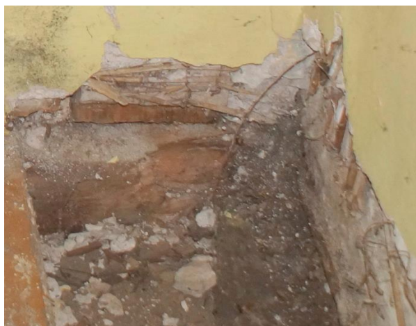
Zd.6.23. Miejscowy przykład destrukcji ściany działowej konstrukcji drewnianej przy styku ze stropem podłogi. Ubytki tynku wapiennego widoczna trzcina mocowana do belek drewnianych,
