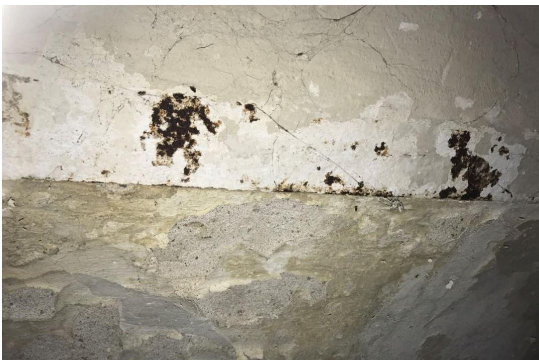
Fot. 7. Odcinkowy strop Kleina na belkach stalowych I NP 22. Odpadający tynk na belkach stalowych i duża wilgotność doprowadziły do znacznych ubytków korozyjnych
