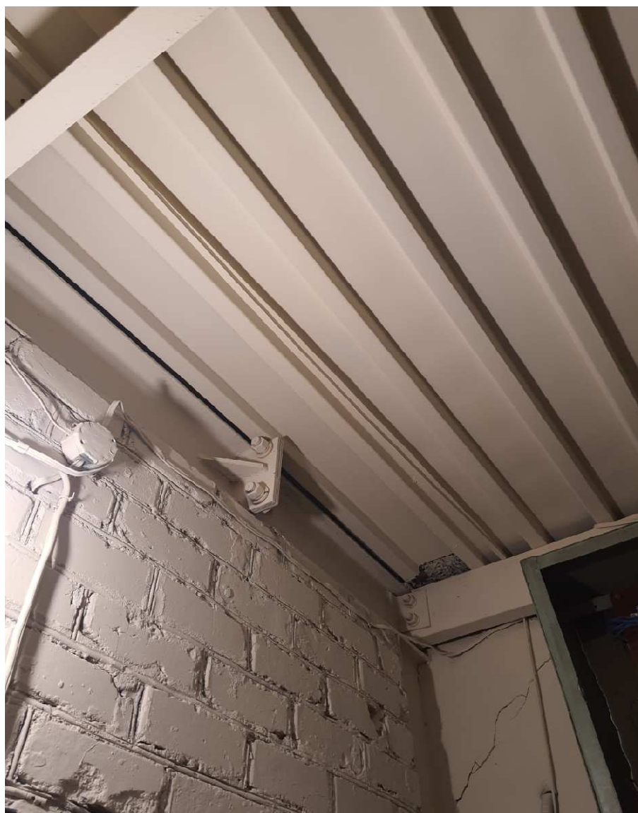
Fot. 4.1 Widok połączenie ramy głównej parteru oraz oparcie blachy trapezowej na płatwiach
