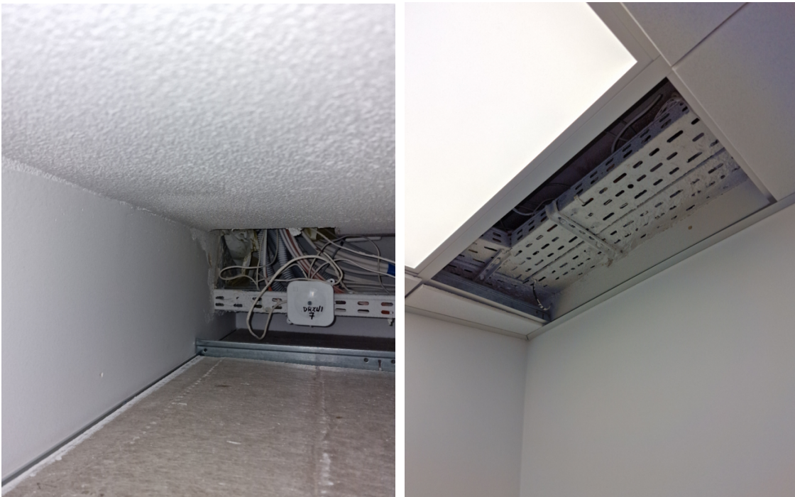
Zdjęcie nr 6. Przebieg kablowy w przestrzeni międzysufitowej na 2 piętrze w kierunku dachu. Okablowanie AC oraz DC poprowadzić możliwie najkrótszymi trasami. Wykorzystać szacht kablowy do zejścia kabla AC do serwerowni na parterze.
