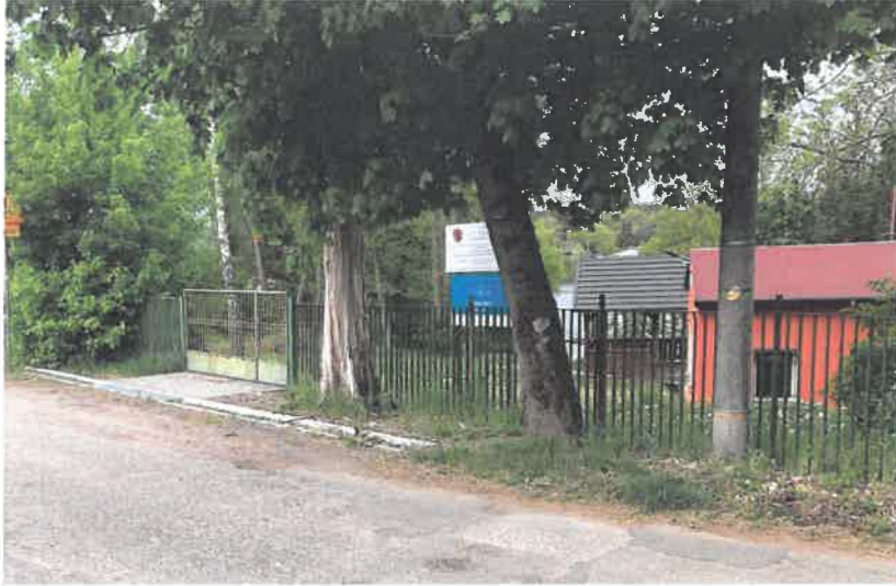
Zdjęcie 3 Ogrodzenie do oczyszczenia i malowania
